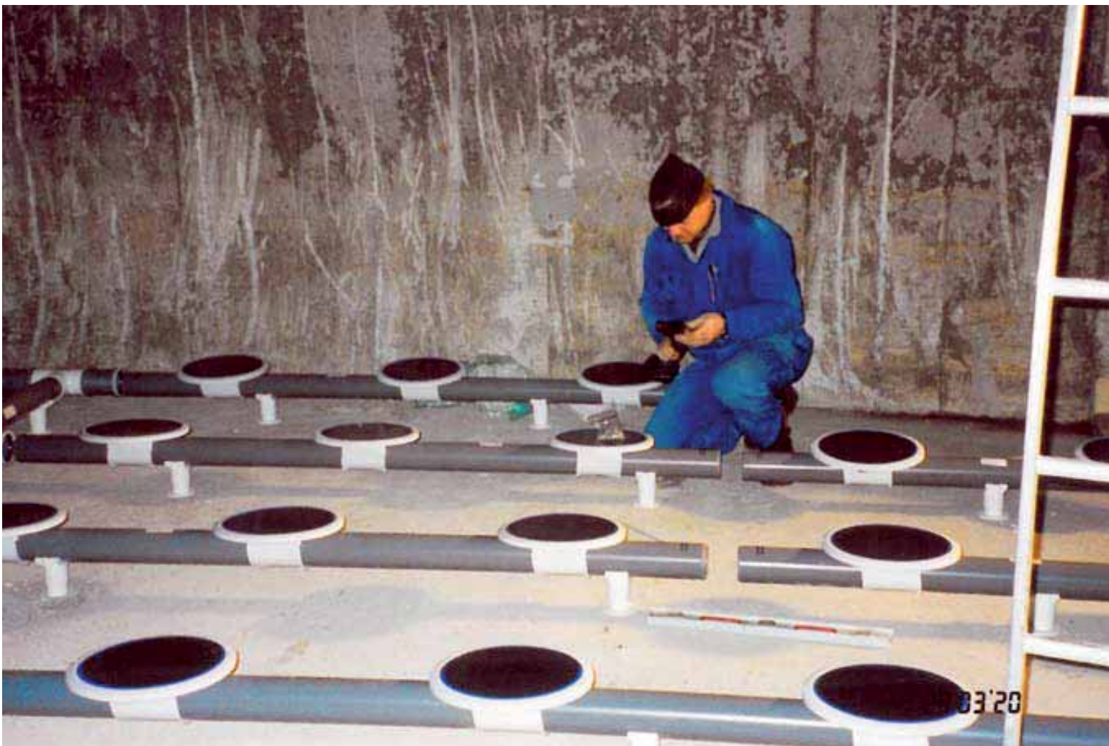
Puhdistamon ilmastimia lisättiin vuonna 2010. Ilmastimia oli tämän jälkeen yhteensä 695 kpl. (Ympäristölupapäätös 101/2010/1, kuva: vesilaitos)
