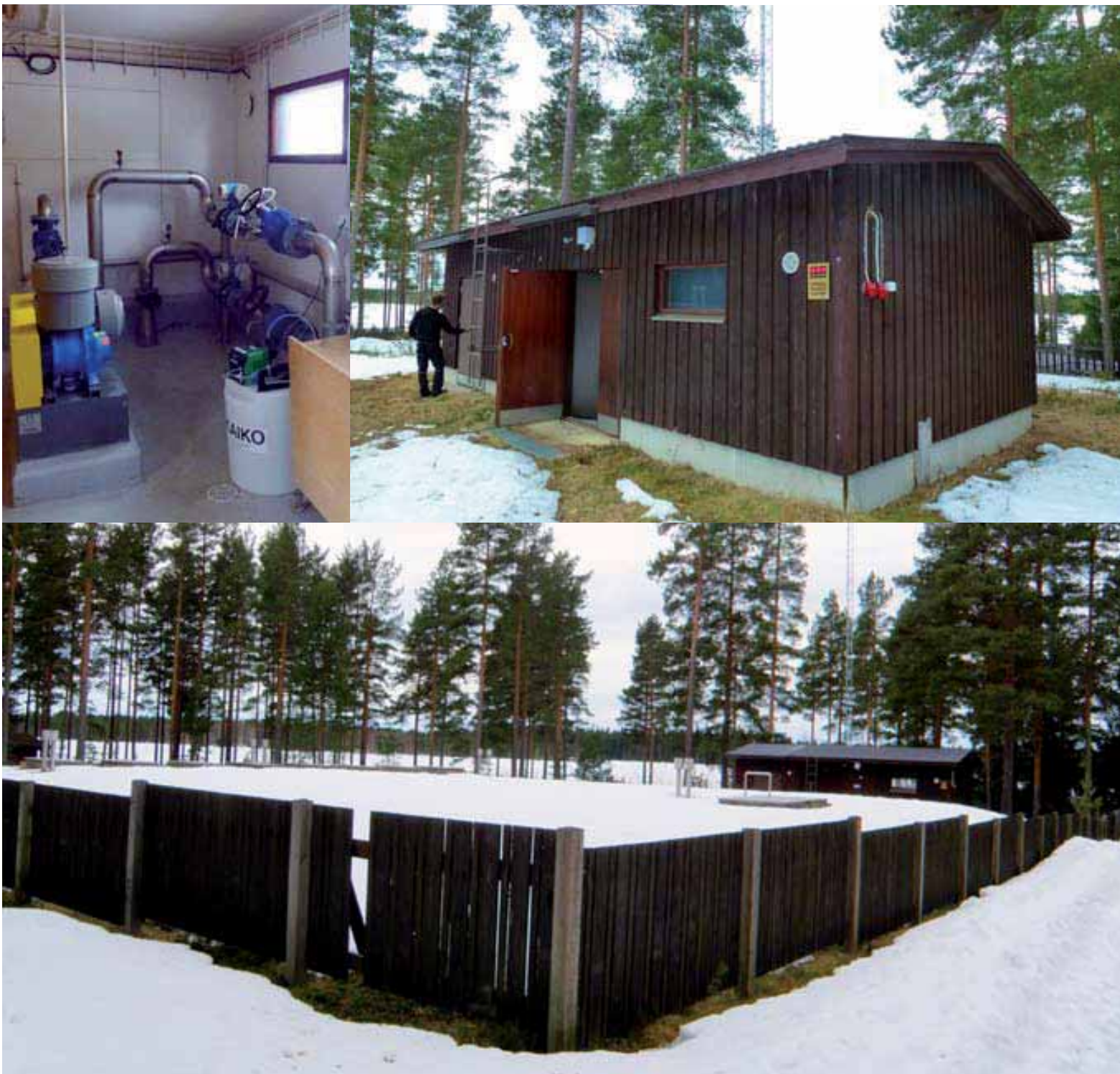
Säläisjärven vedenottamoalue on Säläisjärven rannassa. Ottamoon kuuluu kaksi siiviläputkikaivoa, mutta käytössä on vain kaivo 3, joka sijaitsee noin 250 metriä vedenottamoalueelta kaakkoon. Vedenotto vuonna 2008 oli yhteensä 239 614 m 3 eli noin 656 m 3 /d. Vesi käsitellään kalkkikivialkaloinnilla. (Hentilä 2012; kuvat: Rajala & Juuti 2012)
