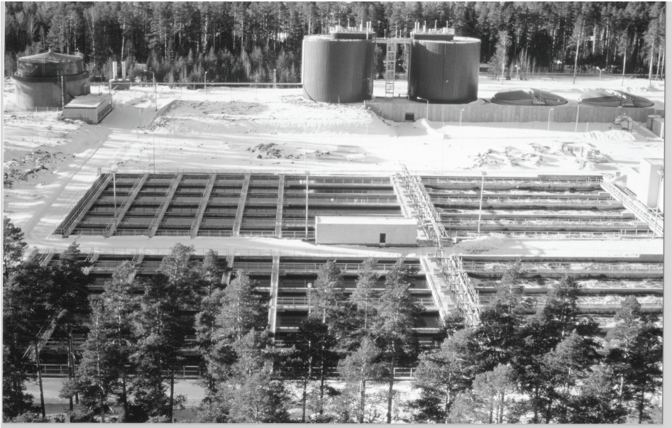
Kuva Suomenojan jätevedenpuhdistamolta ennen typenpoistolaitoksen rakentamista vuonna 1996. Taustalla mädättämöt ja vasemmassa reunassa kaasukello ja lämpökeskus. Oikeanpuoleisissa altaissa tapahtuu ilmastus ja vasemmanpuoleiset altaat ovat jälkiselkeytysaltaita. (Espoon Vesi)
