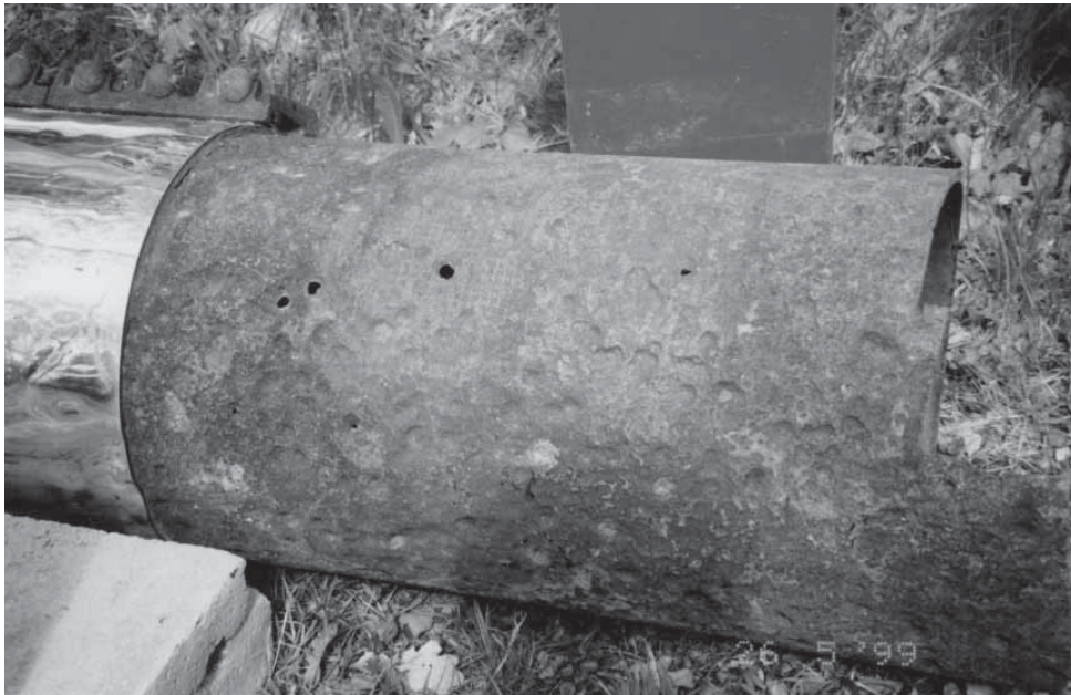
Kuva 9.7 SG-valurautainen vesijohto, joka on syöpynyt palveltuaan noin 15 vuotta. (Vantaan Vesi 1999)
