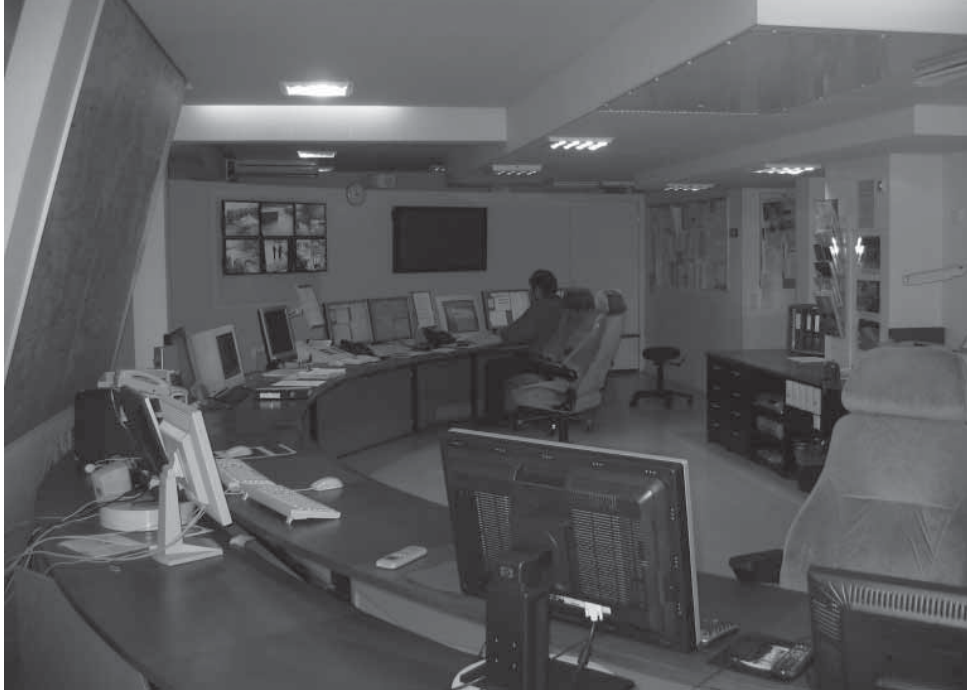
Kuva 6.19 Kuvassa Vanhankaupungin vedenkäsittelylaitoksen valvomo. (Rajala 2007)
