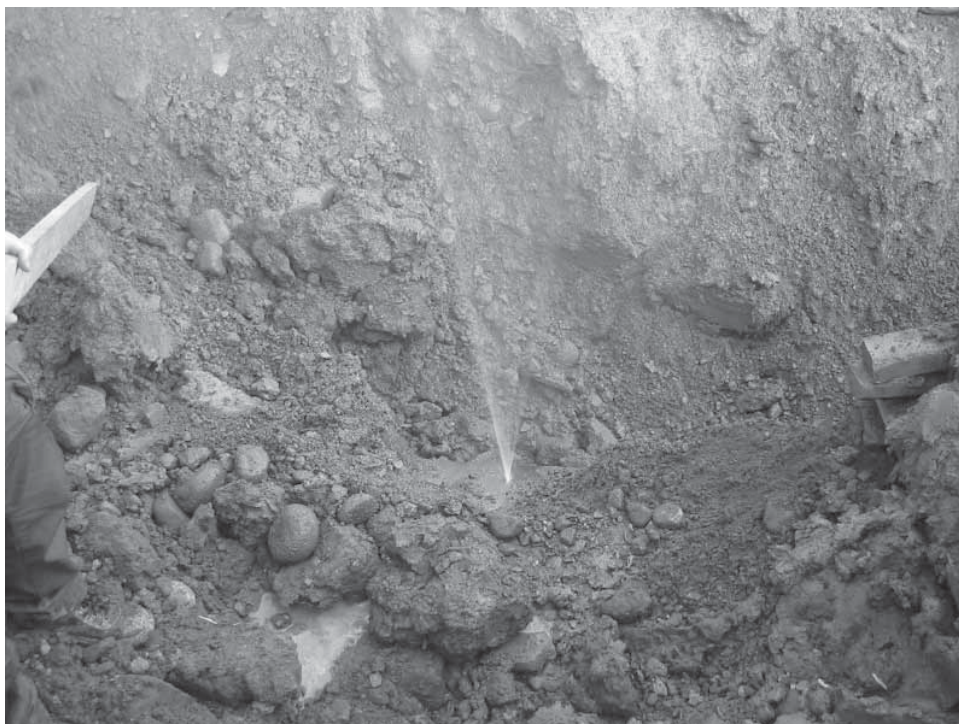
Kuva 9.11 Vesi suihkuaa vuotavasta putkesta. (Vantaan Vesi)
