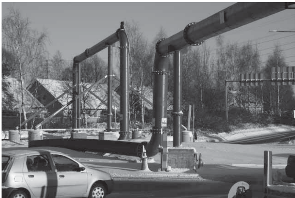
Kuva 7.18 Kuva Suutarilan saneerauksesta tammikuussa 2006. Maanpäälle rakennetut ohipumppauslinjat olivat poikkeuksellinen ratkaisu. (Vantaan Vesi 2006)
