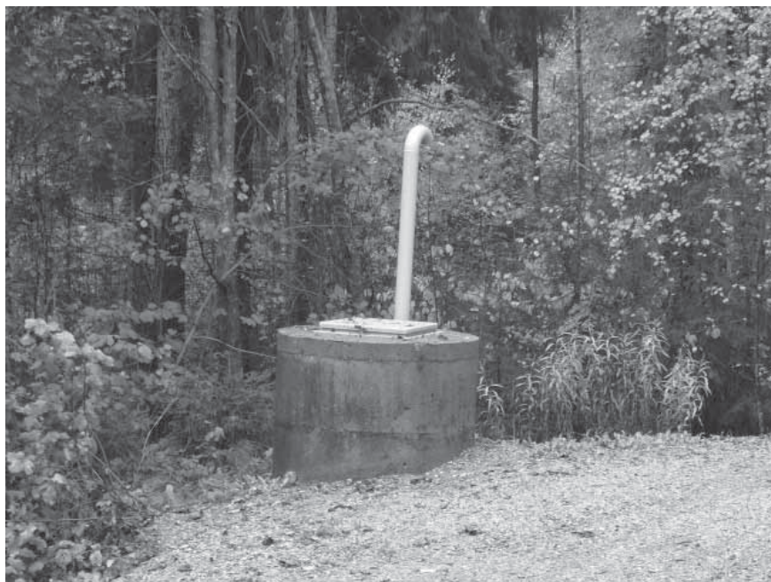
Kuva 6.6 Kuvassa Kuninkaanlähteen kaivo vuonna 2006. Kuninkaanlähteen pohja-vedenottamo valmistui Tuusulan kunnan puolelle vuonna 1965. (Juuti 2006)
