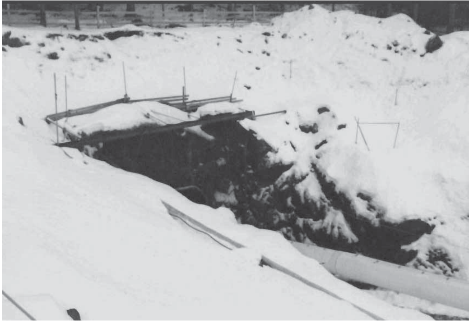
Kuva 6.2 Päijännetunnelin sortumatyömaa alkutalvesta 1999 (Tuusulan seudun vesilaitos kuntayhtymä).
