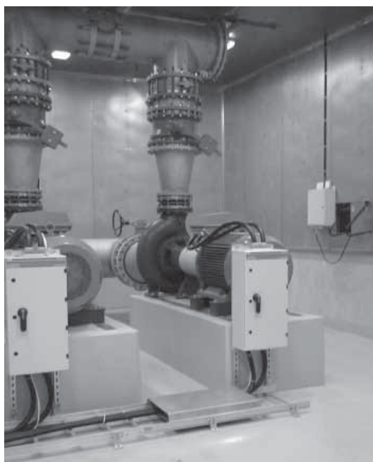
Kuvat 9.15a ja b Pitkät vesijohdot vaativat paineen ylläpitämiseen pumppausta. Kuvassa Ala-Tikkurilan paineenkorotusasema ja pumput. (Juuti 2006)
