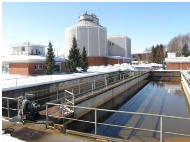
Paroisten jätevedenpuhdistamo maaliskuussa 2010. Vasemmalla valvomo, jonka takana mädättämö. Etualalla rejektivesien erilliskäsittelyn altaat. (Juuti & Rajala)
