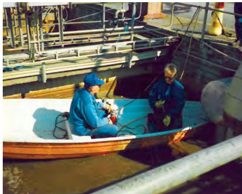
Palautuslietteen syöttöputken asennuksessa käytettiin apuna venettä vuonna 1995. Vasemmalla istuu Pentti Saha ja vieressä Olavi Sikiö. (HS-Vesi)
