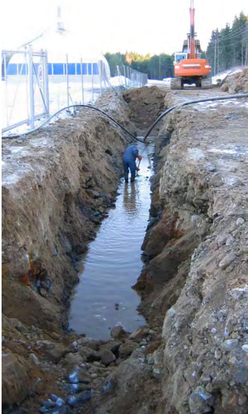
Toimiva vesihuolto vaatii ammattitaitoa ja työtä pelkäämätöntä otetta. Kuvassa yläpuolella ollaan haasteellisten olosuhteiden parissa kaivannossa joulukuussa 2003. (HS-Vesi).
