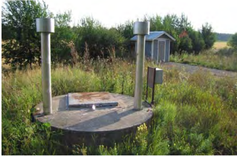
Kalvolassa sijaitseva Kankaisten kaivoalue. Kuvan kaivoista vesi johdetaan Sepänkaarten pohjavesilaitokselle. (HS-Vesi 2006) Kalvolaan Kankaisiin rakennettiin ensimmäinen maanalainen siviiläputkikaivo vuonna 1965. 275
