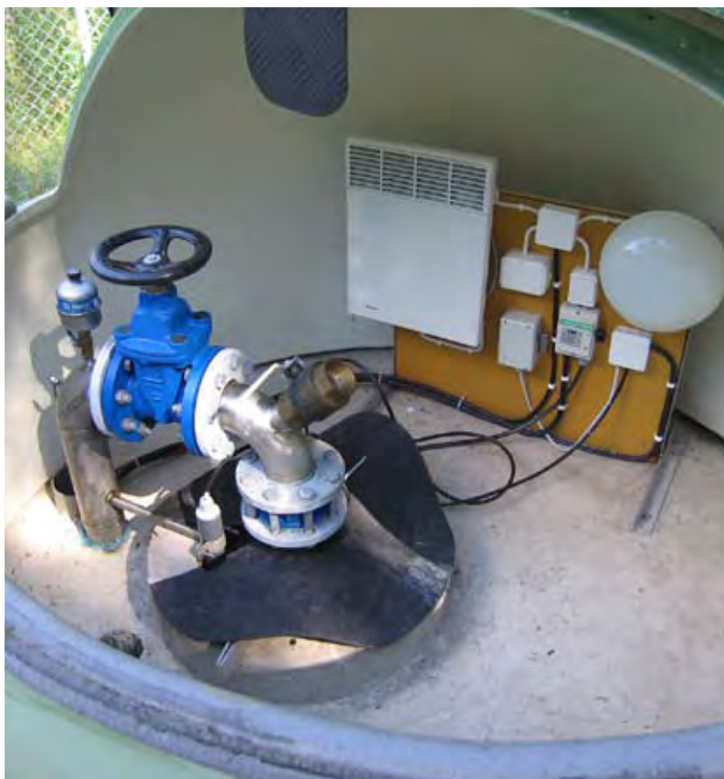
Kuva Hakonnummen pohjavedenottamolta. Pyöreä, vihreä kaivonkansi kätkee sisäänsä kuvassa näkyvät osat. (HS-Vesi 2006)
