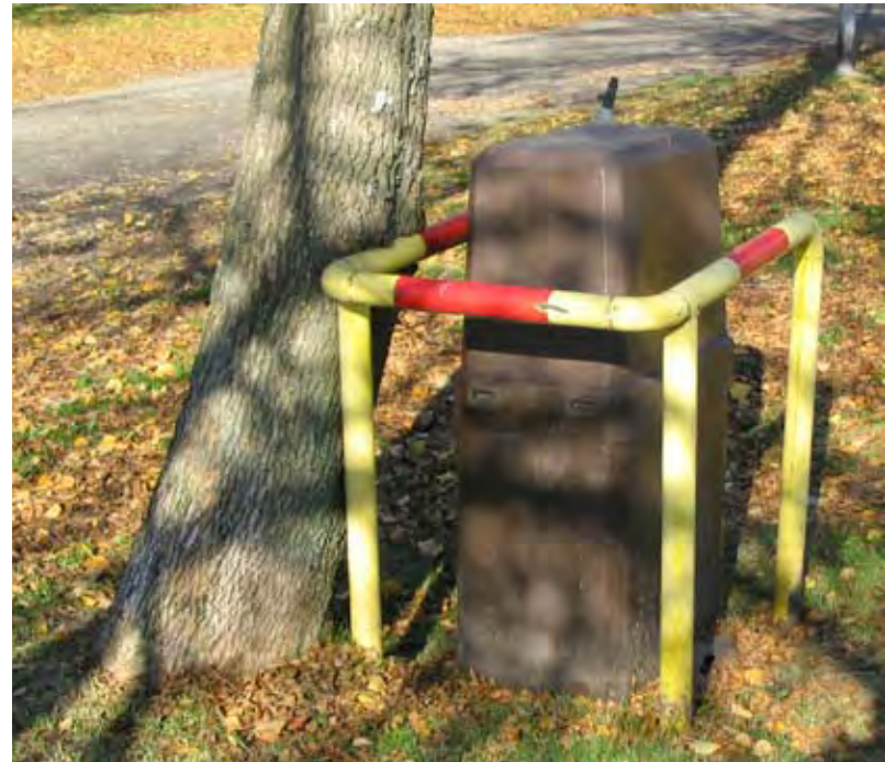
Paloposti on suojattu tässä puun hyökkäykseltä. (HS-Vesi)
