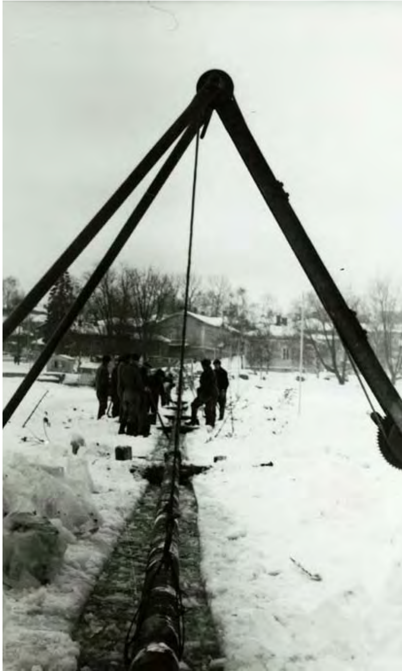
Birgel Jaarlinkadun päässä lasketaan 150 mm Mannesman vesi-johtoputkea "Mensanrantaan" talvella 1946. Putki ripustettiin kolmijalkojen varaan, jolloin lasku onnistui tasaisesti. Kolmijalkoja
