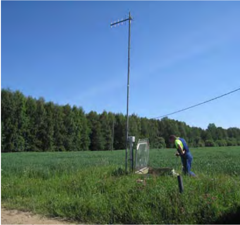
Teuron paineenkorotusasema Tuuloksessa. (HS-Vesi 2006)
