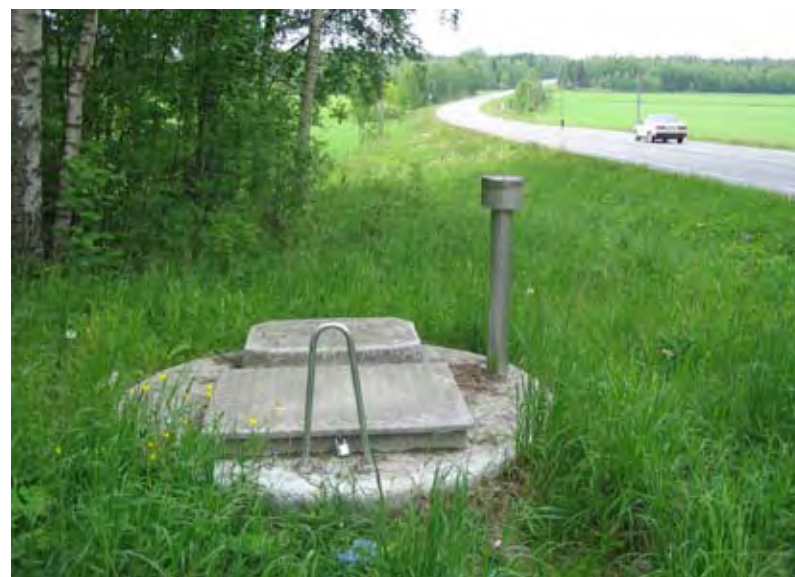
Kankainen Parkku, puhtaan veden painekorotusasema. (HS-Vesi)
