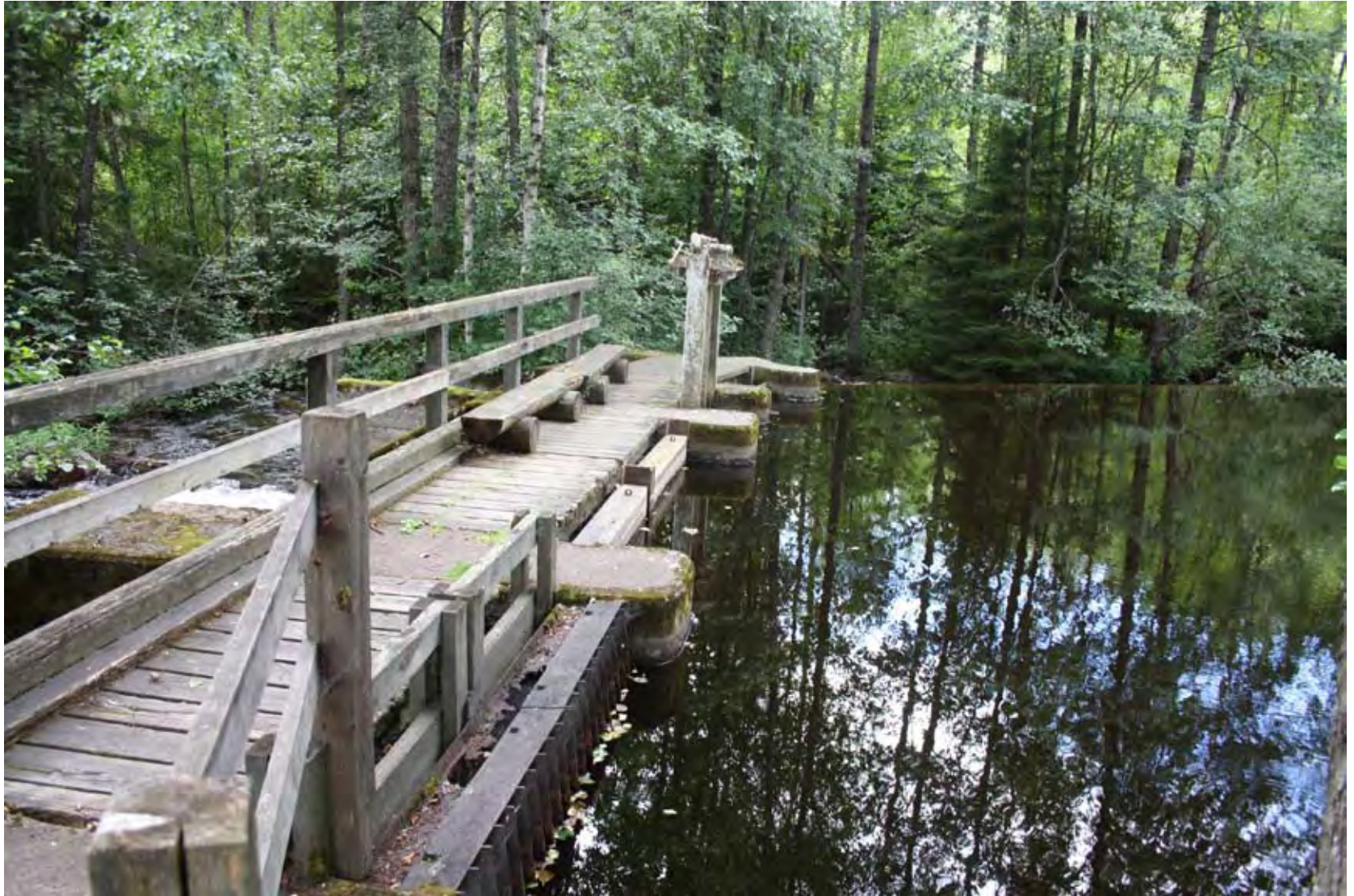
HS-Vesi säännöstelee Alajärven vedenpintaa osana tekopohjaveden ottamiseen liittyviä velvoitteita. Kuvassa Katiskosken hyväkuntoinen luukkupato. (HS-Vesi)
