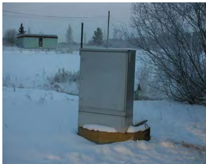
Paroistentien jätevesipumppaamo on rakennettu vuonna 1984. (HS-Vesi)
