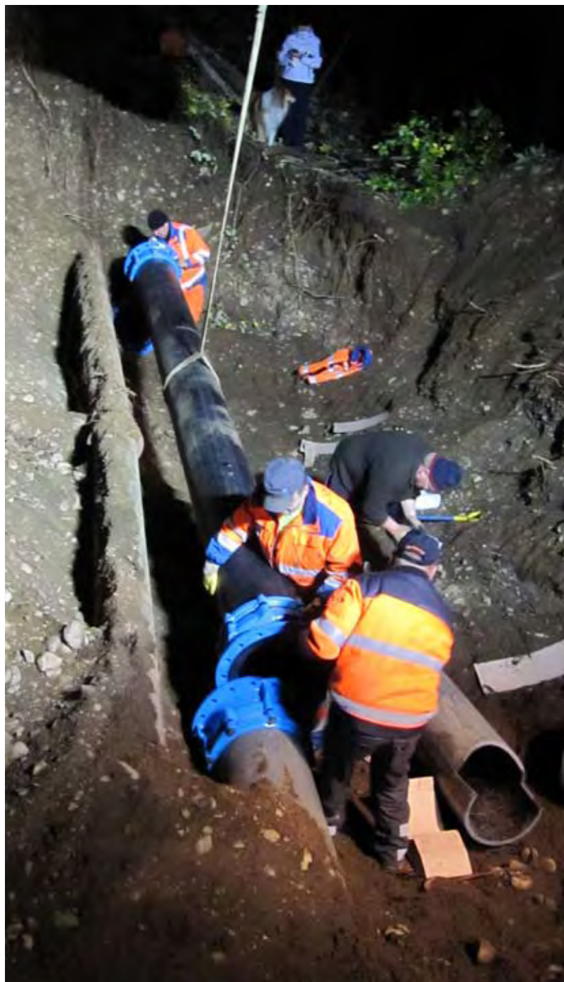
Ahveniston raakavesilinjan huoltoa lokakuussa 2009. Töitä paiskittiin yötä myöten, jotta vesikatkoista ei syntyisi. (HS-Vesi)
