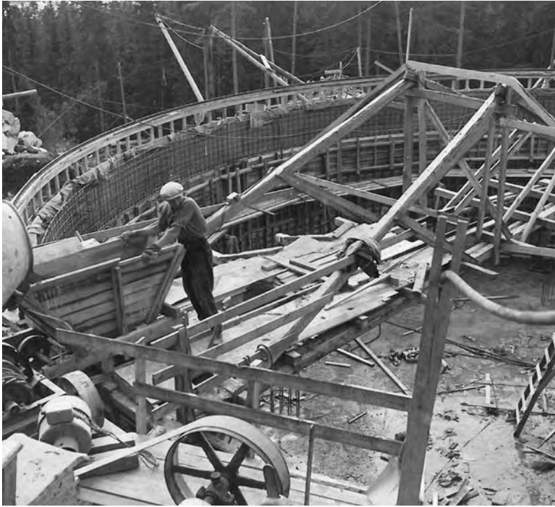
Sairion 2000 kuutiometrin vesiäiliö rakennettiin vuonna 1954. Säiliön viereen varattiin tila myös toiselle yhtä suurelle säiliölle, mutta sitä ei koskaan rakennettu ja laajennusta varten varattu kuoppa peitettiin vuonna 1985. (HS-Vesi)
