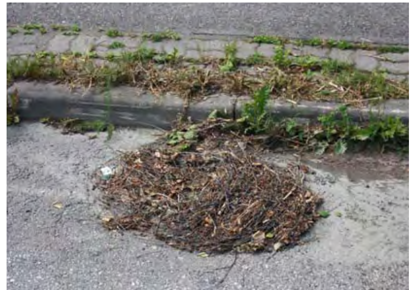
Hulevesien hallinta vaatii myös resursseja ja huomiota. Kuvassa tukkeutunut ritiläkaivo. (HS-Vesi)
