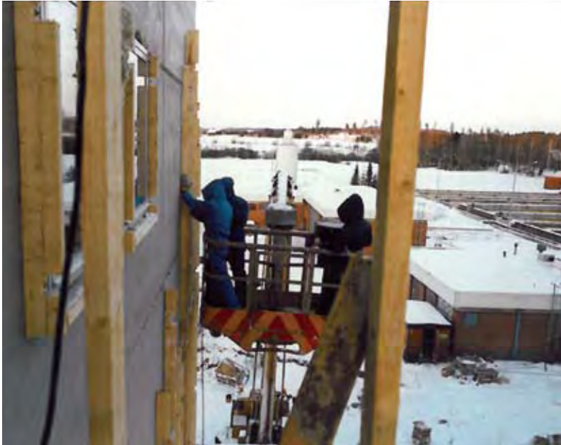
Mädättämö rakennettiin vuonna 1987. (HS-Vesi)
