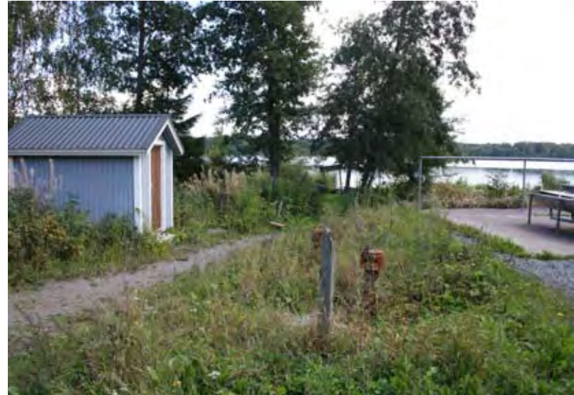
Solvikin jätevedenpumppaamo on rakennettu vuonna 1977 ja saneerattu vuonna 2004. (HS-Vesi)
