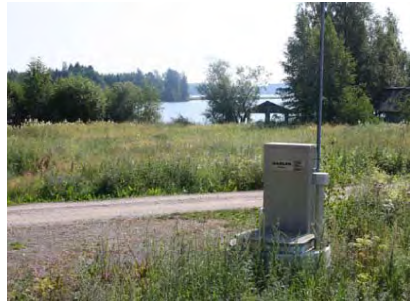
Vesihuolto näkyy maisemakuvassa. Etuoikealla Alvettulan jätevedenpumppaamo Hauholla 2010. (HS-Vesi)
