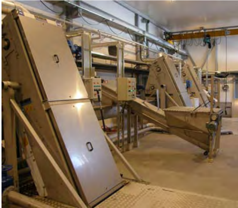
Ensimmäiseksi puhdistamolle saapuva jätevesi välpätään eli kuvan levynauhavälillä roskat erotellaan jätevedestä. (Juuti & Rajala 2010)
