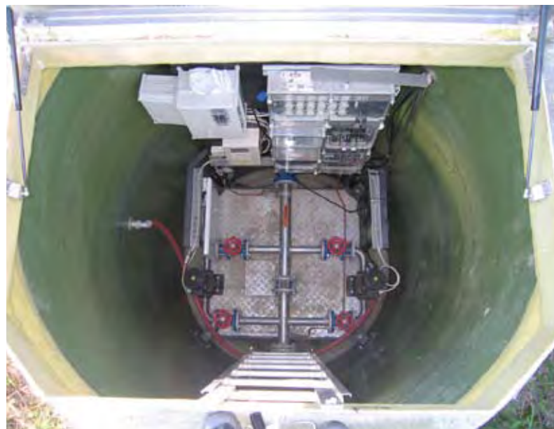
Hukarin paineenkorotusasema Kalvolassa. Paineenkorotusasemia tarvitaan pitkille verkostoetäisyyksille tai muuten esimerkiksi korkeuserojen takia vaativaan maaston. Yläkuvan taustarakennus on jätevedenpumppaamo. (HS-Vesi 2006)
