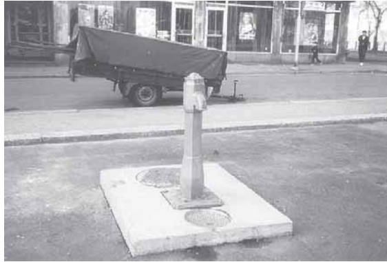
Kuva 86: Vesiposti Tampereelta, vesilaitoksen verkostossa. Fig.86:Hydrant,Tampere. Connected to waterworks. ©T.Katko
