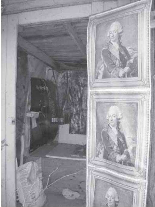
Kuva 35: "Kuninkaallinen" käymälä. Koristeellinen, mutta romahtamispisteessä. Kangasala. Fig. 35: "Royal" outhouse, but in such a bad shape that it can collapse any minute. Kangasala. [D III]
