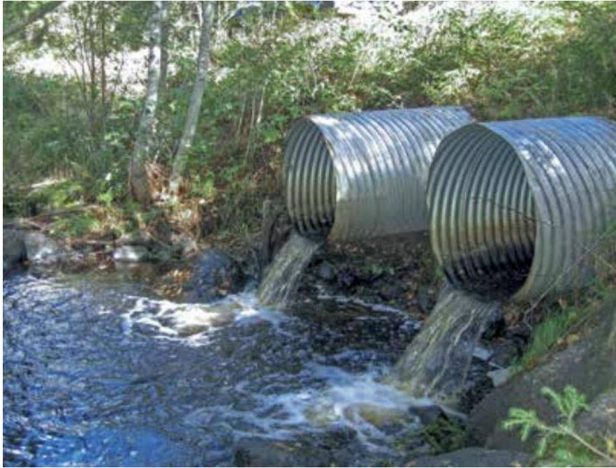
Kuva 2. Ylitysrakenteena toimiva teräsrumpurakenne, jossa rumpujen alapään pudotus vedenpinnan tasoon nähden on liian suuri kalojen kulun kannalta (A. J. Eloranta & Eloranta, 2016)
