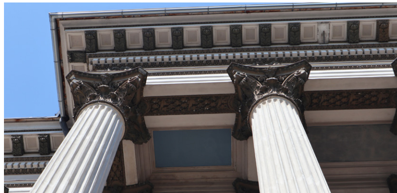
Kansallisarkiston nykyinen väritys on peräisin vuoden 1981 kunnostuksesta Ylemmässä kuvassa pohjoisen julkisivulla pilasterien väritys on yläosista säilynyt tummempuna. Kuva: Aamu Koivistoinen, 2023.
