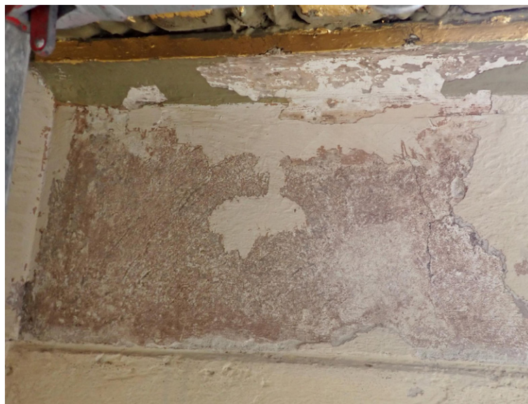
Peristyylin seinäpinnan alimman kerroksen esiinotto. Kuva lainattu raportista Säätytalon julkisivujen väritystutkimuksesta, Sippo- nen, 2023.
