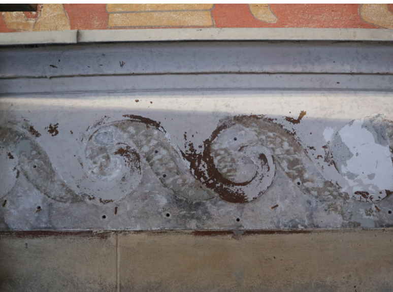
Juokseva koira - kipsikoristelistan kohokuvion alta löytyi listoituksen alkuperäisiä pintakäsittelyitä ja imitoinnin suonistuksia. Kuva: Aamu Koivistoinen, 2024.
