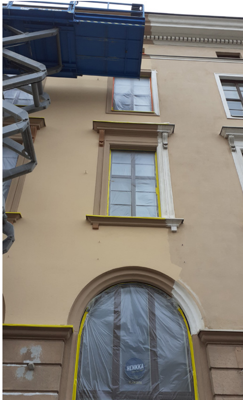
Tampereen teletalo/vanha postitalo (rakennusvuosi 1927) on suojeluasetuksella 480/85. Julkisivumaalauksen yhteydessä vanha kalkki-maalipinta peitettiin telauksen alle. En selvittänyt työtä aikana sitä, mihin uusi väriytyy pohjautuu. Kuva: Aamu Koivistoinen, 2022.
