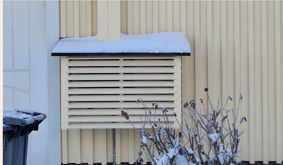
Kuva 65 Koteloitu ja peittomaalattu ilmalämpöpumppu julkisivussa
