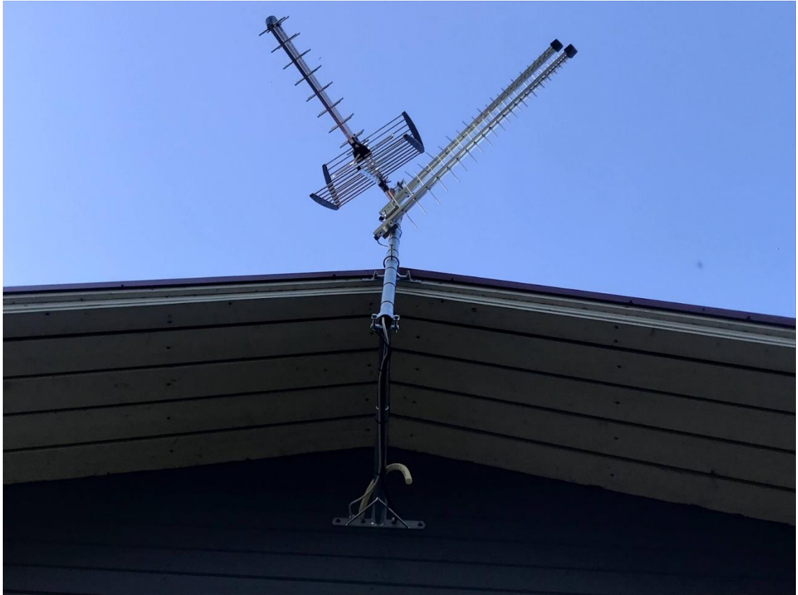
Kuva 4. Antennimastoon asennettu ja suunnattu verkkoantenni (Iskra P-58) oikealla. Vasemmalla tv-antenni.
