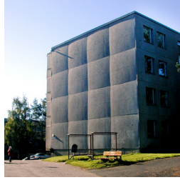
Kuva 73: Pitkälle edenneen pakkasrapautumisen aiheuttamaa elementtikeruorien kaa-reutumista.
