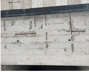
Kuva 72: Pinnassa olevien raudoiteiden korrosiovaurioita.
