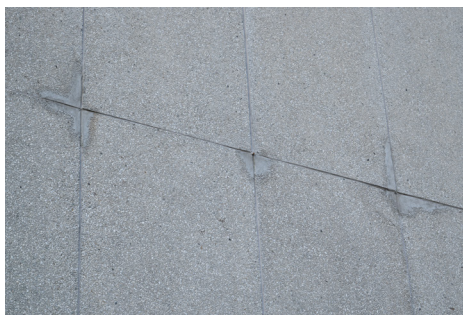
Kuvat 94 ja 95: Pesubetonijulkisivun paikalliskorjauksia vakiotuotteilla. Näennäisen karkean pinnan laadukas paikalliskorjaaminen vaatii yllättävää hienovaraisuutta.
