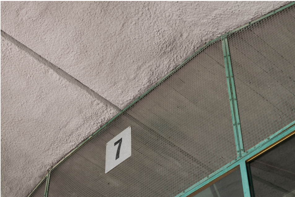
Kuva 102: Harkitsemattomat ruiskubetonoinnit ja ylitasoitukset toistavat muodon huonosti ja peittävät olennaisia, alkujaan harkittuja pintatekstuureja.
