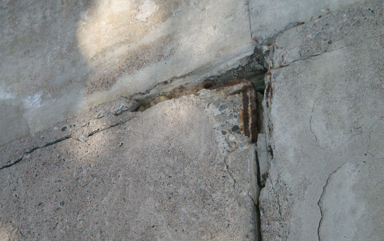
Kuva 67: Pitkälle edennyttä betonijulkisivun vaurioitumista Roihuvuoren koulun julkisivulla ennen laajaa korjaushanketta.
