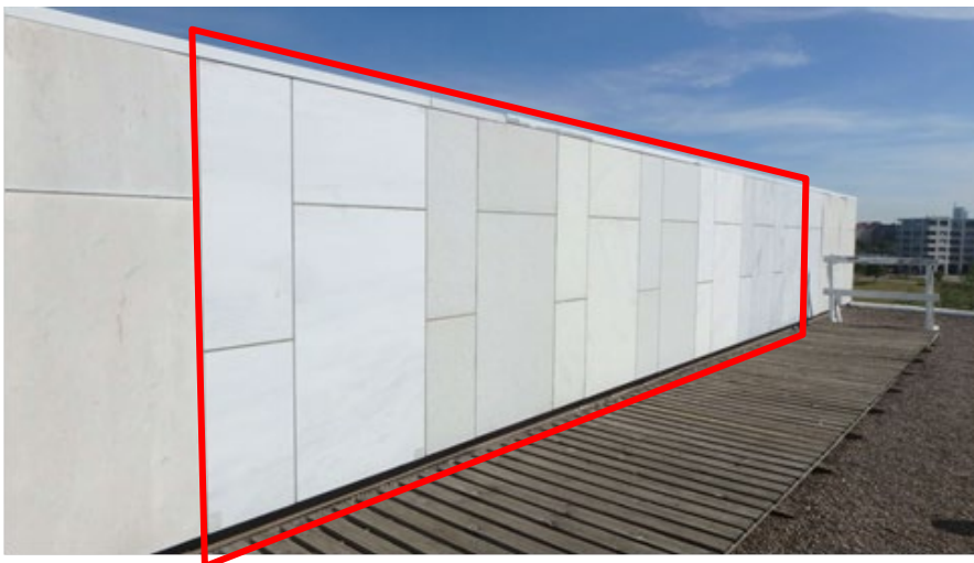
Kuva 1. Finlandia-talon katolle asennettu koeseinä, johon tutkittavat materiaaliveitohdot on asennettu.
