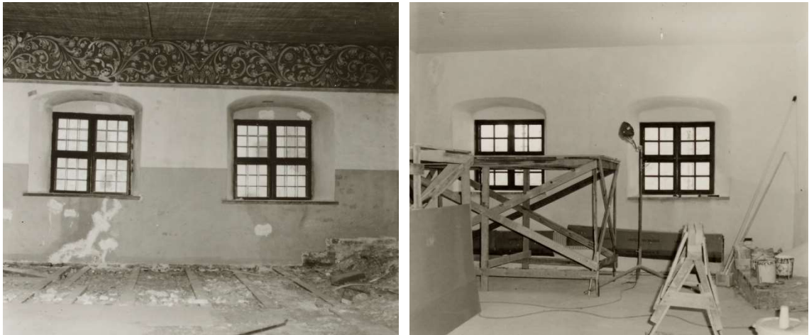
Kuva 12: Vasemmalla Brahen sali ennen korjausta (Ilmo Kajala 1979). Oikealla uusitut rappauspinnat ennen maalausten tekoa (Ilmo Kajala 1983).
