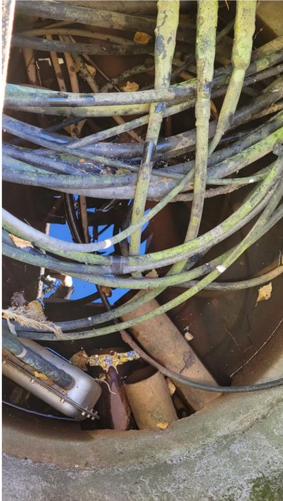
Kuva 50. Vettä ratapihan turvalaitekaapelikaivossa. (Sweco 2023)
