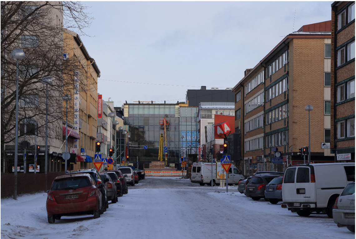
Kuva 3. Kuvaparissa avautuu näkymä Isokadulta kohti nyt katettua kadun osaa 2015 toukokuussa (yllä) ja 2016 tammikuussa. Kuva on otettu eteläpuolelta rakentuvaa kauppakeskusta.
