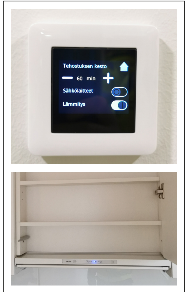
Kuva 35: Ilmanvaihdon asuntokohtaista tehostusta voidaan ohjata ohjauspaneelista tai liesituulettimesta. Kuva: Aki Kortetmäki.
