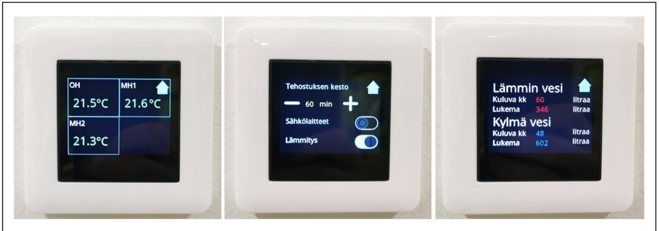
Kuva 40: Asunnon ohjauspaneelista voidaan ohjata ja monitoroida esimerkiksi tilojen lämmitystä, ilmanvaihdon tehostusta ja vedenkulutusta. Asuntojen yhdistämiseen tai erottamiseen varauduttaessa tulisi miettiä mahdollisuuksia näiden ohjauksien integrointiin. Alan toimijoiden haastattelujen perusteella näin ei ainakaan toistaiseksi toimita. Kuva: Aki Kortetmäki.
