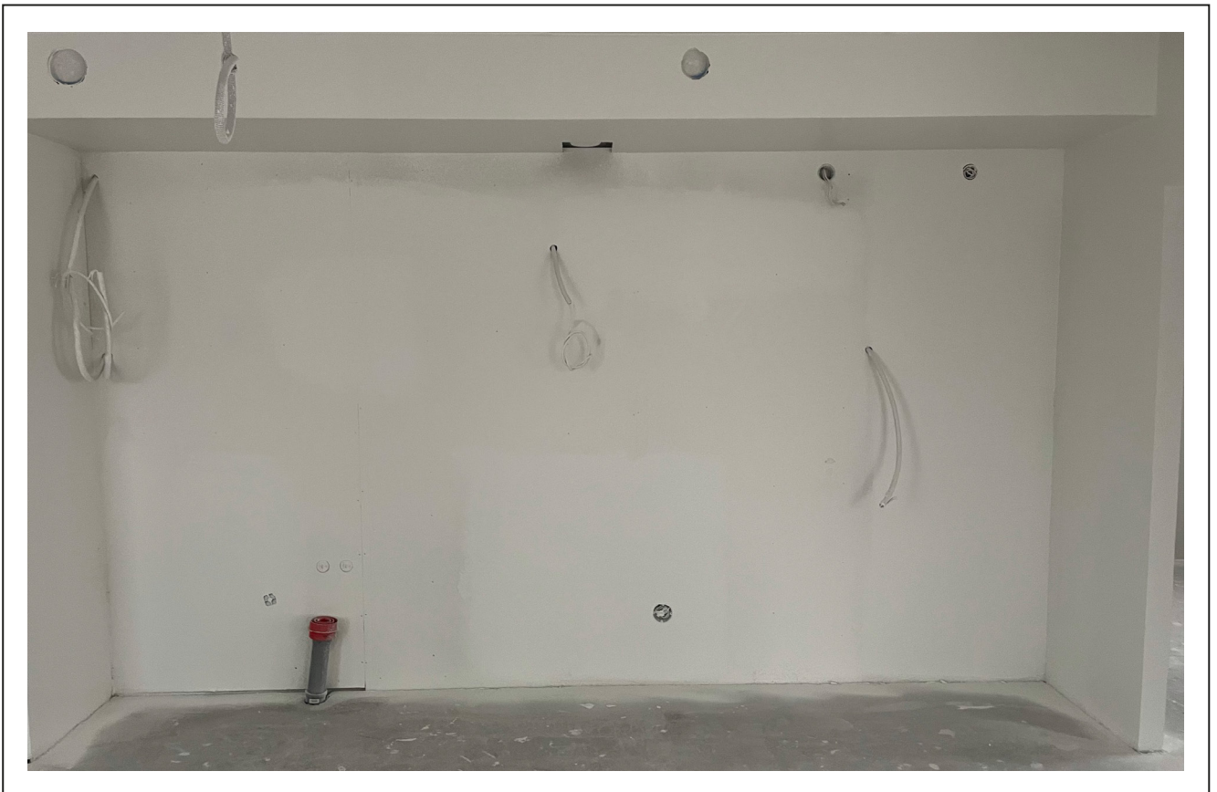
Kuva 38: Esimerkki keittiön vaatimasta talotekniikasta Bonavan kerrostalotyömaalta. Jos asunnot yhdistetään, toisen keittiön tekniikat voidaan jättää varauksiksi päättämällä ne turvallisesti rakenteisiin. Kuva: Bonava.
