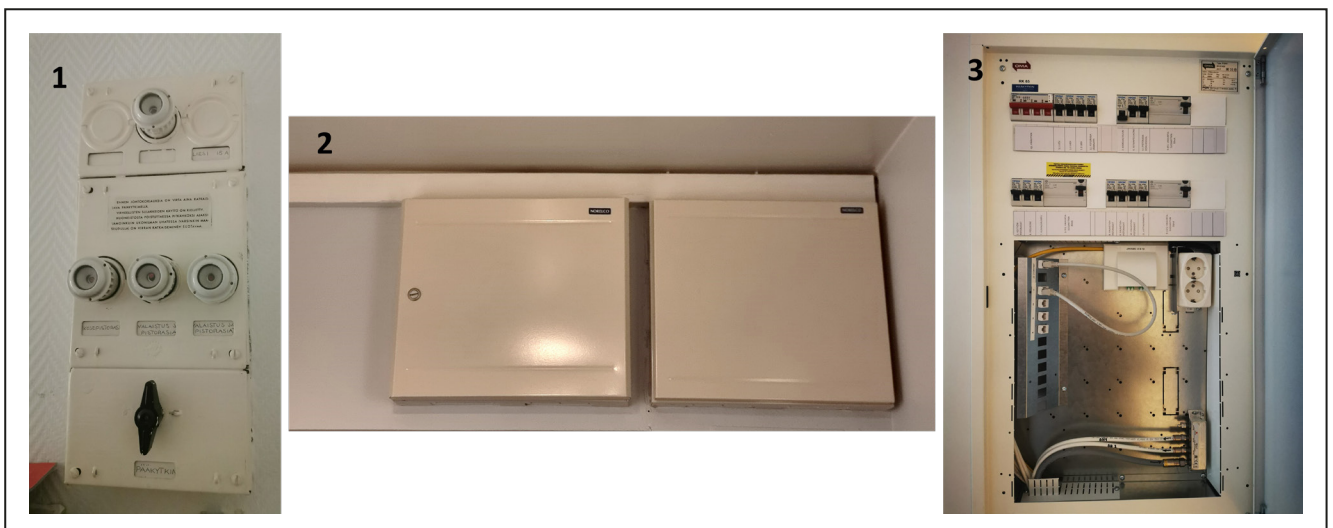
Kuva 3: 1960-luvulla rakennetussa alkuperäisessä ryhmäkeskuksessa (1) on ainoastaan neljä tulppasulaketta, jotka suojaavat kaikkia asunnon sähkönsyöttöjä. Keskellä (2) on LVIS-saneerauksen yhteydessä uusittu ryhmäkeskus ja erillinen IT-keskus. Keskukset ovat pinta-asennettuja. Alkuperäiset, seinä- ja kattorakenteissa kulkevat johdotukset tulevat keskuksen takaa. Uudet ryhmäjohdot taas kulkevat keskuksen yläpuolella olevaa asennuskourua pitkin. Oikealla (3) on uusi ryhmäkeskus, jonka alapuolella on myös erillinen IT-osio. Kuvassa näkyvät myös keskuksessa olevat johdonsuojakatkaisijat ja vikavirtasuojat. Kuva: Aki Kortetmäki.
