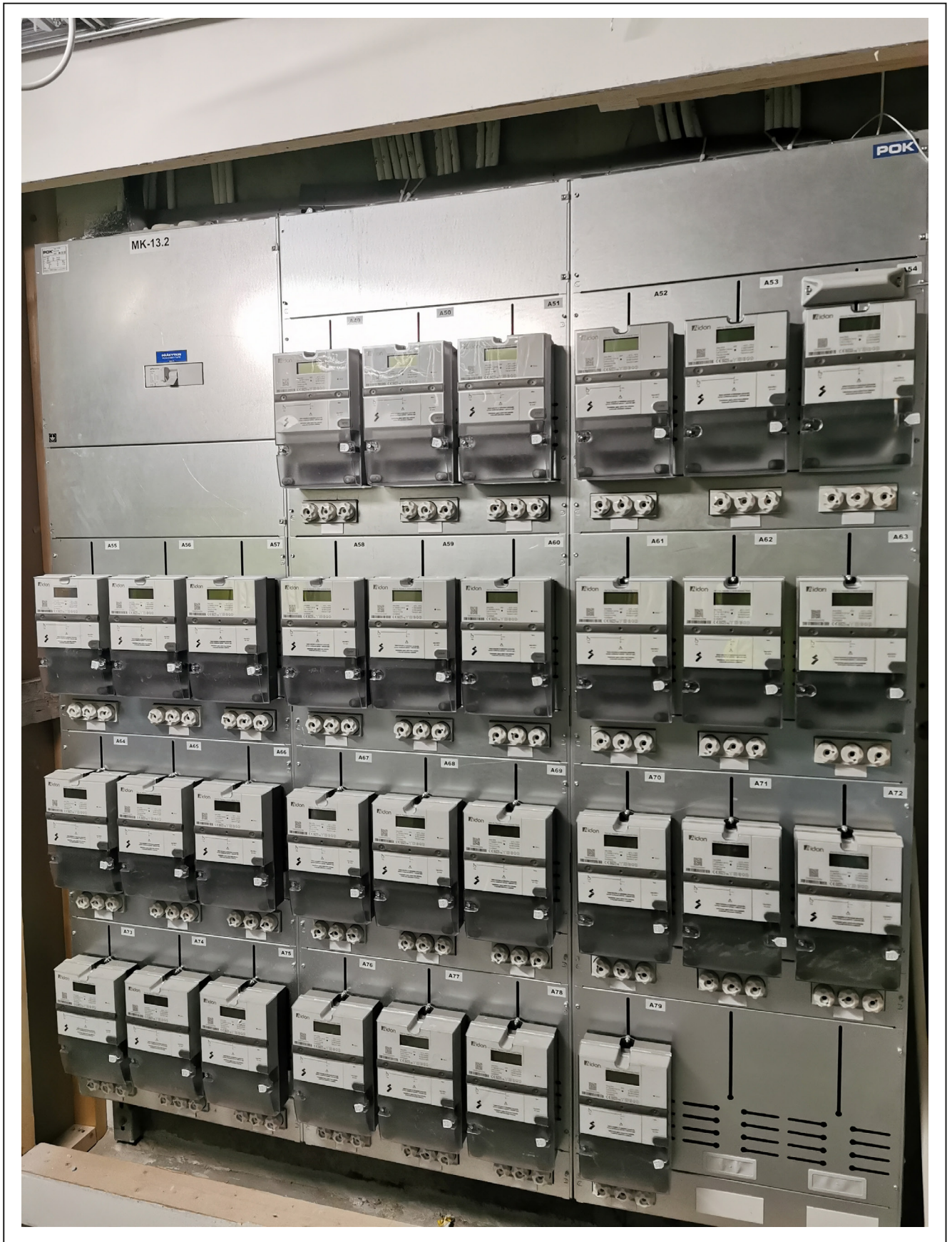
Kuva 36: Kerrostalokiinteistöissä jokaisen asunnon sähkönkäyttöä mitataan yleensä omalla verkkoyhtiön energiamittarilla. Mittausjärjestelyt tulee huomioida asuntojen yhdistämistä suunniteltaessa. Kuva: Aki Kortetmäki.
