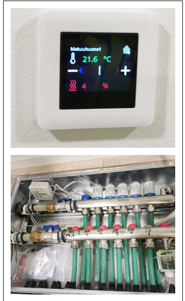
Kuva 33: Ylempänä tilojen lämmityksen hallintänäköymä ohjauspaneelissa. Alempana lämmityksen jakotukki, jonka avulla eri lämmityspiirien virtaamaa ohjataan. Kuva: Aki Kortetmäki.
