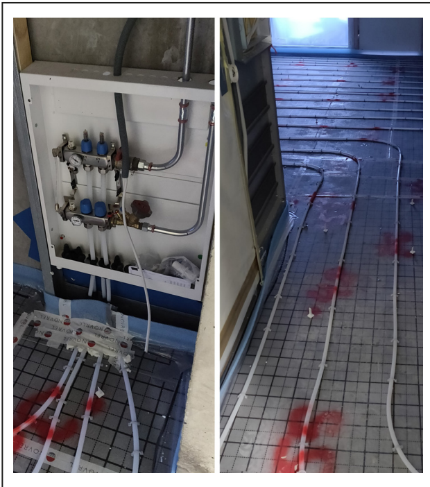
Kuva 21: Vasemmalla on lattialämmityspiirien jakotukki, jonka venttiileillä tilojen lämmitystä hallitaan termostaattien ohjaamana. Oikealla on yhden huonetilan yhtenäinen lattialämmityspiiri. Jos tämä tila jaettaisiin väliseinällä, lämpötilaa mittaava ja ohjauksesta vastaava termostaatti jäisi toiseen tilaan. Tällöin lämpötilaa voisi hallita ainoastaan toisesta tilasta ja ohjaus perustuisi siitä tilasta mitattuun lämpötilaan. Huonelämpötilan säätö ei tällöin välttämättä toimisi optimaalisella tavalla. Kuva: Aki Kortetmäki.
