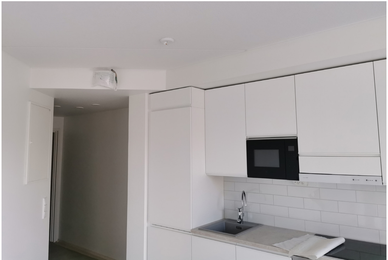
Kuva 30: Tämän kohteen välipohjissa on käytetty ontelolaattarakennetta, jonka tunnistaa katossa olevasta elementtisaumasta valaisinpistorasian vieressä. Jääkapin vieressä näkyy tekniikkakuilu, jota pitkin talotekniikka on tuotu asuntoon eteisen alaslaskettua kattoa hyödyntäen. Kuva: Aki Kortetmäki.
