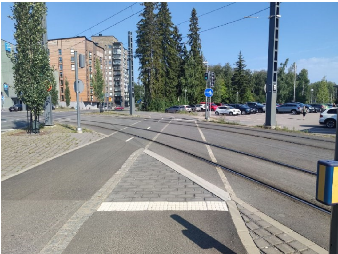
Kuva 46. Ylityspaikalla kiskon kulma väylään nähden on pyöräilyn kannalta huono. Myös visuaalisesti raitiotieylitys voisi olla paremmin huomattavissa.
