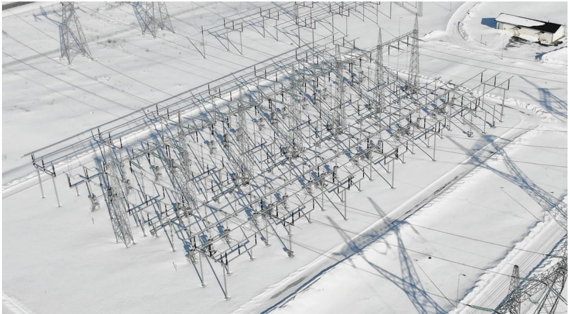
Kuva 24. Alajärven sähköaseman 400 kV:n ilmaeristeinen avokytkinlaitos [27].
