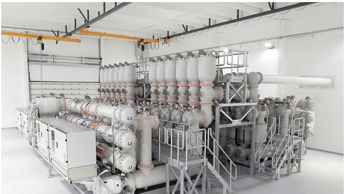
Kuva 29. Länsisalmen sähköaseman 400 kV:n kaasueristeinen sisäkytkinlaitos [30].
