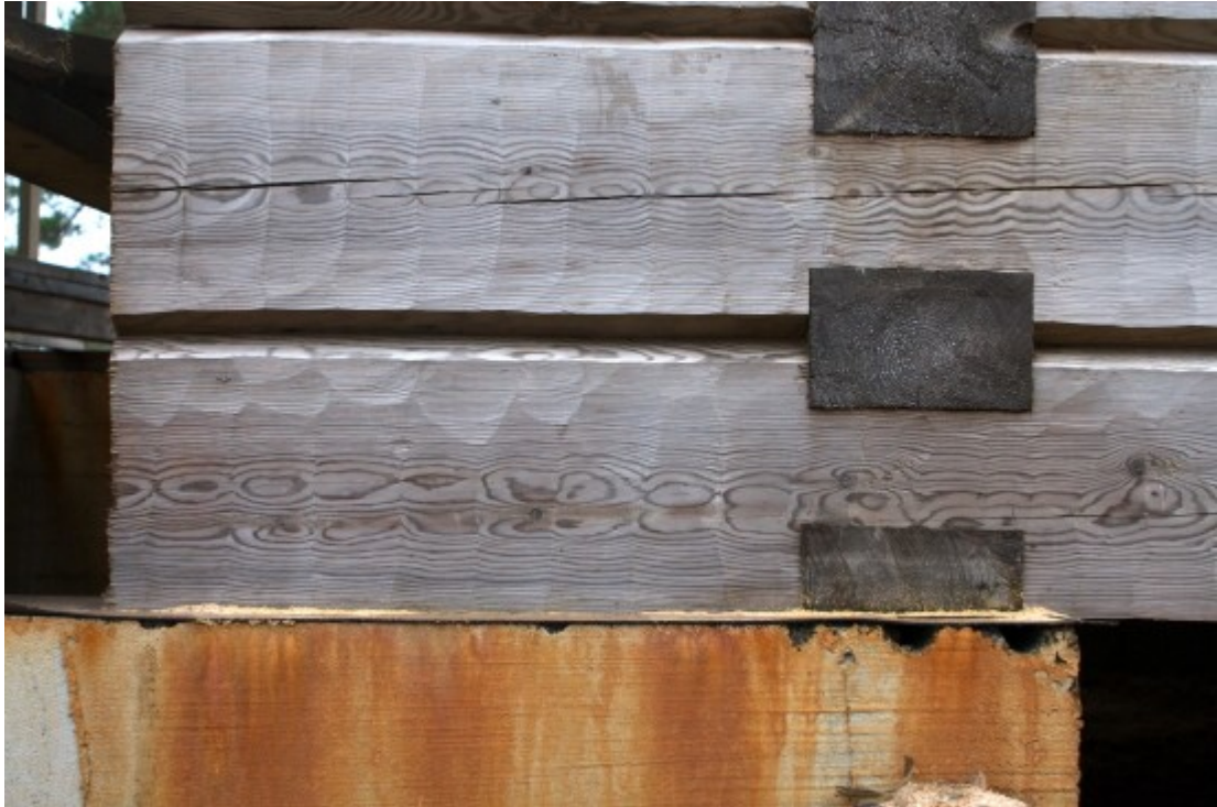
Kuva 4. Rautasulfaatti on värjännyt alla olevan rakenteen (Passiivipuutalo 2012)
