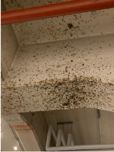
Kaapelitehtaalla on tarkoituksella jätetty osa pinnoista rosoisiksi, jotta säilyisi muistumia teollisesta käytöstä. Kuten esimerkiksi tässä kuvassa käytävän kattoon on jätetty vanha öljytahra. Kuva/ Kalle Saari
