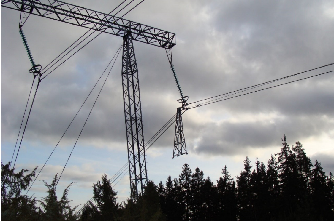
Kuva 16. Viereisen pylvään kaatumisen johdosta irronnut ukkospukki [32.]
