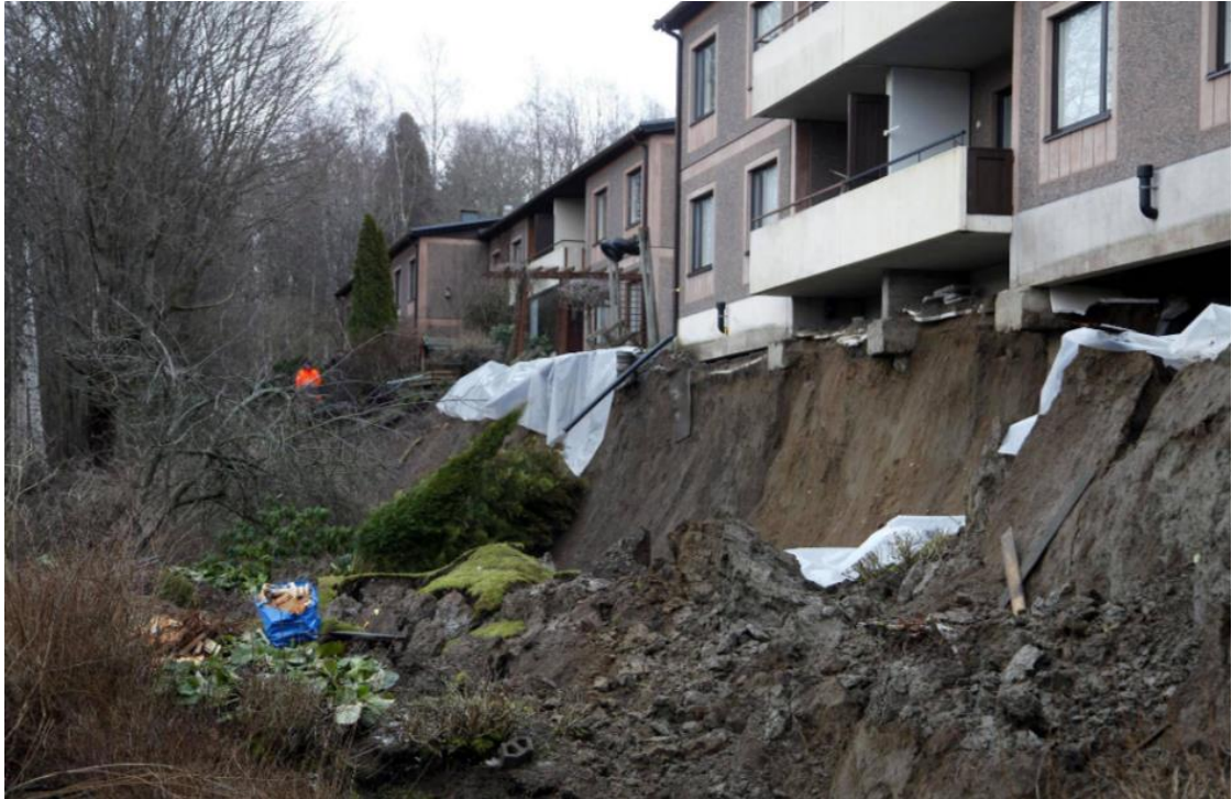
Kuva 1. Maaluiskan sortuma Tampereella sijaitsevien asuinrakennusten vieressä. Sortuman syyksi on määritetty, että asuinrakennus on rakennettu löyhän siltin päälle ja runsaalla sateella rakennuksen alla olevan silttikerroksen paino on kasvanut, mikä on johtanut maaluiskan sortumaan. (Mannila, M. 2020) (Kuva: Hietanen, R. (2020))
