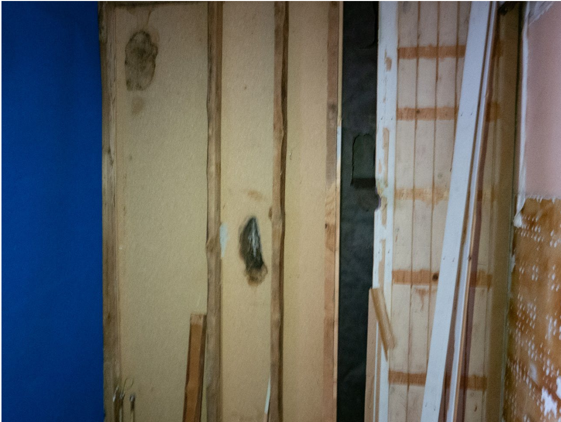
Kuva 35. Asunnon märkätilan seinässä voidaan nähdä selkeitä vaurioita.
