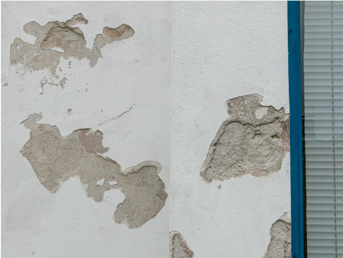
Kuva 54. Julkisivun rappaus on paikoin huonokuntoinen.
