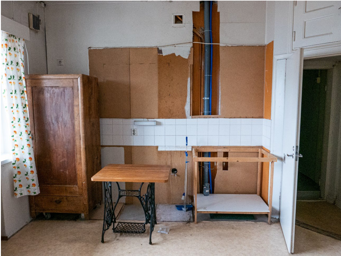
Kuva 31. Pohjakerroksen asunnon keittiötilaa. Pinnat ovat monin paikoin huonokuntoisia tai jääneet muutostöiden jäljiltä keskeneräisiksi.
