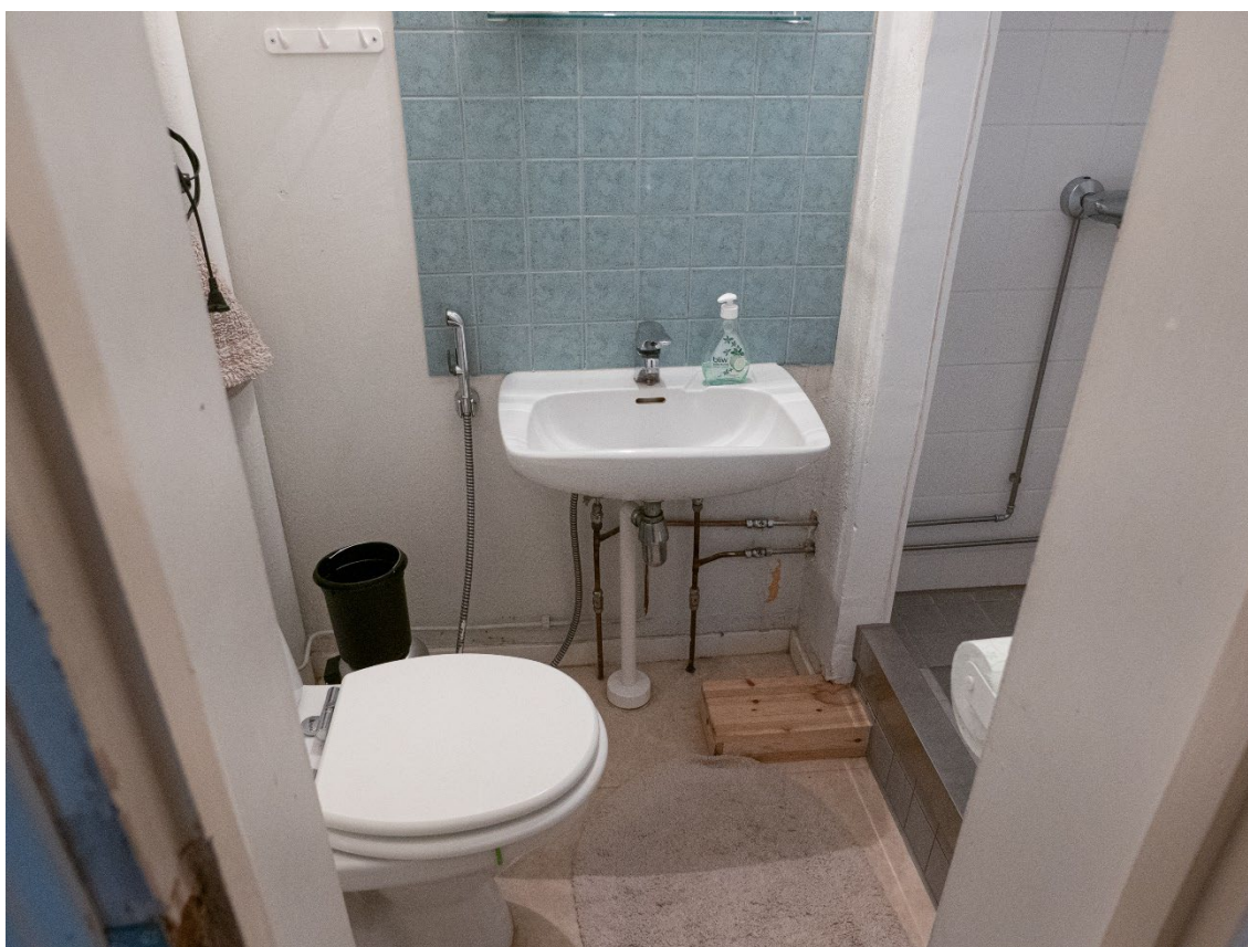
Kuva 59. Rakennuksen ainoa edelleen käyttökelpoinen märkätila löytyy toisesta kerroksesta majatalon tiloista.
