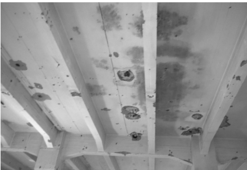
Kuva 4. Vanhan tekstiilitehtaan välipohjassa näkyy rakenteen läpi imeytynyt öljy.
