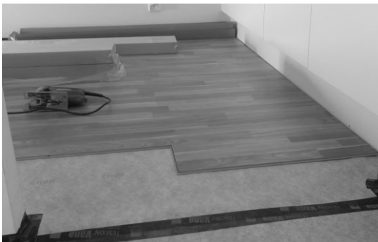
Kuva 1. Korjausvaihe. Lattiaan on asennettu cTrap, jonka saumat ja reunat on teipattu. Meneillään on uuden lattianpäällysteen asennus cTrap-tuotteen päälle.
