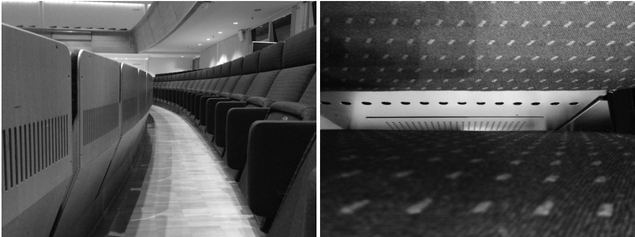
Kuva 3. Konserttisalin ilmanvaihdon tuloilmareitti oli alkujaan toteutettu osana istuinten selkänojan rakennetta (vas.). Korjaushankkeen yhteydessä tehtiin uudet tuloilmareitit lattian kautta istuimen alta (oik.). Kuvallähde: A-Insinöörien kuva-arkisto.
