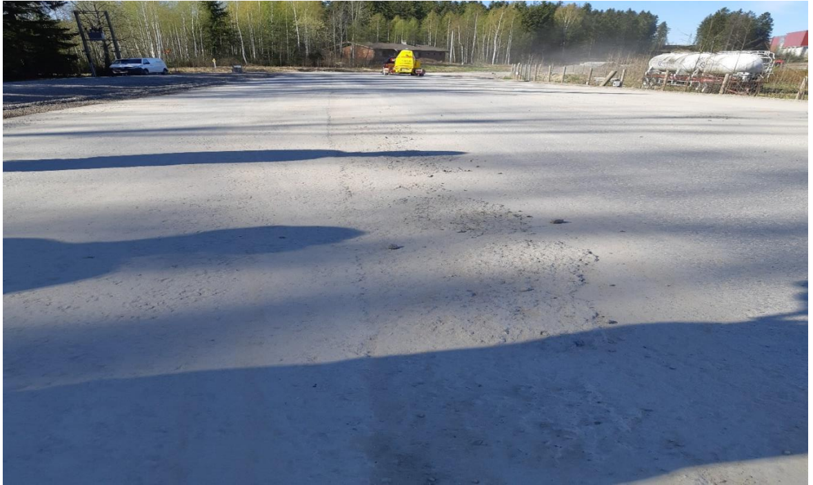
Kuva 17. Asfaltin sauma koko tien pituudella. Sauman vieressä myös kovettunutta soraa (Vaurioinventointi 2021, Fortum Waste Solutions Oy).
