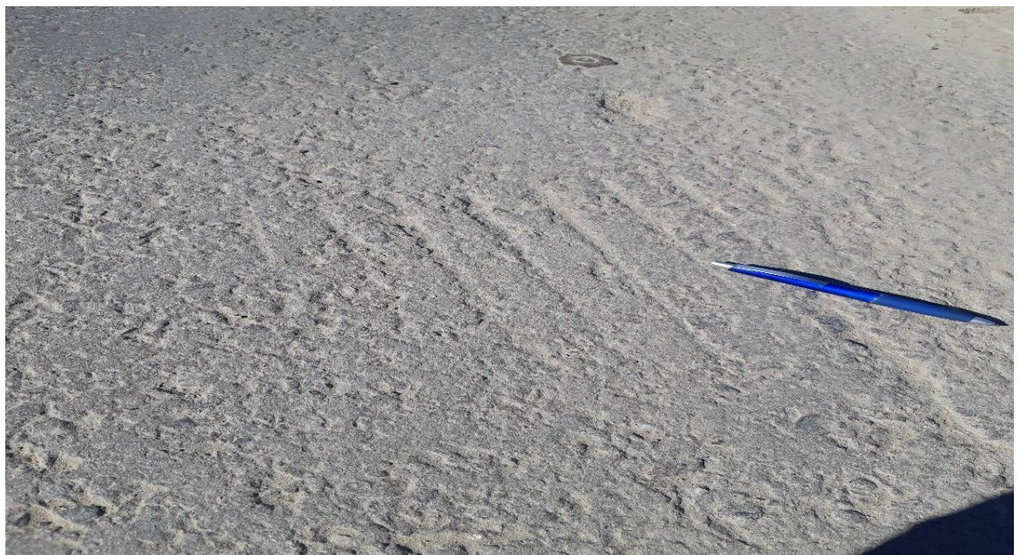
Kuva 18. Talvikunnossapidon aiheuttamaa vauriota tien pinnassa (Vaurioinventointi 2021, Fortum Waste Solutions Oy).
