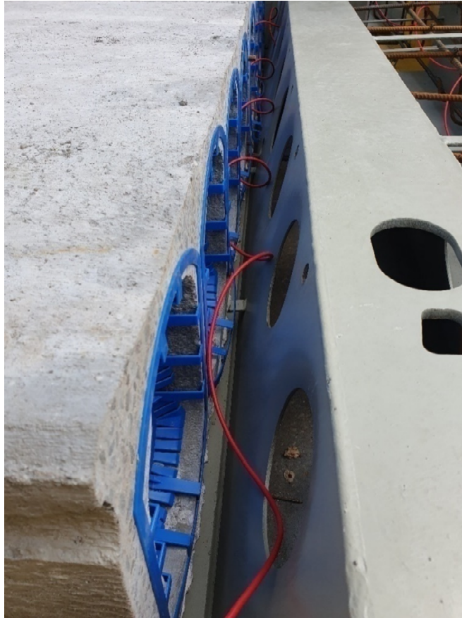
Kuva 11 Deltapalkin ja ontelolaatan väliseen saumaan asennettu lämmityskaapeli ennen betonivalua betonin kuivumisen edistämiseksi.
