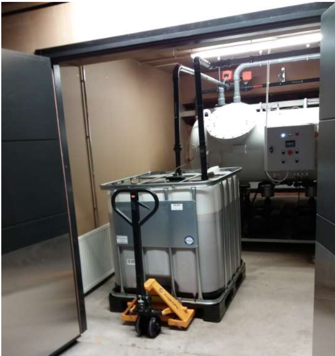
Kuva 11 Mustan veden keräys- ja kuljetusjärjestelmä
