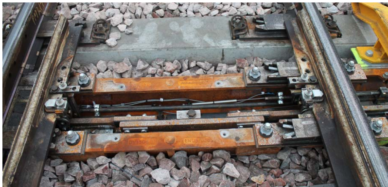
Kuva 6. Vaihteenkääntölaitteen kohdalle asennettu ontto pölkky, jonka sisällä vaihteenkääntölaitteen tangot pääsevät kulkemaan vapaasti. Pölkystä on kuvaushetkellä poistettu kansirakenne.
