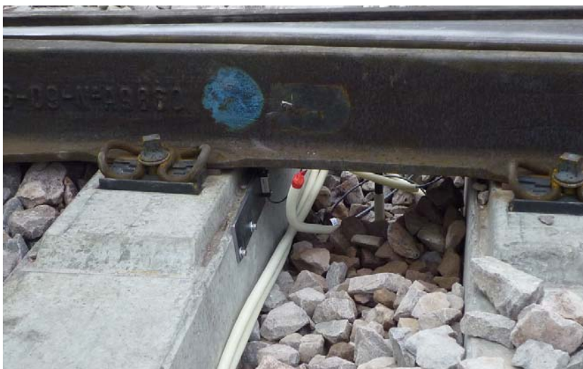
Kuva 14. Kiskon ja pölkyn välisen liikkeen mittaava anturi risteysosan alla.
