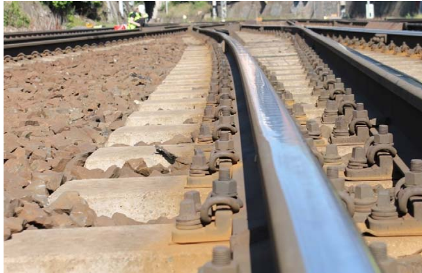
Kuva 58. Tampereen vaihteen V062 poikkeavan raiteen sisäkiskon korrugaatio.
