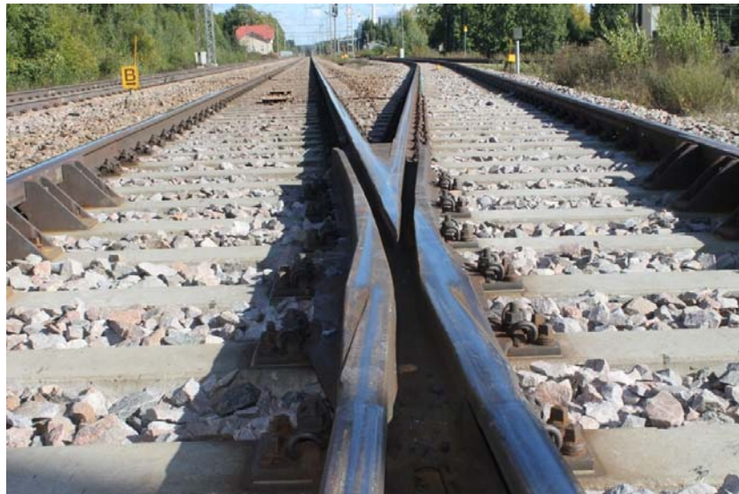
Kuva 52. Taavetin vaihteen V415 kulunut risteysosa.
