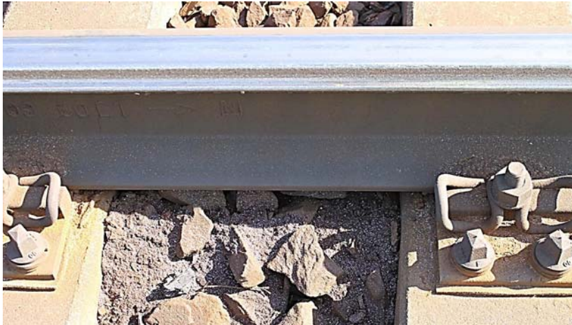
Kuva 56. Tampereen vaihteen VO62 poikkeavan raiteen voimakkaasti kulunut kisko.
