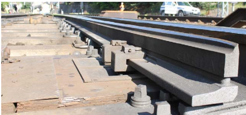
Kuva 57. Laippakosketuksen vaurioittama kieli Tampereen vaihteessa VO62.
