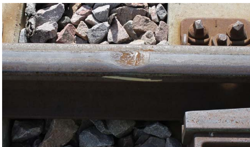
Kuva 48. Kaipiaisten vaihteessa V213 havaittu ympärilyöntivika.
