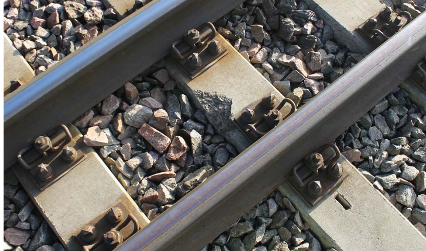
Kuva 51. Vaurioitunut pölkky Taavetin vaihteen V413 risteysalueella.
