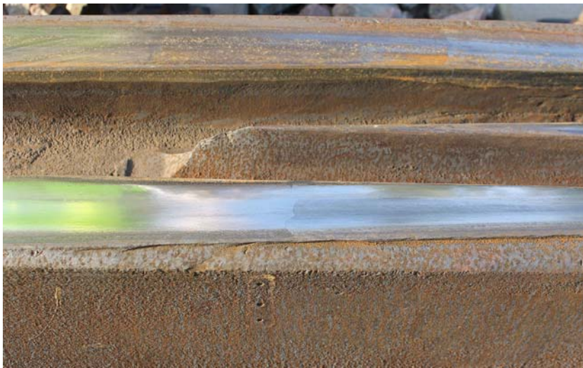
Kuva 50. Taavetin vaihteen V413 siipikisko, jossa on merkkejä kiskon päällehitsaamisesta.
