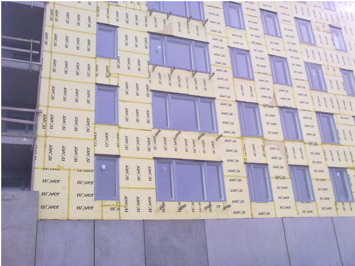
Kuva 8.2 Ulokeparvekkeen kannattajat katkaisevat lämmöneristekerroksen.
