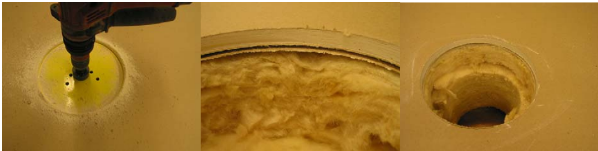
Kuva 4.4.1 Läpivientejä varten tarvittavat reiät tehtiin rasiaporalla (vasemmalla). Sekä paperipohjainen ilmansulku (keskellä) että höyrynsulkumuovi (oikealla) leikkautuivat siististi reunoiltaan.
