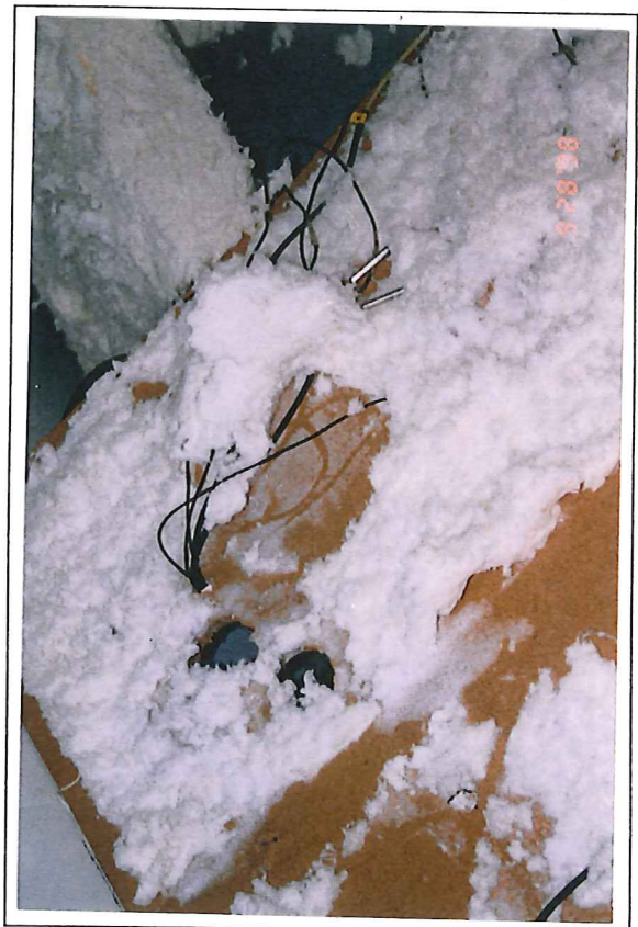
Kuva 8. Koeseinässä 8 myös lämmöneriste jäättyi lähes kauttaaltaan kiinni tuulensuojalevyyn (katselusuunta toisinpäin).
