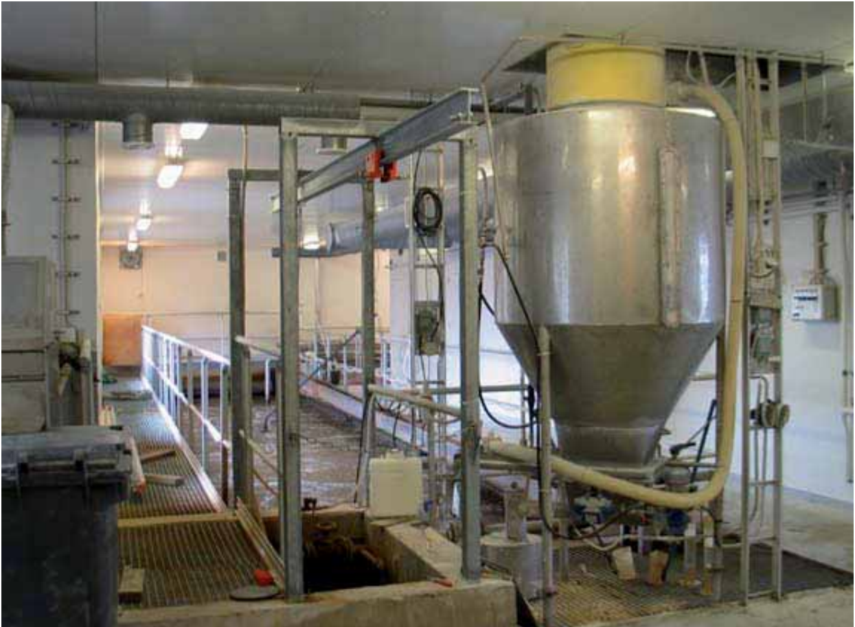
Kuva 8.21. Reposaaren uusi jätevedenpuhdistamo sisältä. (Katko 2009)
