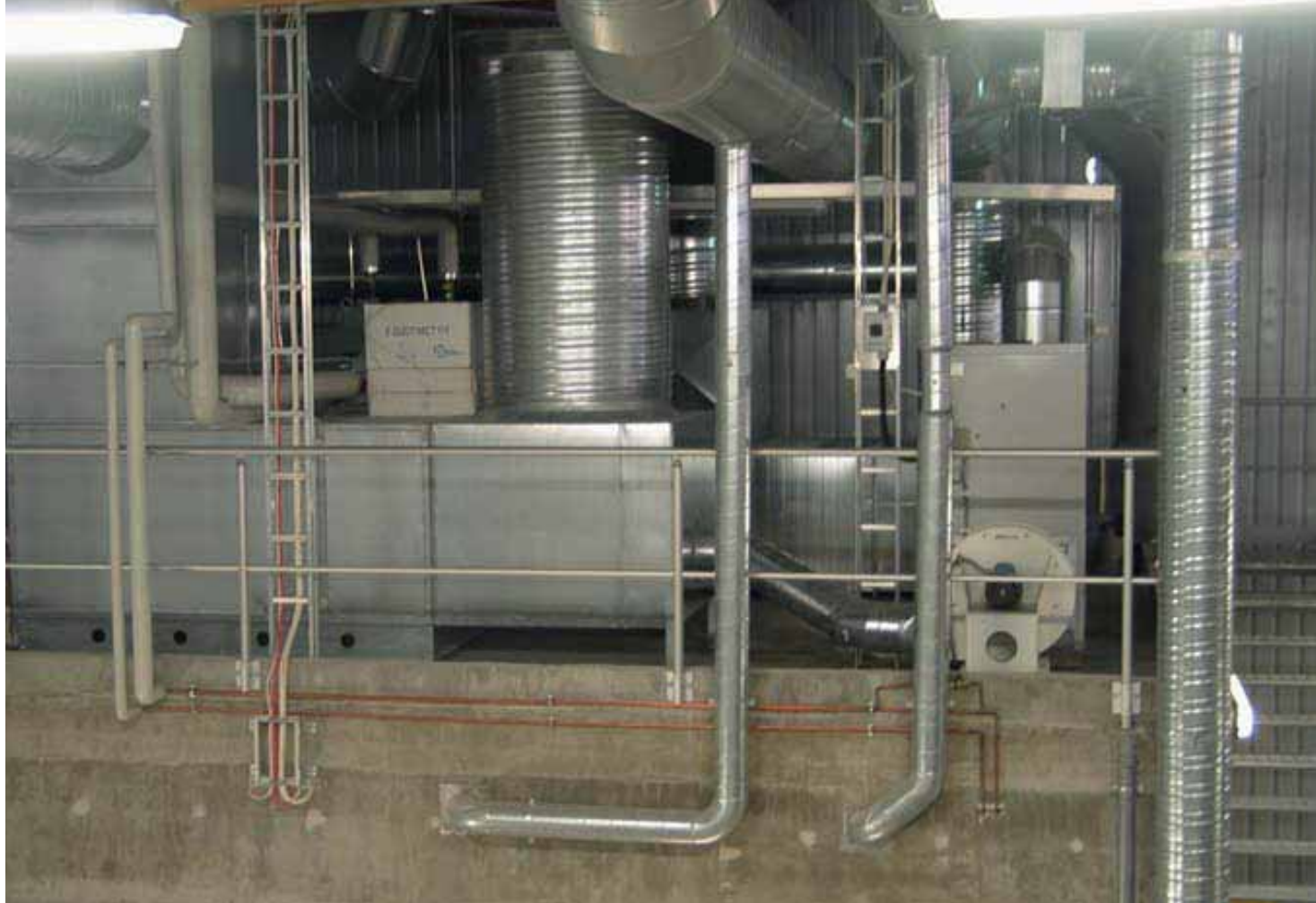
Kuva 7.25. Harjakankaan laitoksen Prosessitilojen ilmastointikoje. (Katko 2009)
