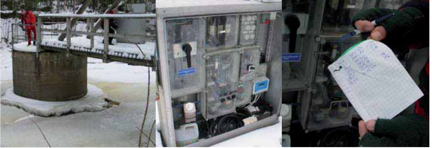
Kuva 7.17 a, b ja c. Palusjärven eteläpään pumppaamo, ohjausyksikkö ja kuitausvihko (Katko 2009)
