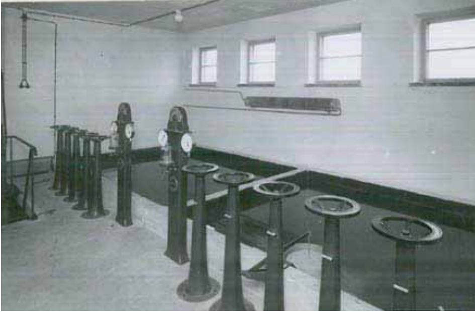
Kuva 6.35. Lukkarinsannan pintavesilaitoksen suodatinhuone. (Porin Vesi)
