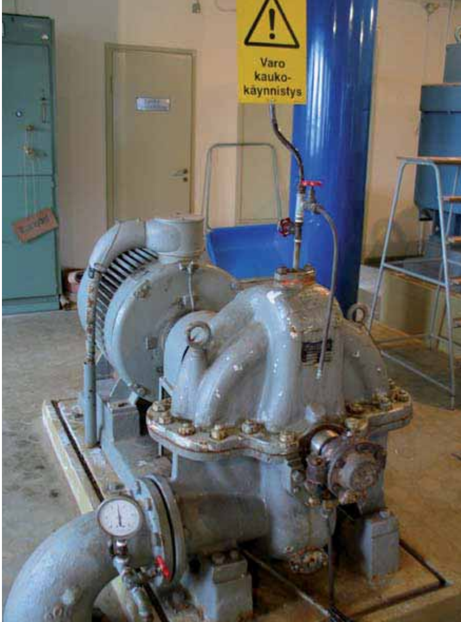
Kuva 7.2. Vuonna 1957 Lukkarin-santaan asennettu puhtaan veden paineenkorotuspumppu, joka on käyttökunnossa vielä v. 2009 (Katko 2009).
