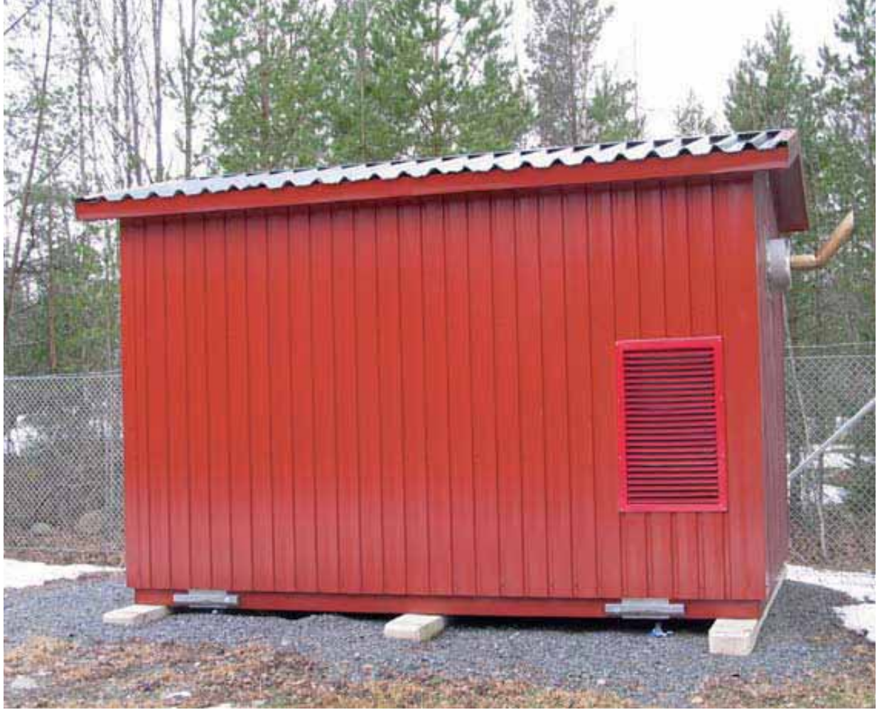
Kuva 7.43. Ahlaisten pohjavedenottamon varavoimala. (Katko 2009)
