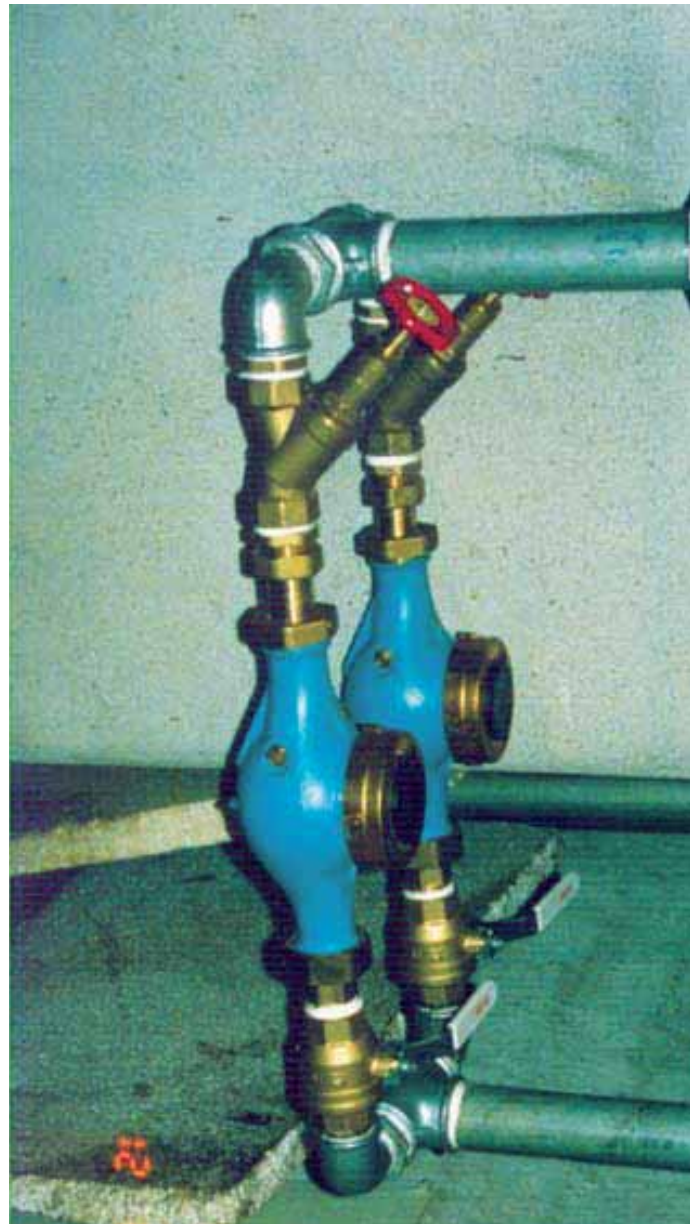
Kuva 9.41c. Uusi vesimittari korvasi kerrostalon vanhan systeemin. (Porin Vesi 12.6.1991)
