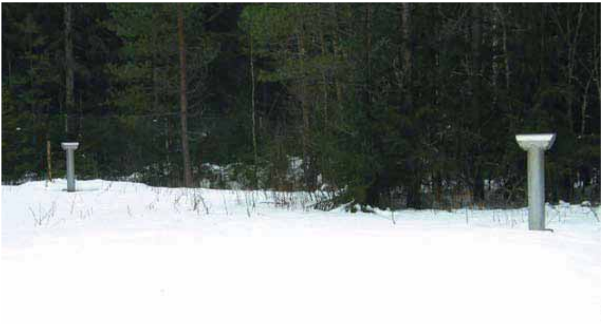
Kuva 7.33b. Harjakankaan vedenottoaivoja: kaksi kuilukaivoa ilmas- tointiputkineen. (Katko 2009)
