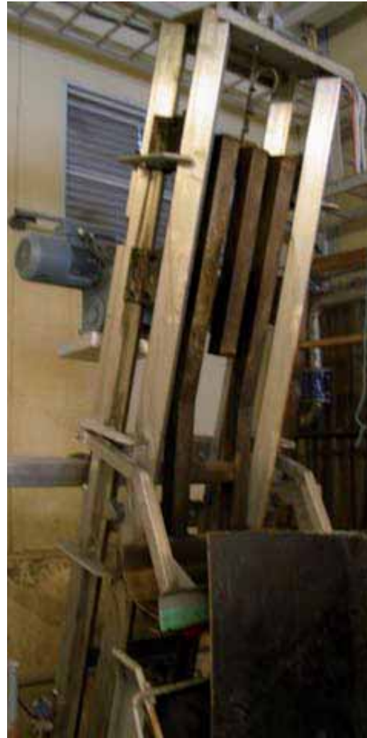
Kuva 7.22b. Harjakankaan laitoksen raakavesialtaan konevälppä (Katko 2009).
