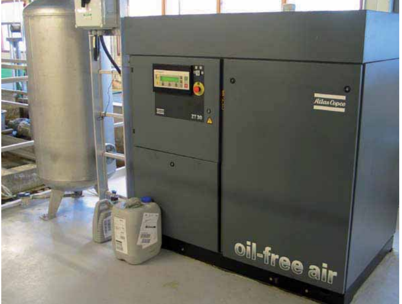
Kuva 7.24. Öljyvapaa ilmakompressori Harjakankaan laitoksella (Katko 2009).
