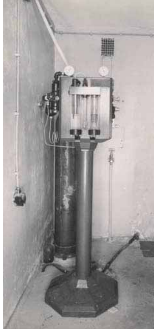
Kuva 6.32. Lukkarinsannan pintavesilaitoksen kloorikaasukoje. (Porin Vesi)
