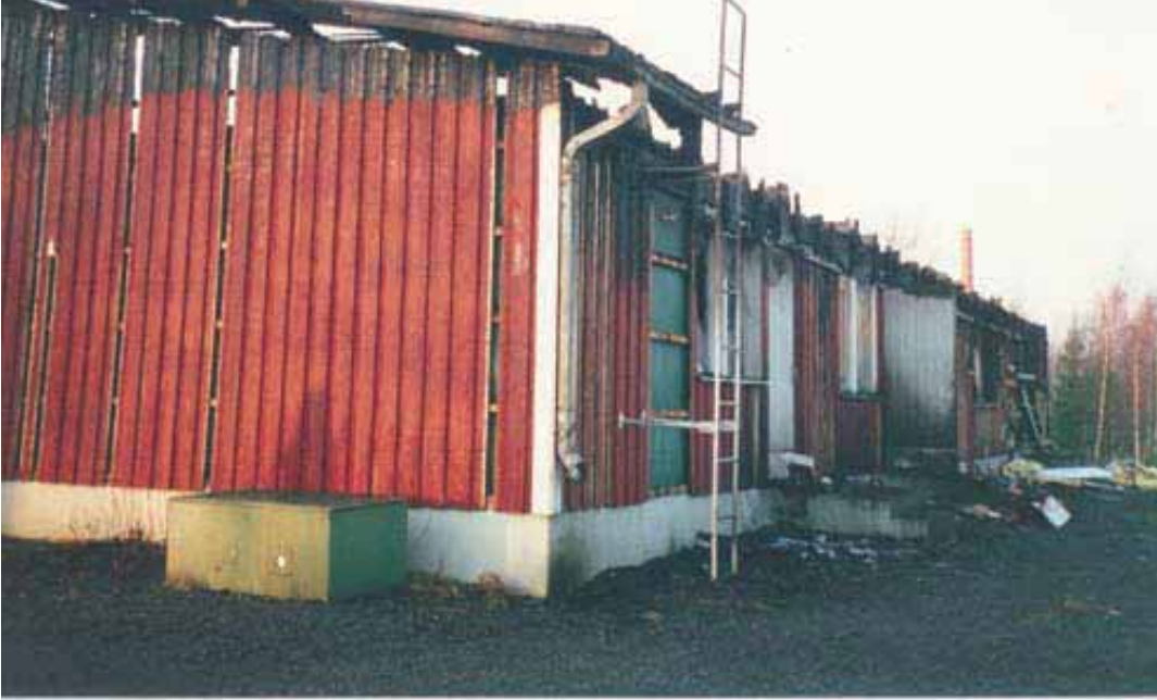
Kuva 8.20c ja d. Reposaaren jätevedenpuhdistamo todennäköisesti tuhopoltettiin syksyllä 1996. (Porin Vesi 1996)
