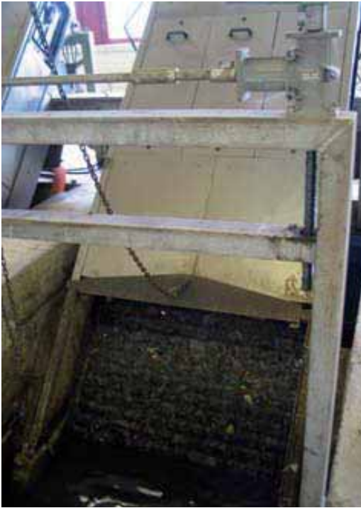
Kuva 8.10. Luotsinmäen jätevedenpuhdistamon välppäämö. (Katko 2009)
