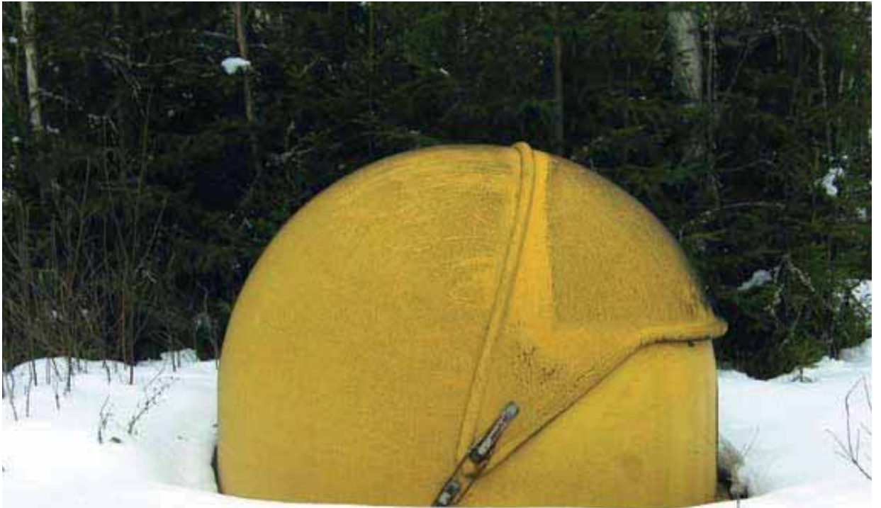
Kuva 7.33a. Harjakankaan vedenottoaivoja: siiviläputkikaivo. (Katko 2009)
