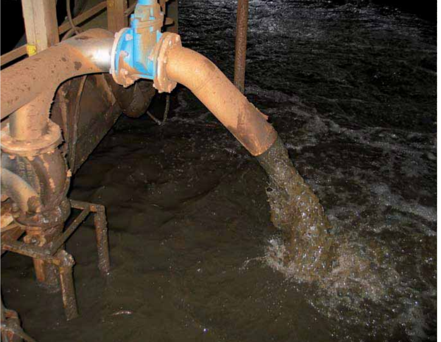
Kuva 8.19a ja b. Pihlavan jätevedenpuhdistamon palautusliete sekä palautuslietteen laskeumasylinterit sekä tulevan ja lähtevän jäteveden laskeumakartiot. (Katko 2009)
