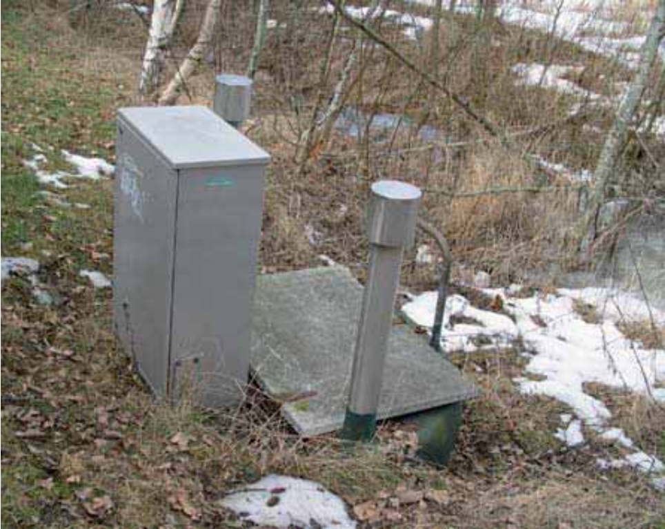
Kuva 8.23. Ahlaisten jätevedenpuhdistamon tulopumppaamo. (Katko 2009)
