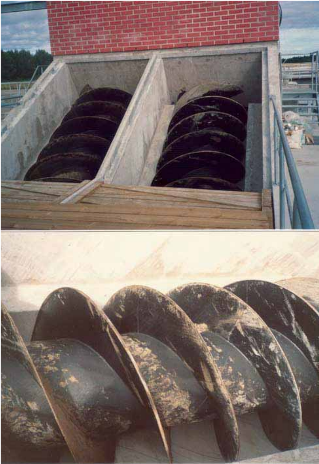
Kuva 8.4o ja p. Luotsinmäen jätevedenpuhdistamo. II- vaiheen palautusliete-ruuvipumput. Kuvauspäivä 4.8.1995.
