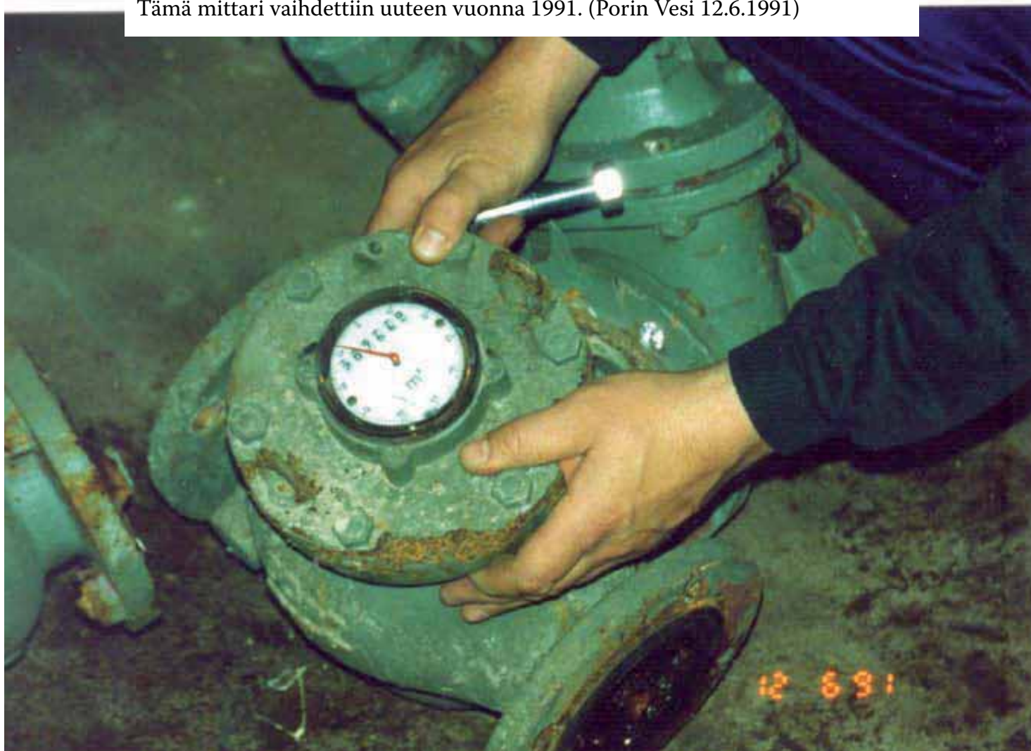
Kuva 9.41a ja b. Kuvassa kerrostalon vanha vesimittari ja sen tarvitsema varustus. Tämä mittari vaihdettiin uuteen vuonna 1991. (Porin Vesi 12.6.1991)
