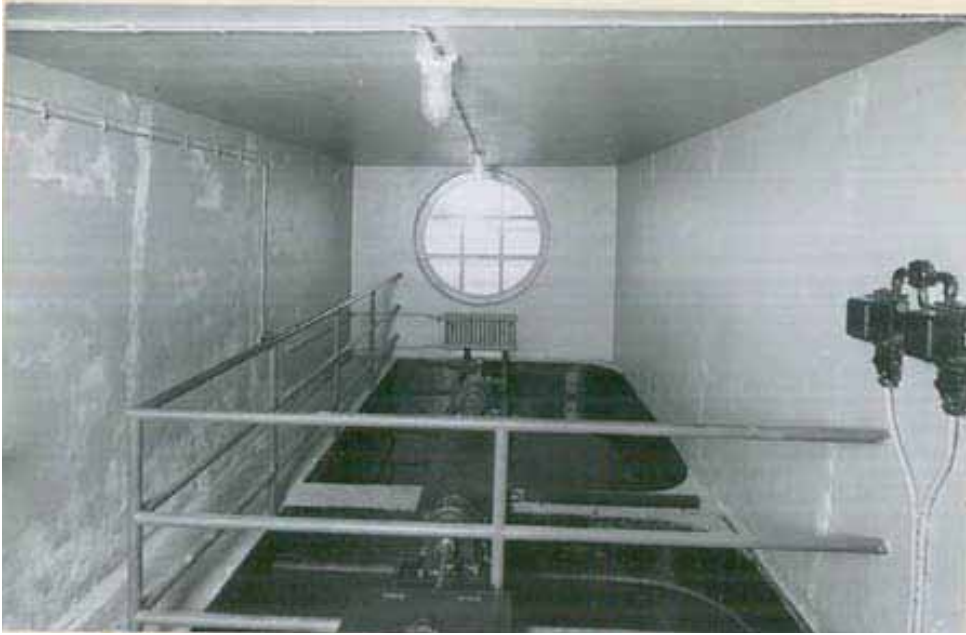
Kuva 6.37. Lukkarinsannan pintavesilaitoksen reaktioaltaat. (Porin Vesi)
