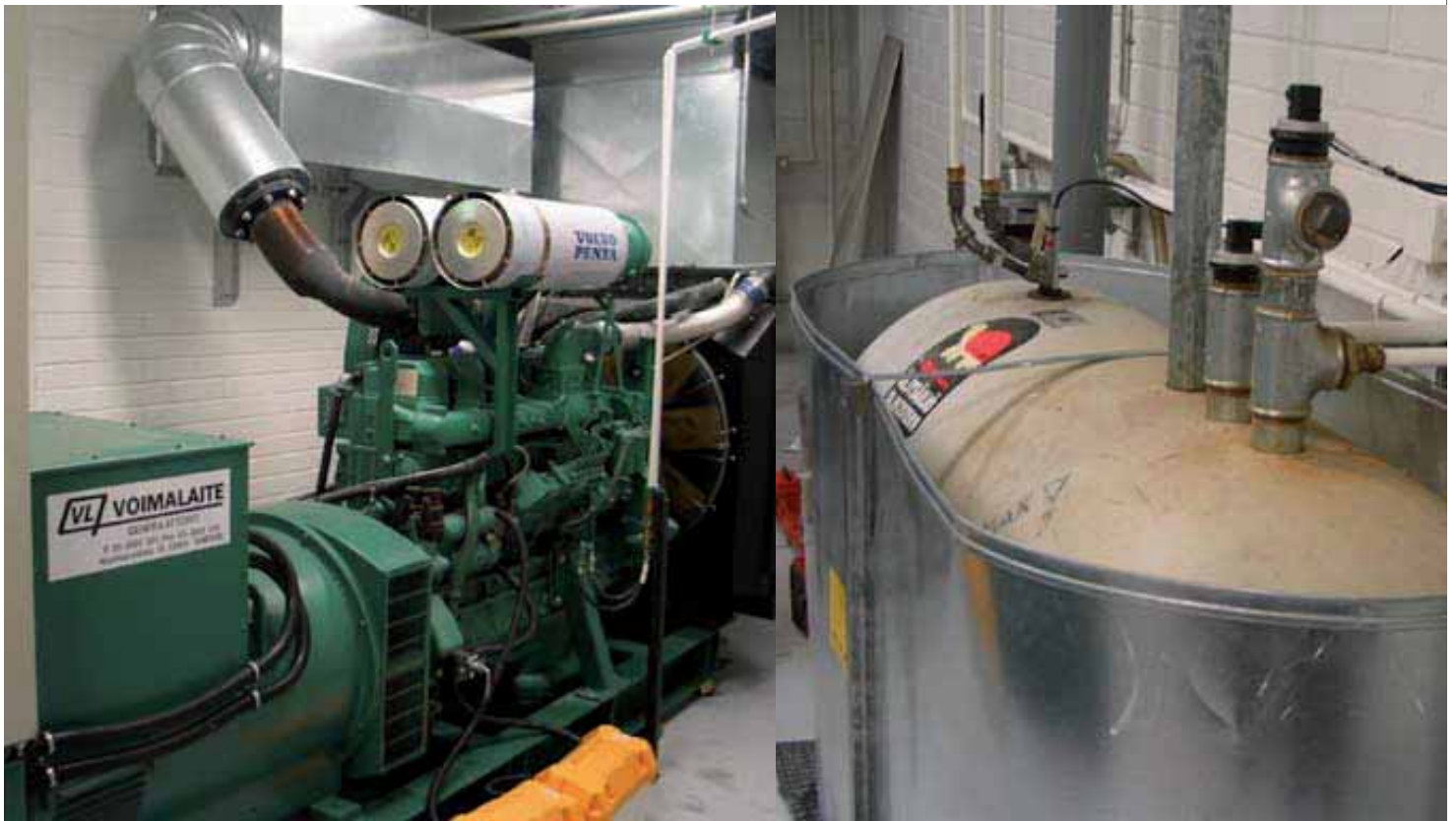
Kuva 7.36. Harjakankaan varavoimakone ja päiväsäiliö polttoöljylle. (Katko 2009)
