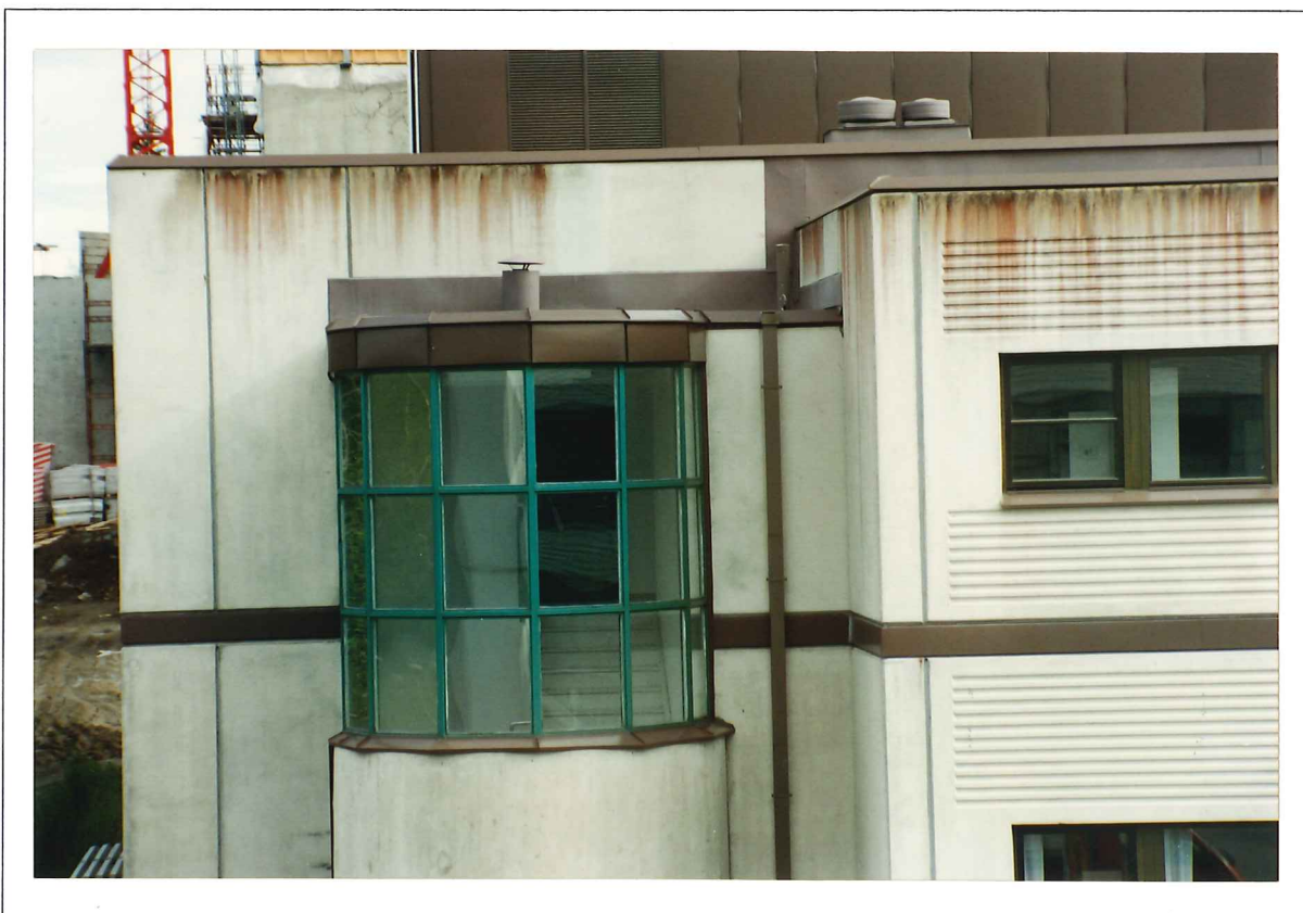
Kuva 6.11. Huonosti suunnitellut räystäspellitykset aiheuttavat seinän yläpään värjäytymistä. (Kuva: TTKK, Talonrakennustekniikan laboratorio)
