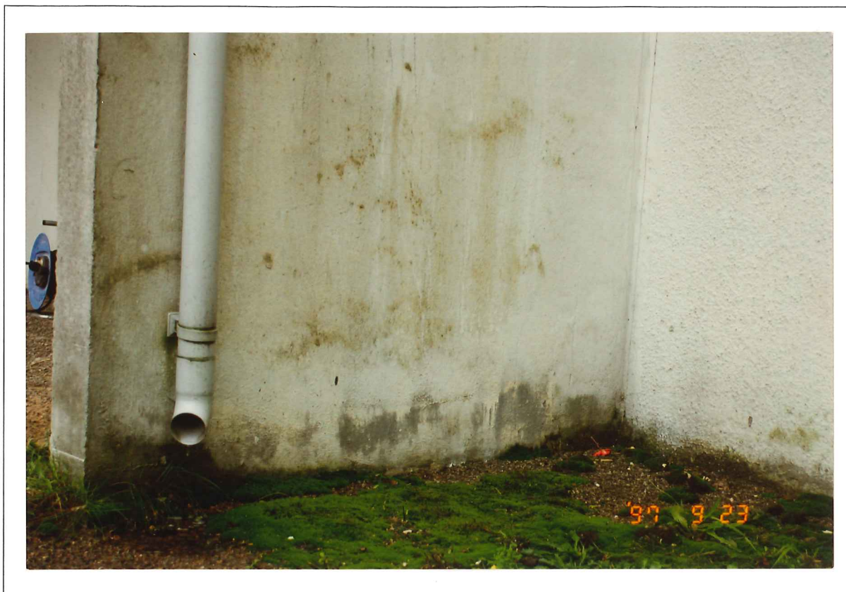
Kuva 6.10. Pintavedet sekä syöksytorven vuoto- ja roiskevedet ovat vaurioittaneet parvekepieliseinää. (Kuva: TTKK, Talonrakennustekniikan laboratorio)
