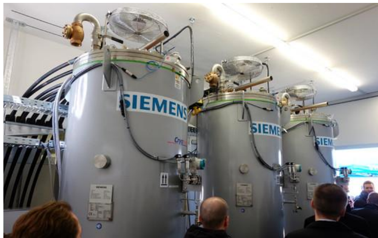
Kuva 12. Stadtwerken sähköverkkoon asennettu vikavirranrajoitinjärjestelmä erillisine kryostaatteineen.
