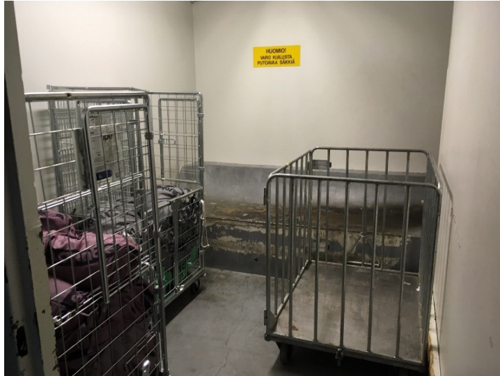
Kuva 19. A-siivessä sijaitseva jäte-/pyykkikuilu. Säkit tiputetaan osastoilta kuiluihin, joista ne ohjautuvat kuvan tasolle, josta ne lajitellaan oikeisiin vaunuihin.
