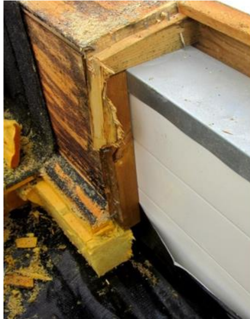
Kuva 16. Yläpohjan höyrynsulkua ei ole liitetty tiiviisti ulkoseinään ja kattorakenteet ympäriltä vaurioituneet. (FISE 2018)
