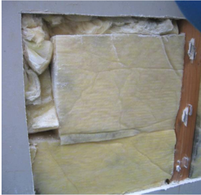
Kuva 15. Ulkoseinän lämmöneristyksessä käytetty ylijäämäpaloja ja eristeet on asennettu epätiivisti. (FISE 2018)
