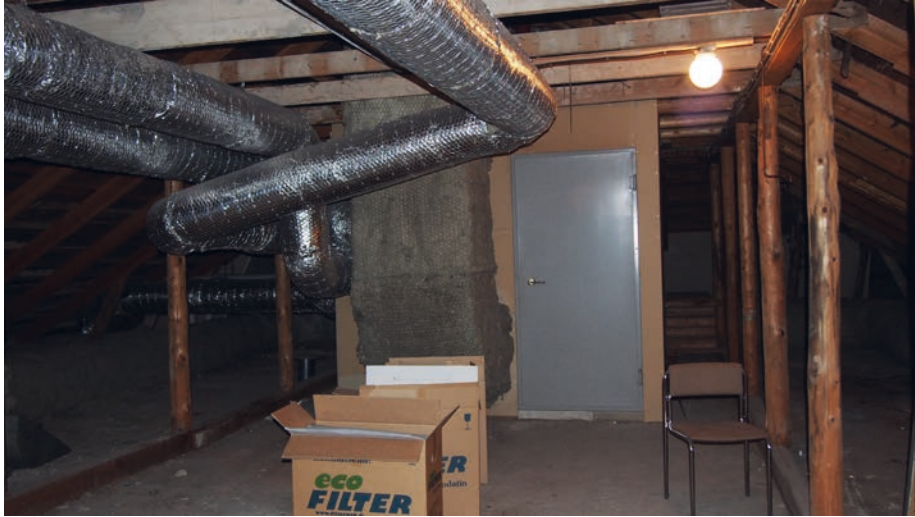
Kuva 148: Teatterin puolen iv-konehuone
