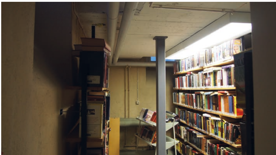
Kuva 150: Kellarissa (kuvassa pienemmän kirjavaraston takaosa) putket kulkevat paikoin näkyvälläkin paikalla.
