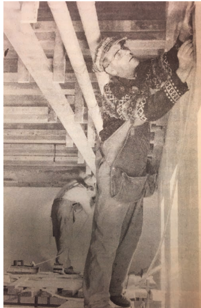
Kuva 67: Käynnissä rakennuksen muutostyöt. Artikkelin käsitteli saneerauksen kaksinkertaistunutta budjettia, mutta ei paljastanut tarkemmin kuvauspaikan sijaintia rakennuksessa.
