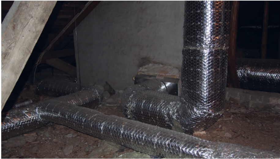
Kuva 149: Vanhoja hormoneja on ainakin osittain käytetty nykyisen tekniikan läpivienteinä.
