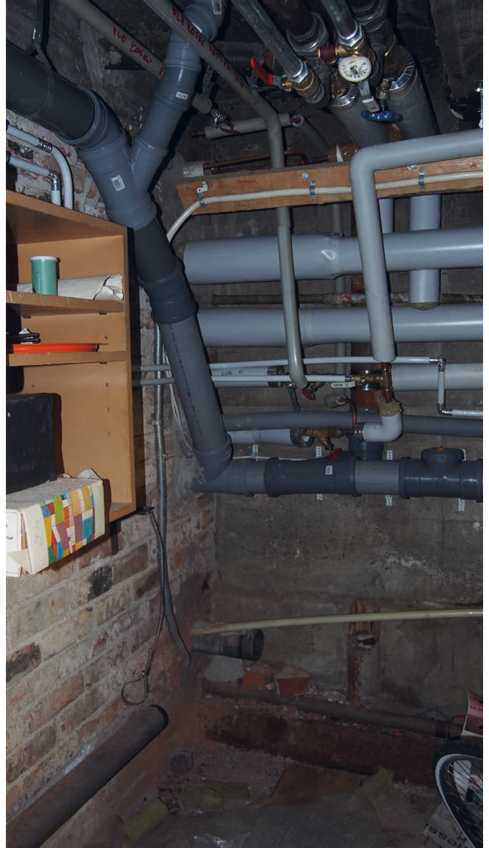
Kuva 151: Keskikellarissa talotekniikka on hyvin näkyvissä, mutta kirjavaraston puolella (tiiliseinän toisella puolella) niiden eteen on rakennettu kevyt väliseinä.
