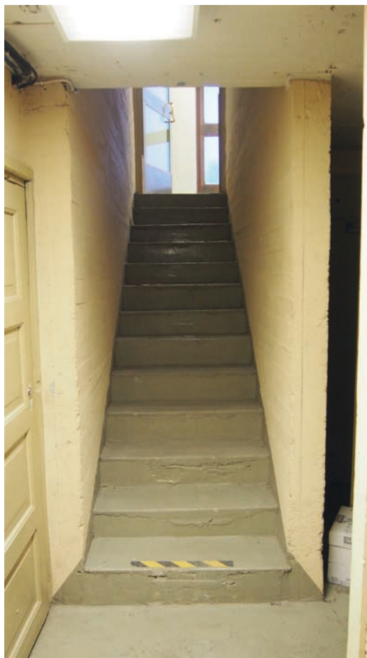
Kuva 102: Portaikko on hieman kapeampi kuin ylempien kerrosten portaikot. Vasemmalla lämmönjakokeskus,
