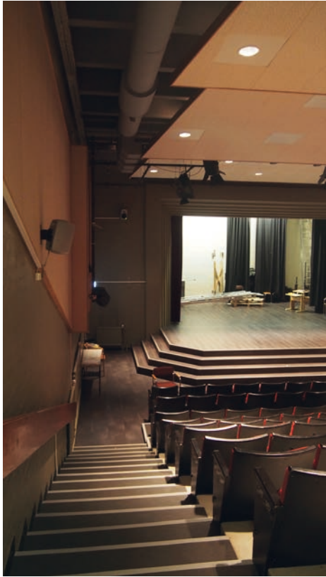
Kuva 108: Teatterin vasen portaikko. Teatterin ulkoseinät kannattelevat palkiston avulla yläpohjaa. Ilmanvaihtoputkille on puhkaistut reitit yläpohjan läpi.
