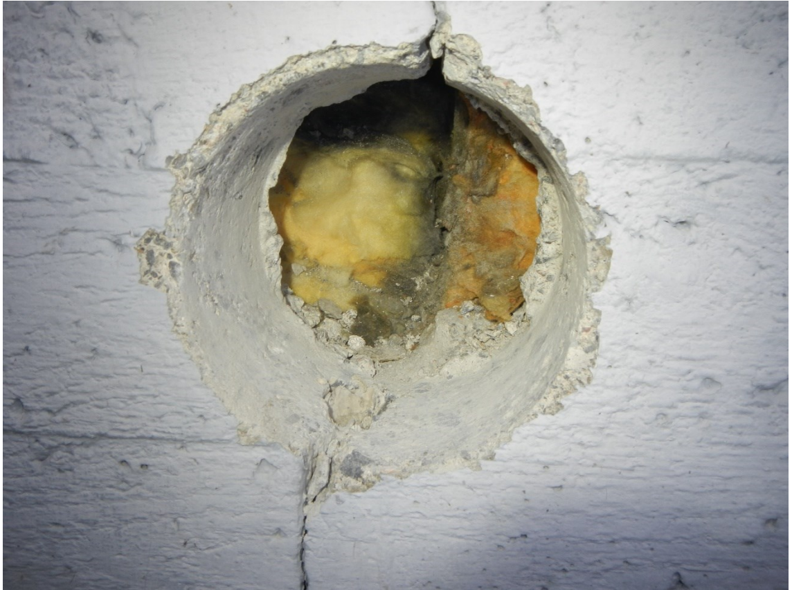
Kuva 4. Rakenteessa kosteuden takia punertunut eriste. (Ruusala 2019)
