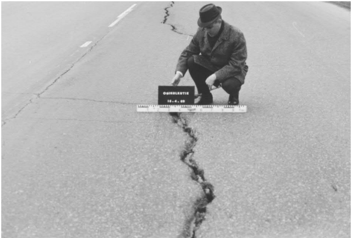
Kuva 14 Routimisen aiheuttama halkeama asfalttipäällysteisessä tiessä. (Ehrola 1996)
