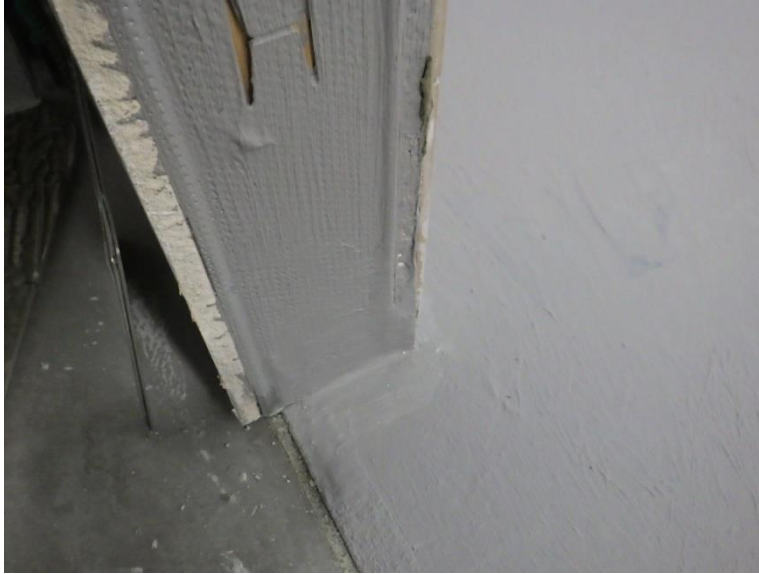
Kuva 2. Vedeneriste on jatkettu hyvän rakennustavan mukaisesti tulevien karmien taakse. Vedeneristyksessä ei kuitenkaan RT-kortin ohjeistama 15mm vedeneristeen ylösnosto toteudu, vaan kynnyksen ja lattiaan liittymä silikonilla.
