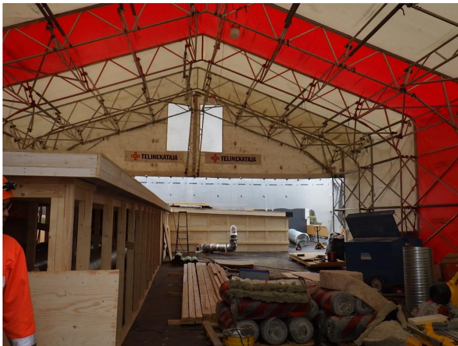
Kuva 8. Vesikattotöitä on tehty lohkoittain sääsuojan alla. Sääsuojaa siirrettäessä osa keskeneräisistä ja vielä avoimista rakenteista on jäänyt suojaamatta.
