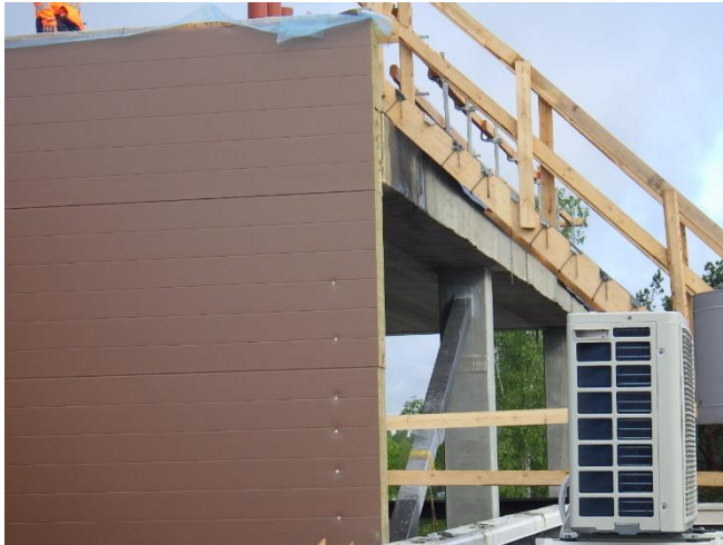
Kuvat 8. Sandwichelementtien yläreuna on suojattu rakennusmuovilla. Päätysivut on suojaamatta.
