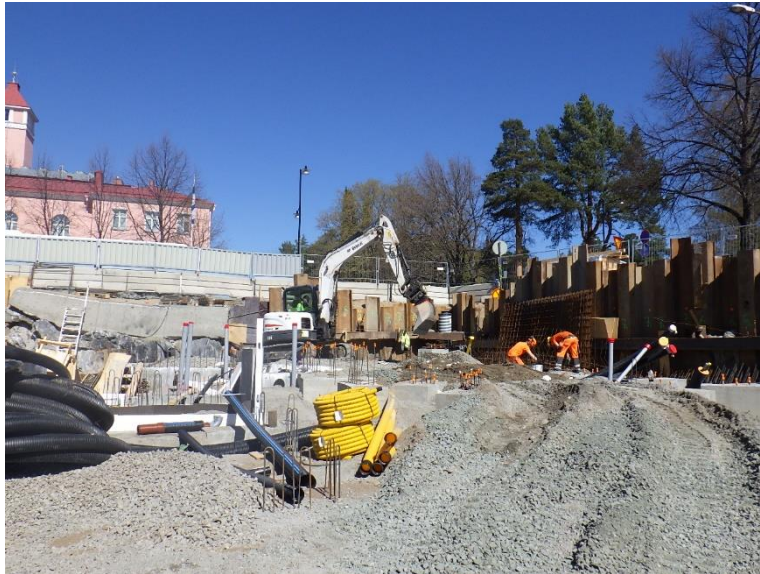
Kuva 2. Suunnitelmissa ei ole mainittu riittävän tarkasti täytön alueita. Maanrakennus urakoitsija oli käyttänyt täyttöihin kuvassa esiintyvän kaivinkoneen kohdalla maainesta jolla ei ollut riittäviä kapillaarisuuden katkaisevia ominaisuuksia. Maa kaivettiin uudelleen pois ja korvattiin kapillaarikatkosepellillä.
