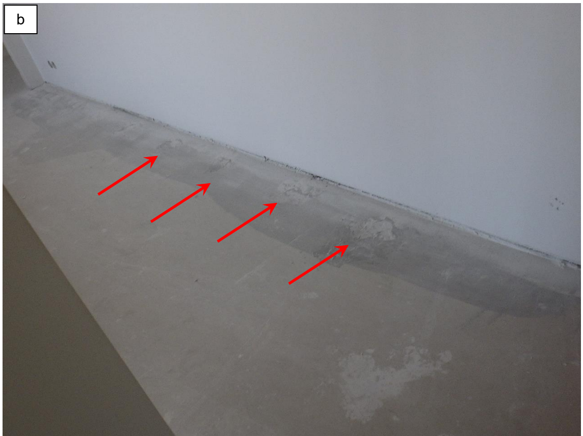
Kuvat 4 a ja b. Ontelolaattojen vedenpoistorei'istä on vielä paikoin tihkunut onteloihin jäänyttä rakennusaikaista kosteutta. Onteloiden kuivattamiseksi reikiä on porattu alapuolelta lisää ja tarvittaessa piikattu onteloita yläpuolelta osittain auki, jotta ontelo pääsee tuulettumaan ja kuivumaan. Kuvassa b ontelolaatan yläpuoliset piikkaukset on merkitty punaisilla nuolilla. Piikkausreiät on paikattu.
