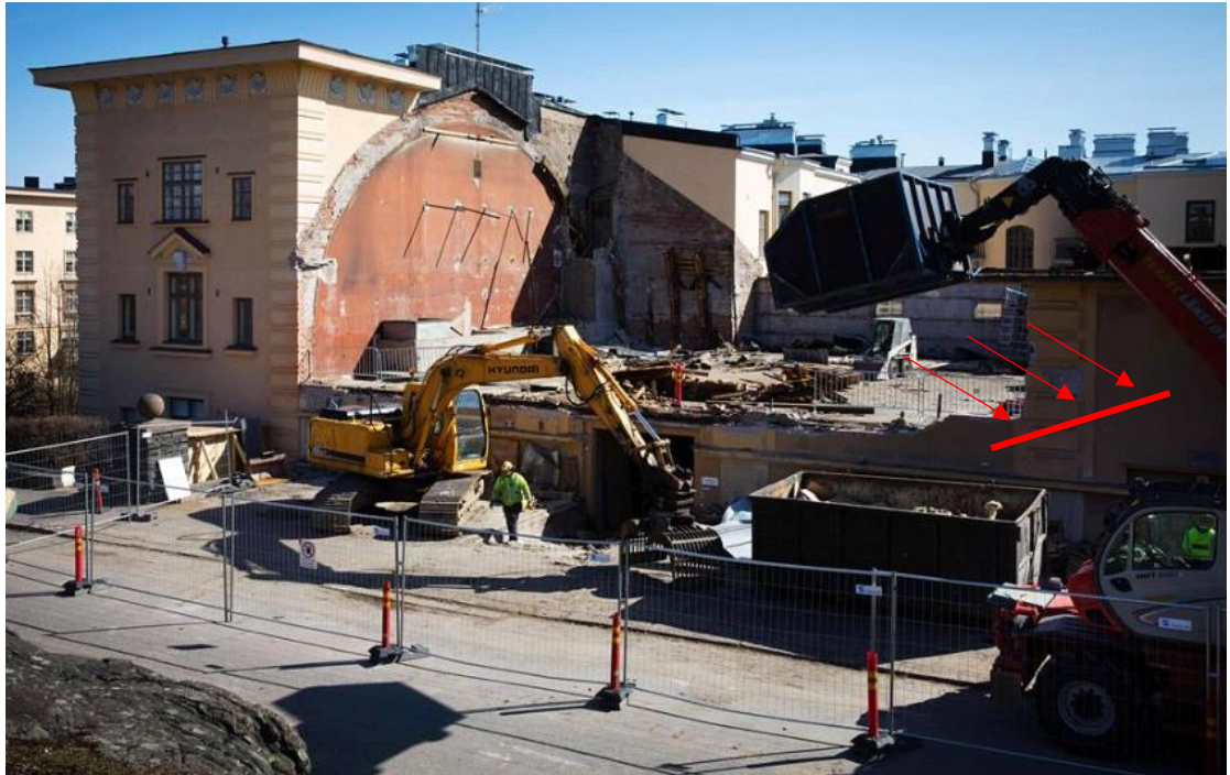
Kuvat 3. Rakennuksen uudet välipohjavalut liittyivät osittain vanhaan rakennusten väliseen massiivitiiliseinään. Valun yhteydessä massiivitiiliseinä pääsi kastumaan aiheuttaen kosteusjälkiä viereisen asunnon sisäpinoilla. Asiasta tehtiin vahinkoilmoitus. (Kuva: Helsingin Sanomat)
