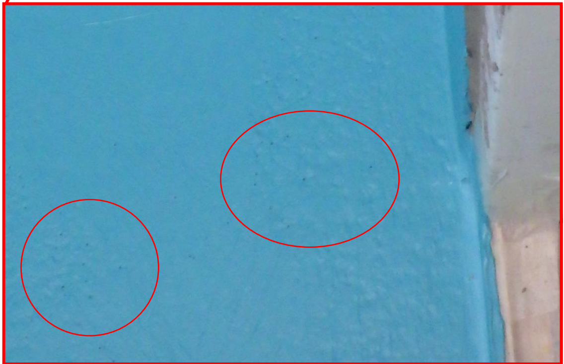
Kuvat 5 a ja b. Vedeneristystöiden laadussa kylpyhuoneissa havaittiin puutteita. Vedeneristetyt on paikoin painunut alustassa olleiden epätasaisuuksien (pienien reikien kohdalta). Vedeneristettä ei ole näissä kohdissa riittävästi ja pintaan on kuroutunut reikiä vedeneristykseen.
