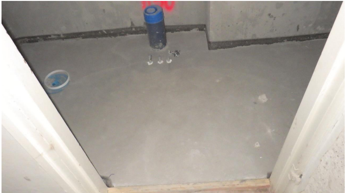
Kuva 3. Märkätiloissa on porattu porareikämittauksia varten reikiä. Katselmuspäivänä 5.6.2019 ulkoilman lämpötila oli päiväaikaan 28 °C. Porareikämittauksen tuloksia voidaan pitää luotettavina, kun mittaus on toteutettu +15 °C – +25 °C lämpötilassa.
