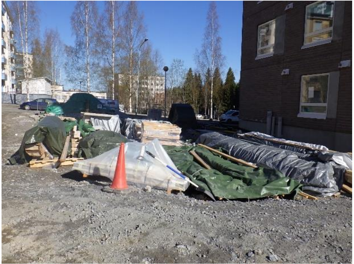
Kuvat 3 a ja b. Osa materiaaleista on varastoitu ulkona. Materiaalit on suojattu pressuilla ja nostettu ylös maasta.
