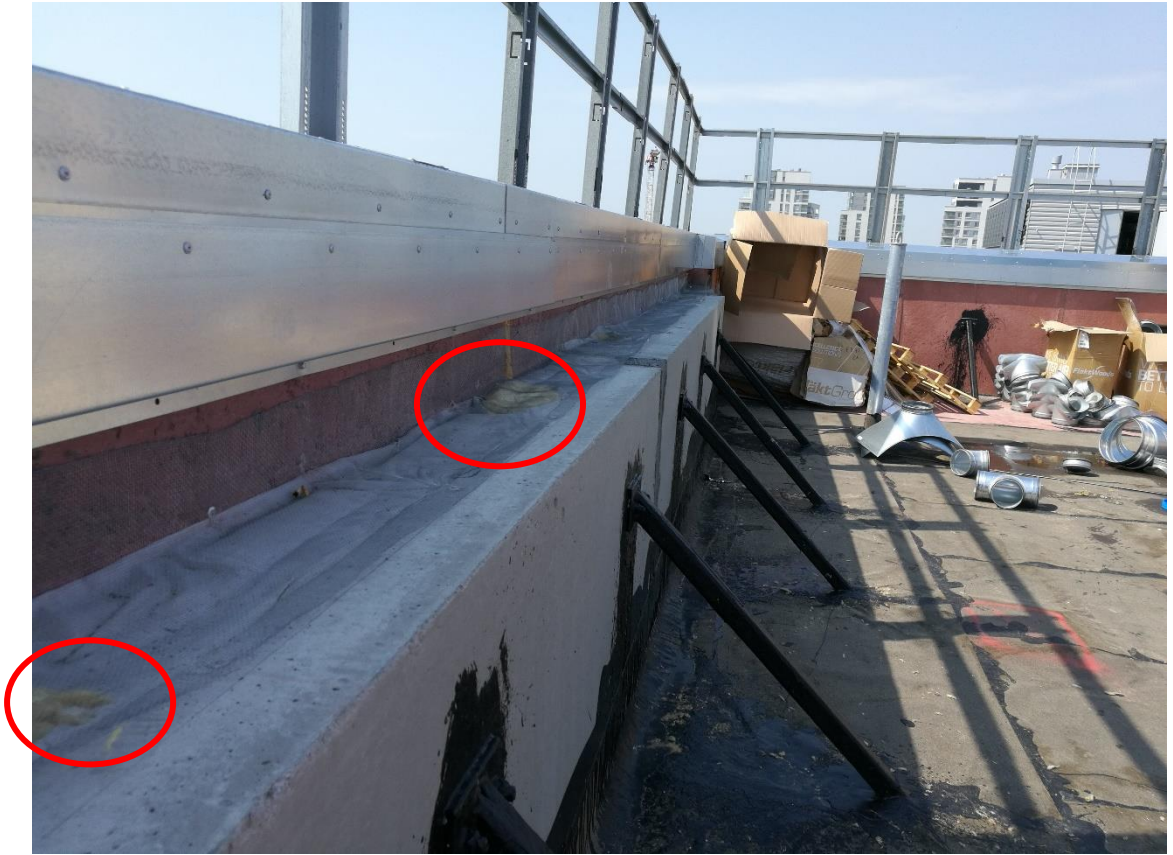
Kuva 4. Elementtien yläpäissä nostolenkkien kohdalla tyvek-kangas ei suojaa eristevillaa kastumiselta.
