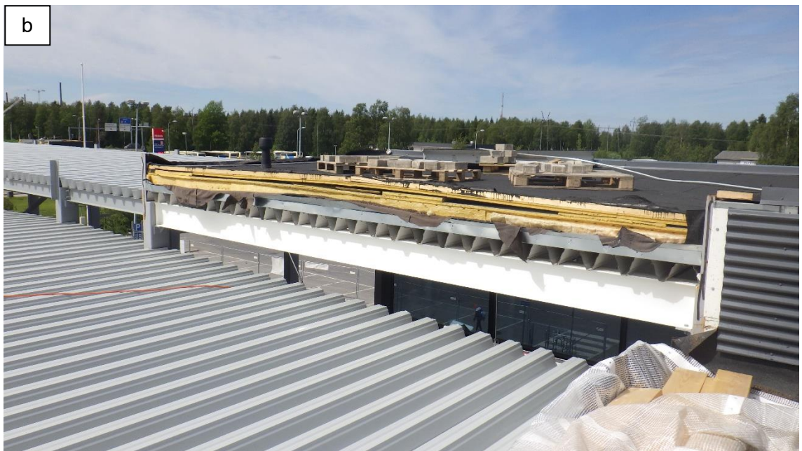
Kuvat 5 a ja b. Uuden ja vanhan rakennusosan liittymän suojauksessa havaittiin puutteita. Vanhan kattorakenteen eristeitä on suojaamatta ja sadevesi pääsee valumaan pitkiäkin matkoja avoimesta rakenneliittymästä rakenteen sisään.
