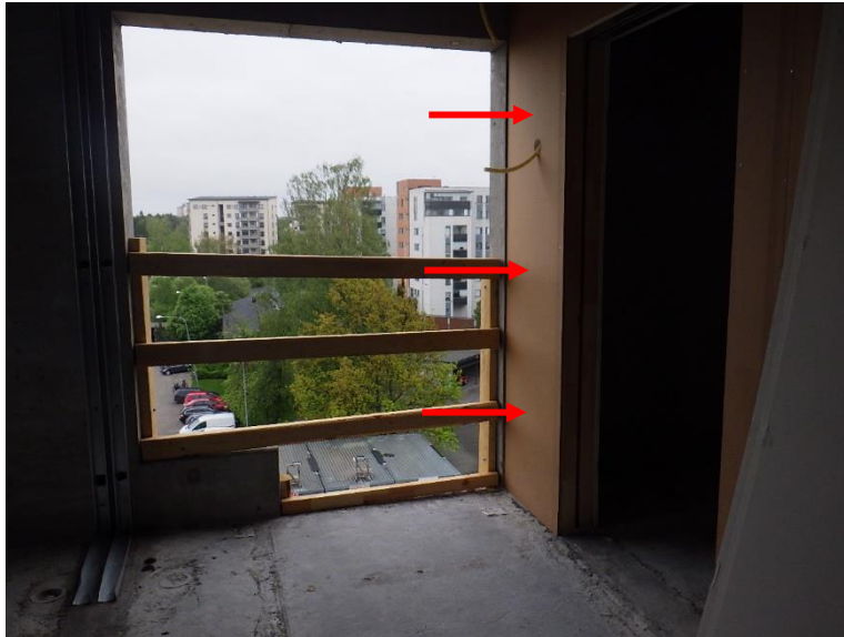
Kuva 5. Osa Ikkunoista oli katselmuksen aikana suojaamatta. Valmiiden kipsiseiniäen kastumista tulee välttää. Mahdollisesti kastuneet kipsilevyt tulee vaihtaa uusiin ja huolehtia aukkojen suojauksesta.
