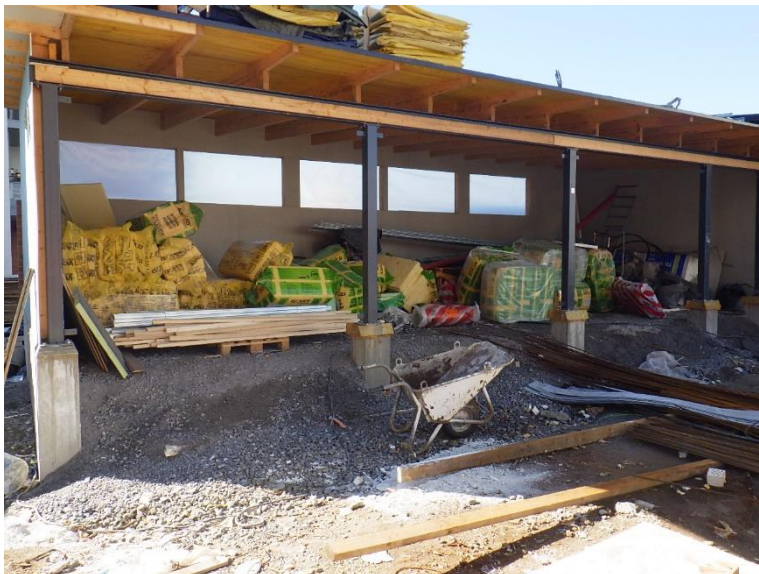
Kuvat 6. Osa materiaaleista on varastoitu pihakatokseen. Materiaaleilla ei ole erillistä suojapeitettä ja osa materiaaleista ei ole nostettu irti maanpinnasta.
