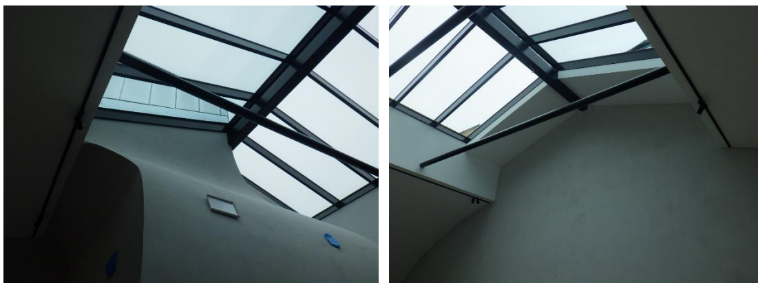
Kuva 2. Vastaavan työnjohtajan mukaan erityisiä haasteita aiheuttivat vaikean vesikattorakenteen lasitetun osan liittymät muihin kattorakenteisiin.
