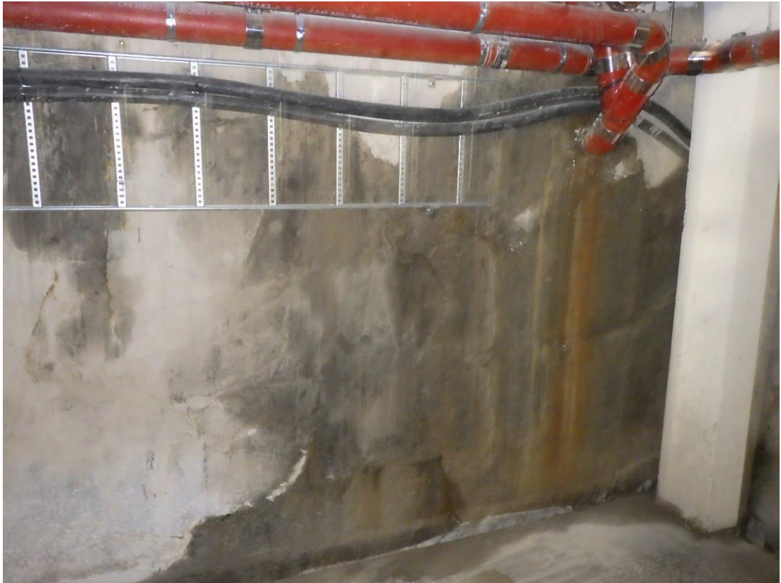
Kuva 4. Rakennuksen alle tehdyn autohallin betoniseinissä on kosteusjälkiä. Kosteusjälkiä on seinässä useamman metrin alueella, mutta suurimmat kosteusjäljet ovat valurautaviemärin ympärillä.
