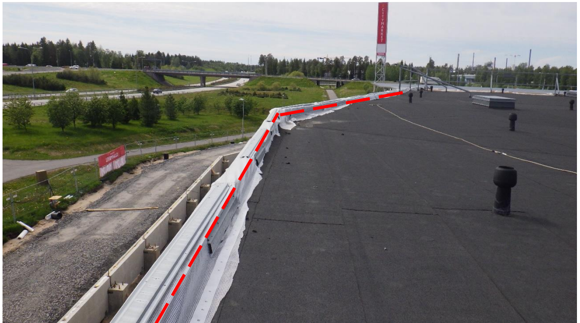
Kuva 3. Työnjohtajan kertoman purettavalta seinän osalta purkutyöntekijä oli poistanut pelti-villa-pelti-elementtien yläosan suojapellin, mutta oli jättänyt avoimen rakenteen suojaamatta. Katselmuksen aikana elementtien yläosa oli suojattu muovikaistalla.
