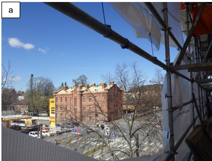
Kuva 5. Sääsuojassa on paikoin pressuun tehtyjä nostoaukkoja, joita tuuli on repinyt auki. Edeltävällä viikolla sääsuojan sisään oli tuiskuttanut lunta. Katselmuksen yhteydessä sääsuojan todettiin tuulettuvan hyvin ja ilman suhteellinen kosteus sääsuojan sisällä on pysynyt matalana.
