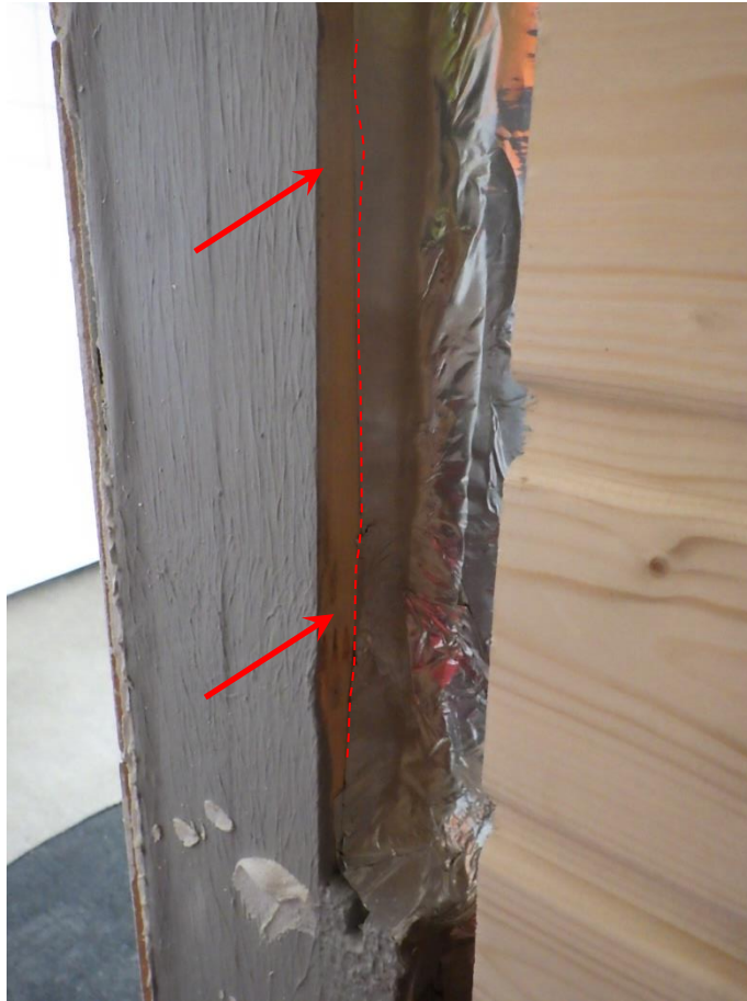
Kuva 5. Vedeneristeen ja saunan höyrynsulun liitoksessa on puutteita karmin kohdalla. Vedeneriste ei limity höyrynsulun päälle vaan osa karmista on paljaalla puupinnalla. Höyrynsulun päätyminen on merkattu kuvaan punaisella katkoviivalla.
