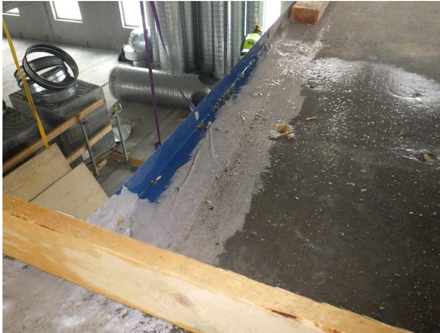
Kuva 7. Holvin reunalta valuvan veden pääsy alempiin kerroksiin on estetty L-profiililla ja vedeneristyskaistalla.
