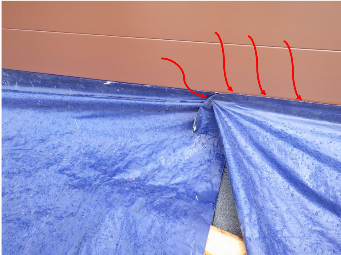
Kuva 4. Vesi pääsee kovemmalla sateella mahdollisesti uittamaan pressun yläreunan kautta rakenteen sisään. Pressu pääsee melko vapaasti liikkumaan tuulen mukana.
