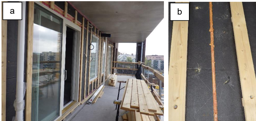
Kuva 6. Työnjohtajan kertoman mukaan kahdeksannessa kerroksessa vesi oli päässyt tuulen vaikutuksesta vaipan sisäpuolelle, jossa maalipintaa oli jouduttu uusimaan. Veden arveltiin päässeen vaipan sisäpuolelle PUR-eristeen liitoskohdasta. Rakennus sijaitsee tuulisella paikalla.
