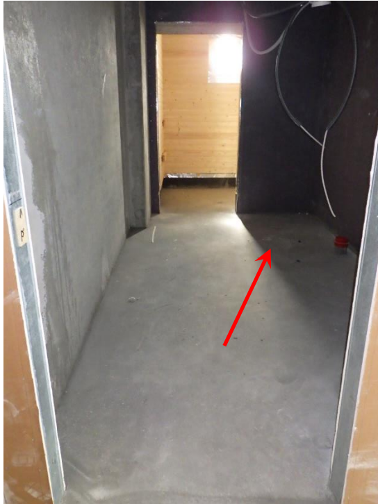
Kuva 7. Pitkässä kylpyhuoneessa lattiakaivon sijainti on suihkunurkassa (merkitty kuvaan punaisella nuolella). Kallistusten toteuttaminen RT-kortin mukaisesti on erittäin haastavaa, sillä lattiakoron tulisi kylpyhuoneen kynnyksen kohdalla olla useita senttimetrejä korkeammalla, kuin kaivon kohdalla. Kallistuksissa suositellaan 1:50 kallistusta suihkun alueella ja 1:80 kallistusta muulla alueella.
