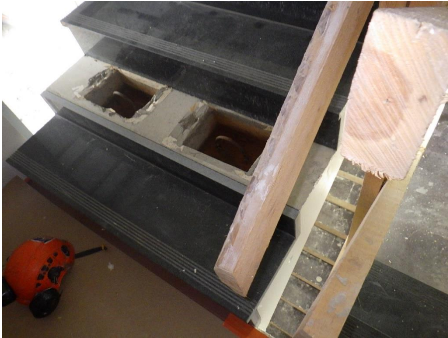
Kuva 4. Porraselementin nostokoukkujen kaukaloihin oli vielä jäänyt muutama litra vettä.
