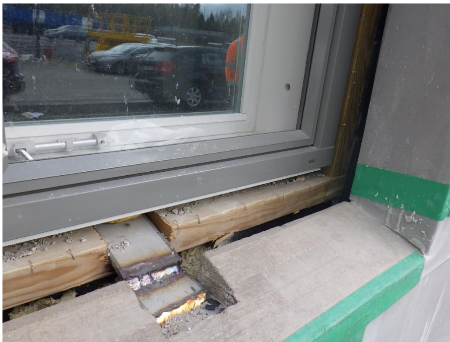
Kuva 6. Ikkunoiden peltityöt ovat kesken. Ikkunoiden työnaikaisessa suojauksessa tulisi estää veden pääsy apukarmeihin ja tuuletusväliin.
