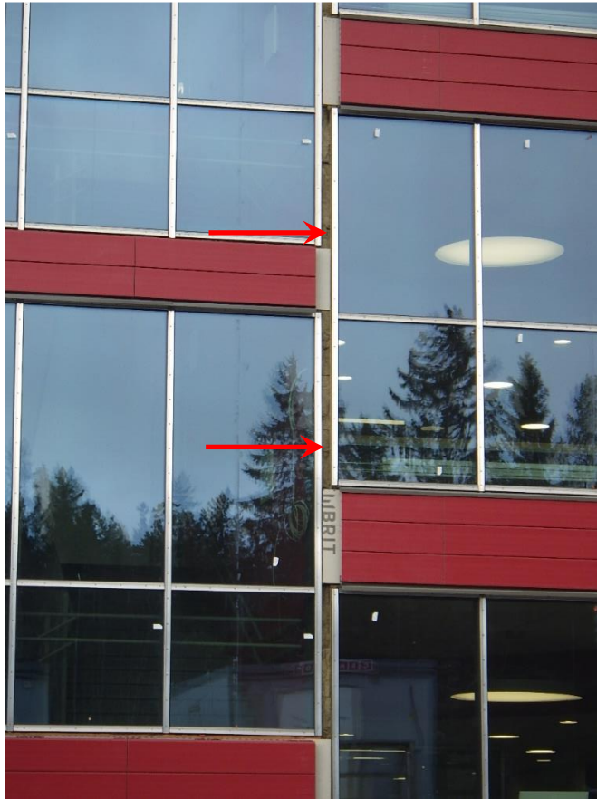
Kuva 7. Julkisivulla on suojaamaton villakaista ikkunoiden välissä.
