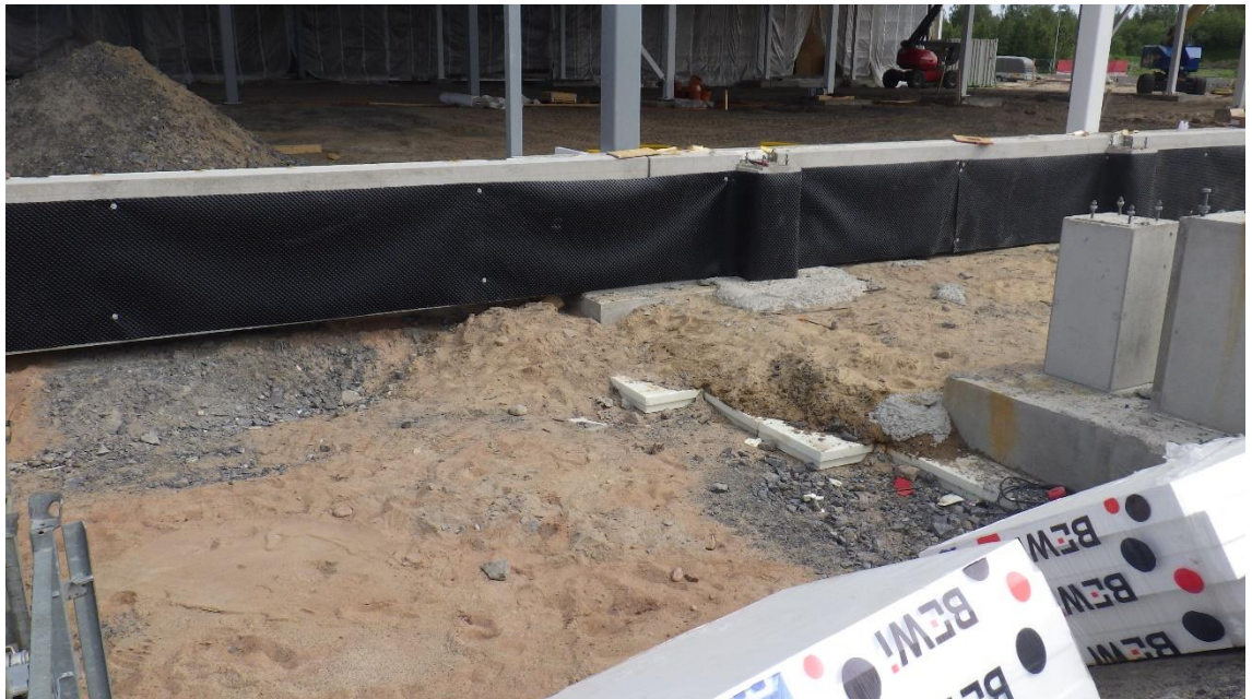
Kuva 7. Kapillaarisen nousun katkaisevan sepelin ja hienompijakoisen maa-aineksen välissä ei ole käytetty suodatinkangasta. Hienojakoinen maa-aines on päässyt sekoittumaan sepeliin.
