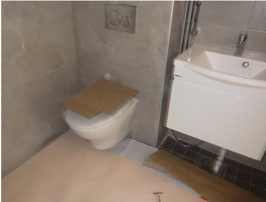
Kuva 2. Suunnitelmien detajjikka märkätilojen seinään kiinnitettävien WC-istuimien toteutuksesta on ollut puutteellinen. Vedeneristyksestä nurkan kotelon osalta suunnitelmien ohjeistus oli puutteellinen.
