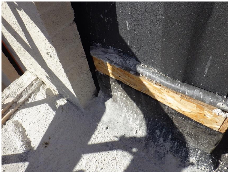
Kuvat 3. Suunnitelmien detajjikka muurattujen rakenteiden, kermien ja levytysten liittymäkohdissa on puutteellista.
