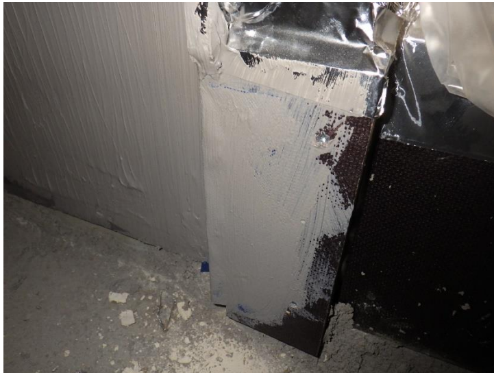
Kuva 8. Lattiaa ei ole vielä vedeneristetty, mutta katselmuksen aikana vedeneristeen ja höyrynsulun liitoksessa saunan ja kylpyhuoneen väliseinän kohdalla on aistinvaraisesti tarkasteltuna tiiveyspuutteita ja vedeneristekerros on paikoin ohuehko. Vedeneristeen kalvopaksuuden tulisi toteutua myös liittymien osalta.
