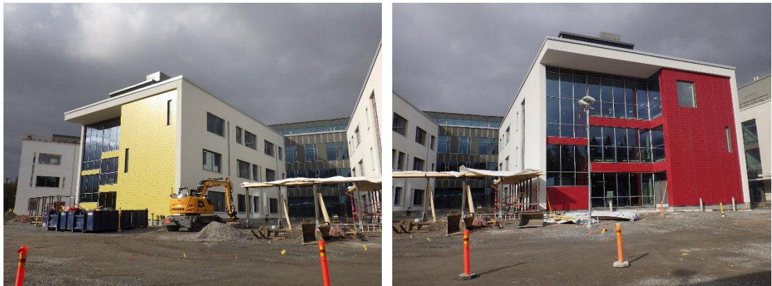
Kuvat 1 a ja b. Kerrostalojen ulkovaipat ovat ummessa. Uuden ja vanhan rakennussiiven raja menee kuvassa b. olevan rakennussiiven oikealla puolella.
