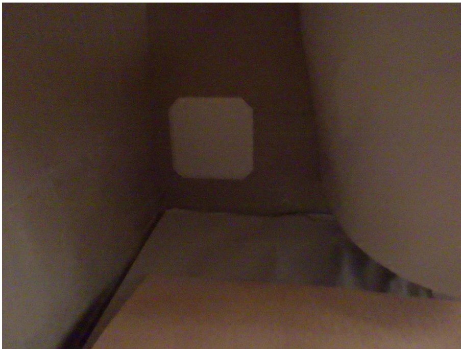
Kuva 3. WC-istuimen vieressä oleva tarkastusluukku on sijoitettu vaikeaan paikkaan ja luukku on kooltaan pieni.
