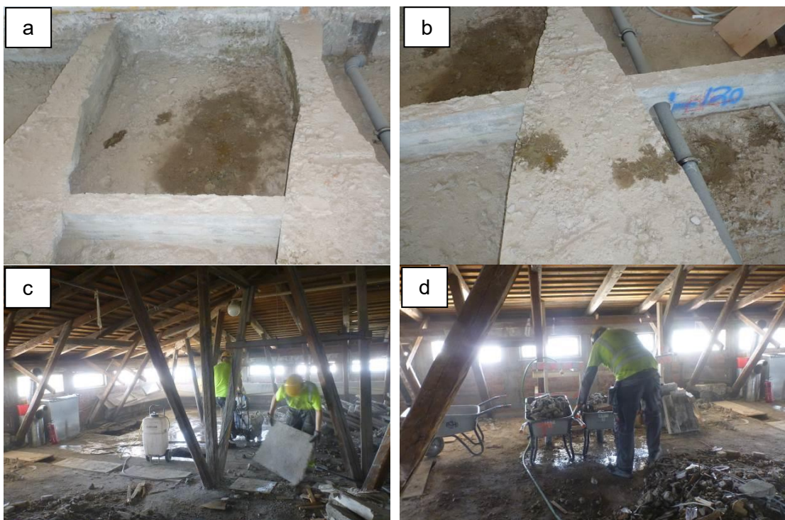
Kuvat 3 a...d. Viidennessä kerroksessa (kuvat a ja b) havaittiin välipohjan pinnalla kosteusjälkiä/lätäköitä ja vettä tihkui paikoin yläpohjan alalaatan läpi. Ullakolla (kuvat c ja d) oli käynnissä palopermannon purkuun liittyvä timanttisahausvaihe, mutta varsinaisia jäähdytysvesien talteenotto-/hallintajärjestelyjä ei havaittu
