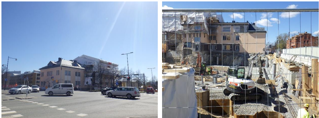
Kuvat 1 a ja b. Tontin saneerausosalla on menossa purku- ja vesikattotyöt. Uudisrakentamisosalla tehdään perustustöitä.
