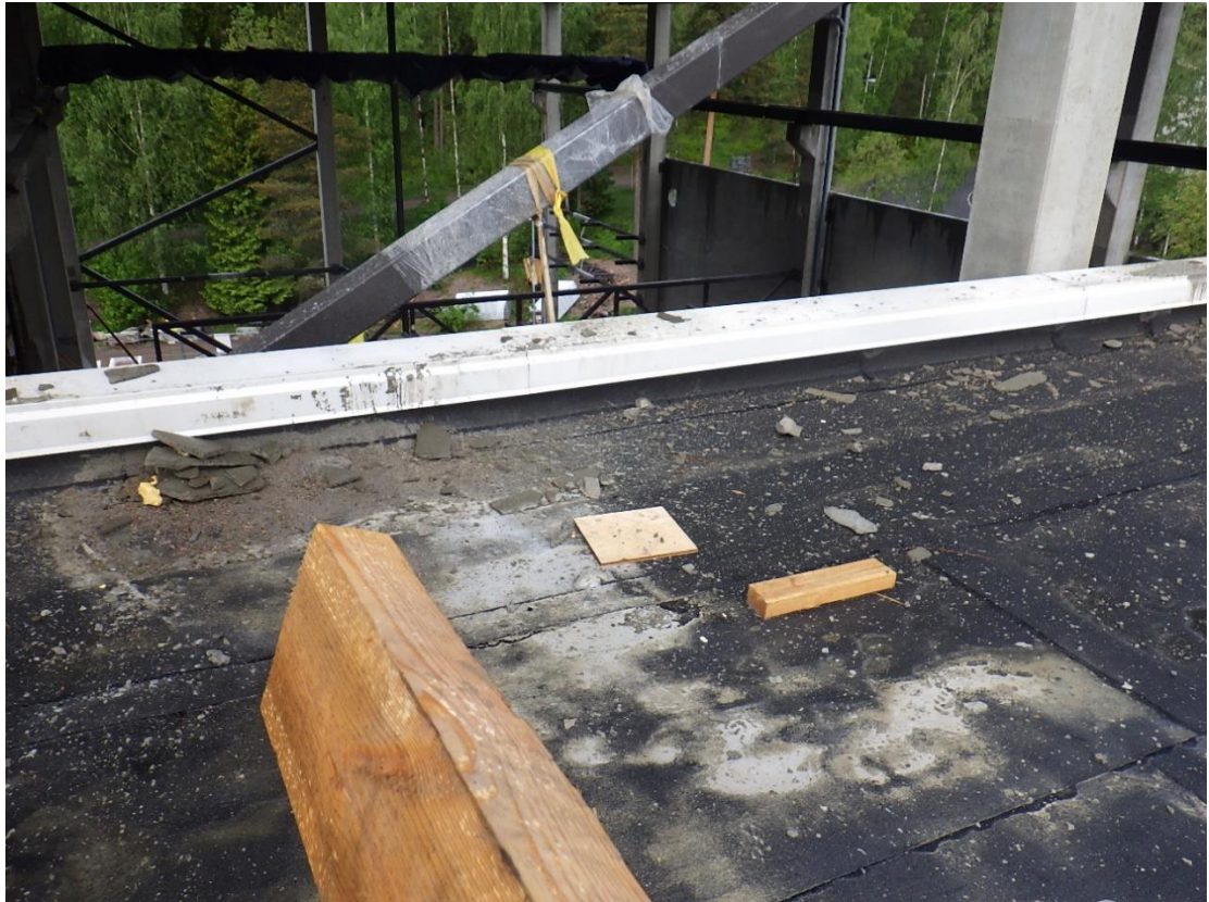
Kuvat 5. Työn aikaista rakennusjätettä (pultteja, laastimuruja, puutavaraa ym.) on paikoin jäänyt siivoamatta.
