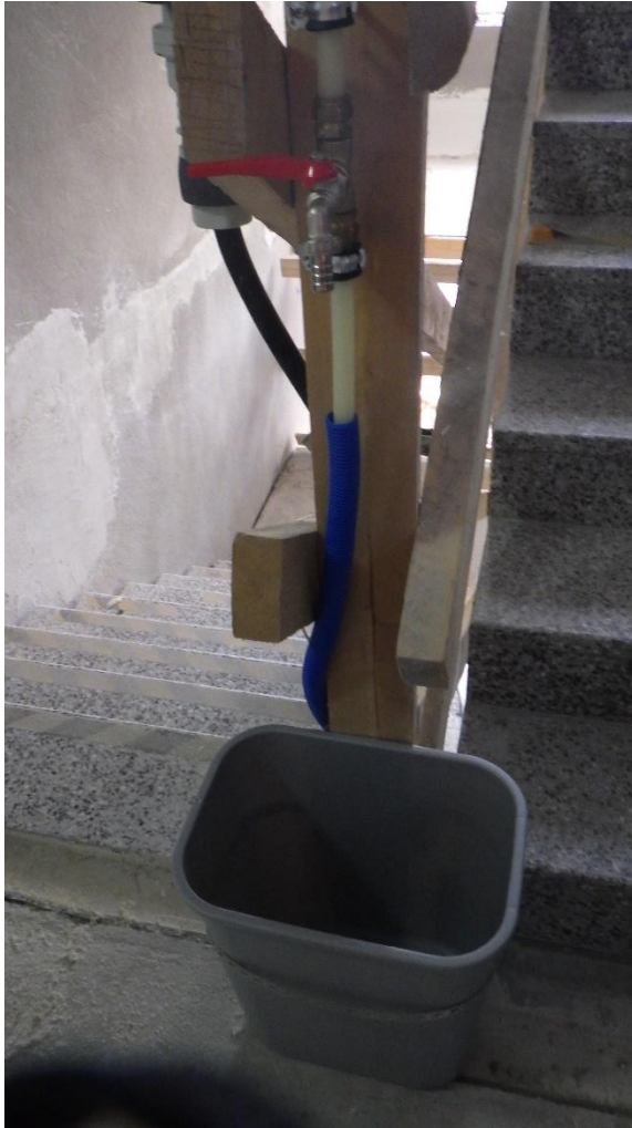
Kuva 5. Vesipisteiden vuotoallas on kiinnitetty reikävanteella kiinni kaiteeseen. Useasta kerroksesta vastaava vuotoallas oli otettu muuhun käyttöön tai puuttui kokonaan.
