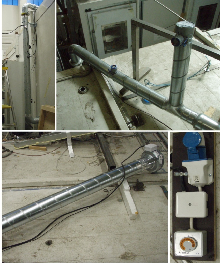
Kuva 15. Mittauslaitteiston poistoilmaputki, virtaussäätimet, piippu, poistoilmapuhallin ja sen tehon säädin. (Linnainmaa et al. 2019)
