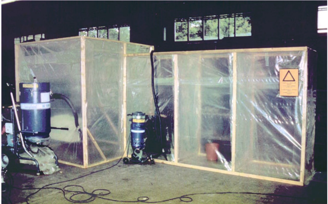
Kuva 1. Osastointi, jossa on kolme sulkua, varoituskilpi, alipaineistaja ja imuri kohdepoistolle. (RT 18-11248 2016)
