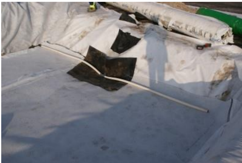
DSC05103 Pintakerroksen vedet keräävä salaojaputki
