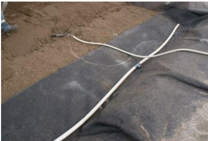
DSC04692 Kasvukerroksen vedet keräävä salaojaputki
