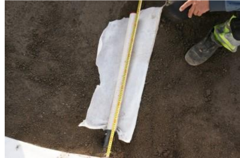
DSC05100 Vedet salaojamaton alta keräävä salaojaputki
