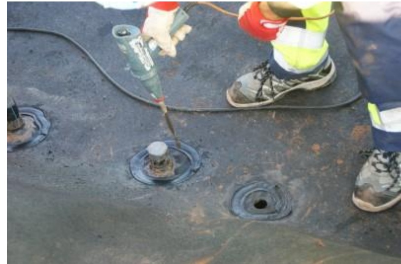
DSC04508 Läpiviennin ekstruusiosauaman kipinäkoe
