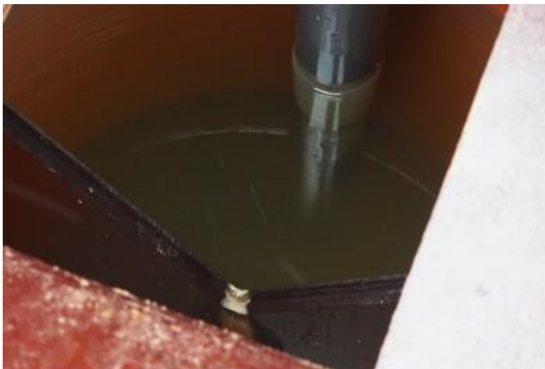
P4091283 Koekentän U.1 v-kaivo, v-aukossa sakkaa?
