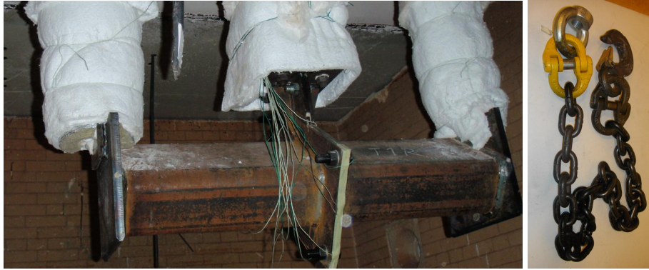
Kuva 2.4. Palovillalla suojatut nostoketjut ja keskituki sekä nostoketju
