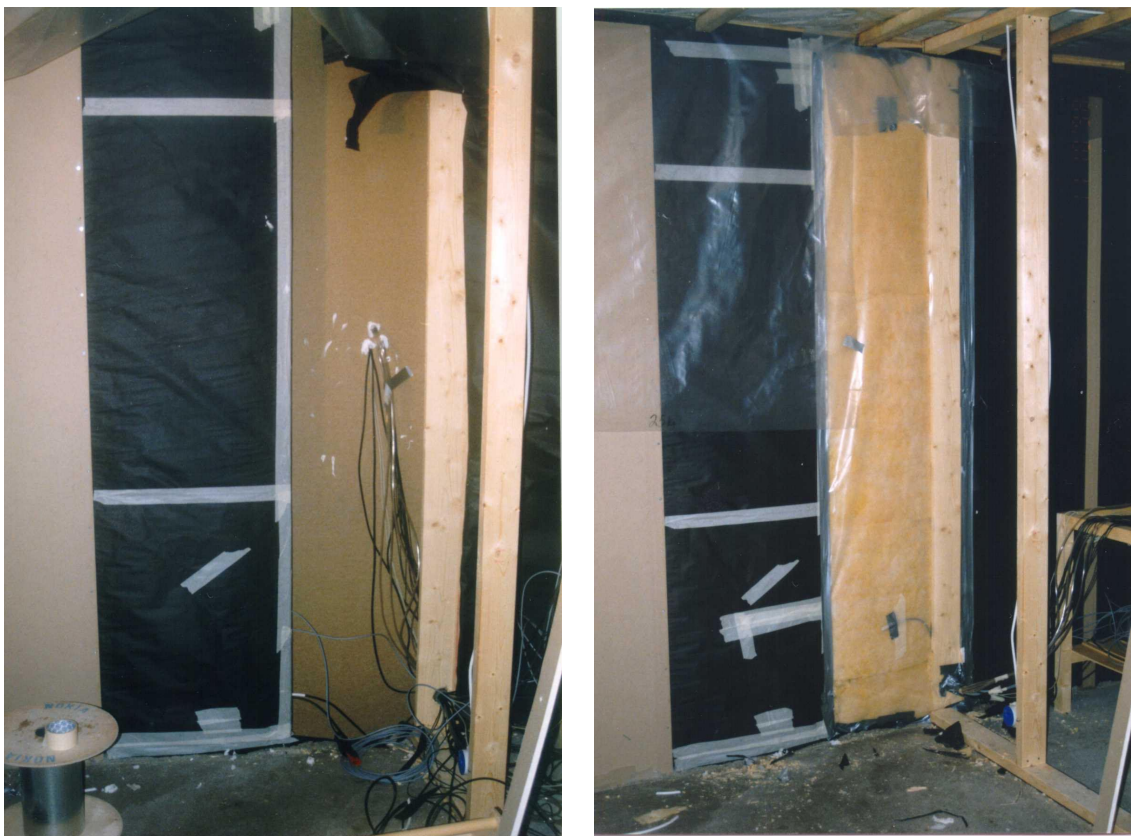
Kuva 3.5. Anturien asennuksen aikaisia kuvia 10.11.-98. Vasemman puoleisessa kuvassa näkyy anturien läpiviennit ulos ja sektoriin 2. Oikean puoleisessa kuvassa näkyy sektoriin 1 asennettu mineraalivilla ja höyrynsulkumuovi. Bitumipaperissa olleet reiät paikattiin teippaamalla. Taustalla näkyy hieman myös vaatehuonetta (väliseinä puuttuu), jonne mittauskalusto sijoitettiin. Mittauksen päätyttyä höyrynsulkumuovin ja mineraalivillan tilalle vaihdettiin takaisin bitumipaperi ja levymäinen puukuitueriste.
