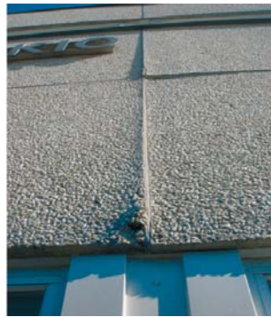
KUVA (Jukka Lahdensivu): Laaja-alaisia pakkasvaurioita on yleisesti melko vähän. Tyypillisesti pakkasrapautumaa esiintyy elementtien reunoissa.
