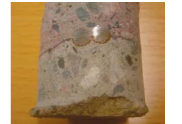
KUVA (Jukka Lahdensivu): Parvekelaattojen alapinnassa betonin karbonatisoituminen on saavuttanut raudoitteita erittäin laajasti. Korroosioauriot ovat siihen nähden varsin vähäisiä.
