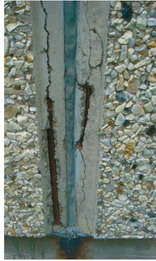
KUVA (Jukka Lahdensivu): Tyypillisimminkin korroosioaurioita esiintyy elementtien sellaisten pieliterästen kohdilla, joissa peitepaksuudet ovat pieniä ja saderasitus suurta.
