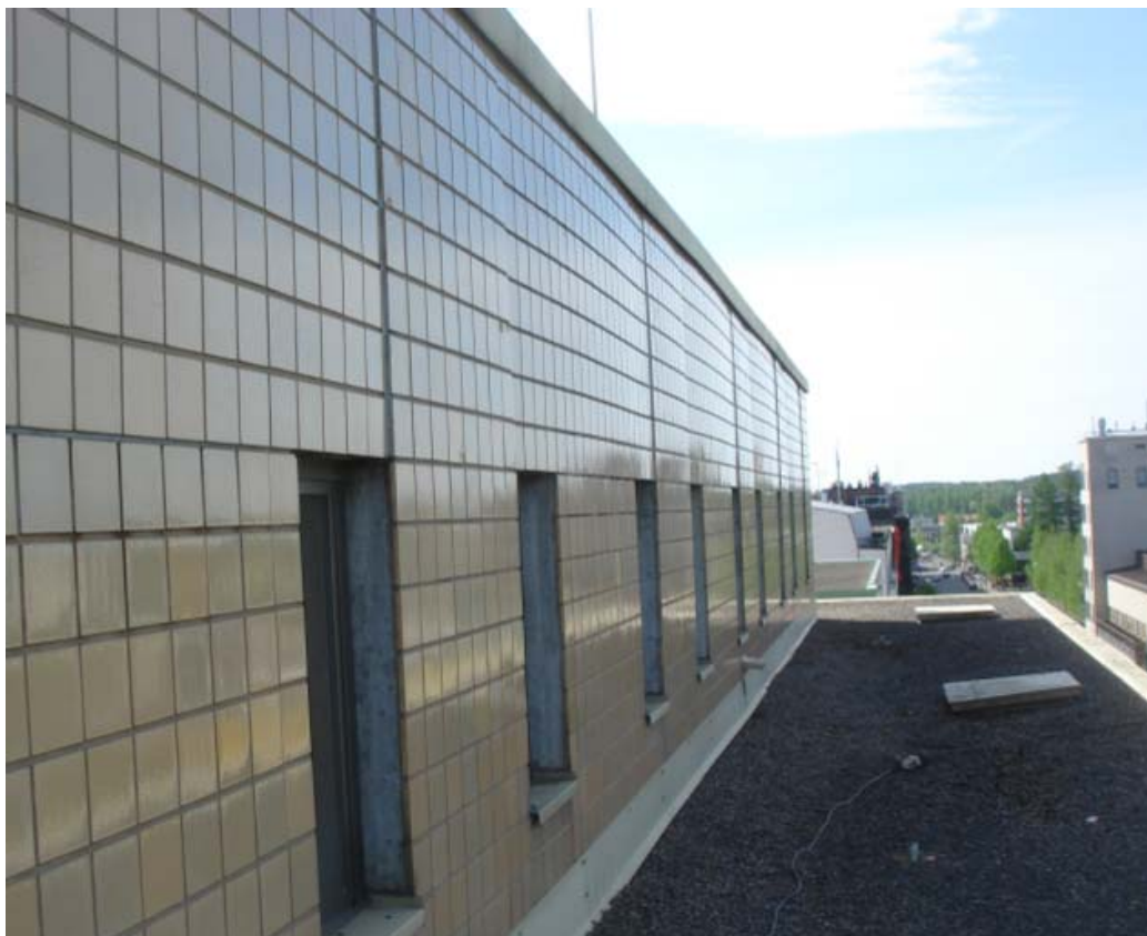
Kuva 3.16 Klinkkerilaattapintaisen kuorielementin voimakas kaareutuminen on yleensä merkki estetystä betonin kutistumasta. Yleensä kiinnitysvarmuus on riittävä, mikäli kiinnikkeet ovat ruostumatonta terästä eikä betonissa esiinny pakkasrapautumaa. Pintatarvikkeellisissa julkisivuissa, kuten tässä kuvassa ilmenevä kutistumaeroista johtuva kaareutuminen on varsin yleistä.
