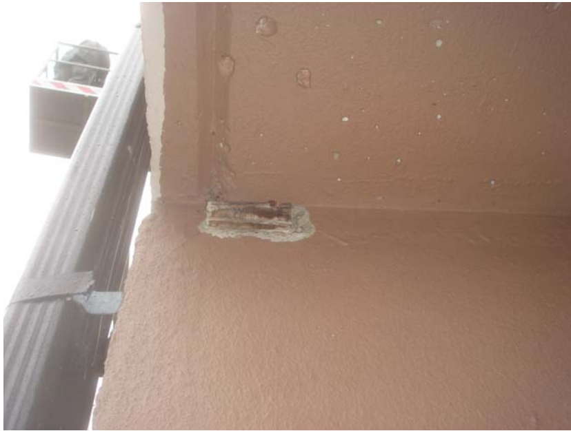
Kuva 3.18 Tyypillinen elementin asennuspalan aiheuttama vaurio parvekelaatan ja –pielen laastisaumassa.
