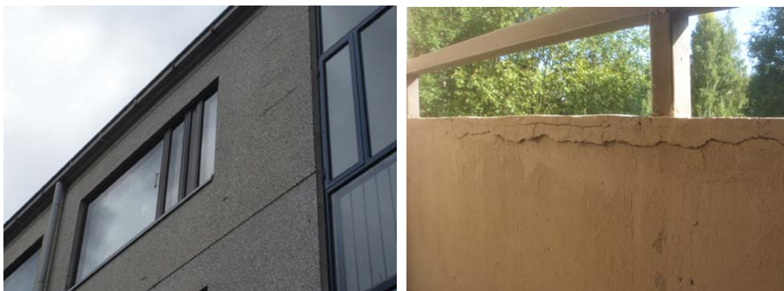
Kuva 3.21 Paikallisia raudotteiden korroosioaurioita betonijulkisivussa ja parvekekaiteessa. Korroosiotuotteiden suurempi tilavuus on aiheuttanut betoniin sen vetolujuutta suuremman sisäisen jännityksen, jolloin ohut betonipeite on rikkoutunut.
