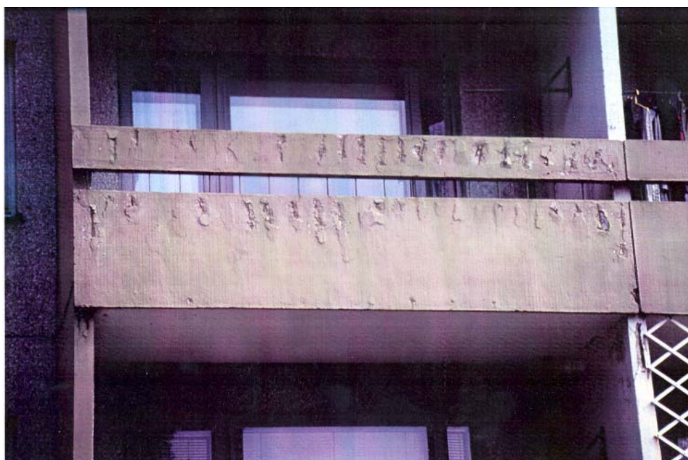
Kuva 3.13 Laaja-alaista karbonatisoitumisen aiheuttamaa raudoitteiden korroosiota kaideelementissä. Raudoitteiden peitepaksuudet ovat < 5 mm kyseisissä vauriokohdissa.
