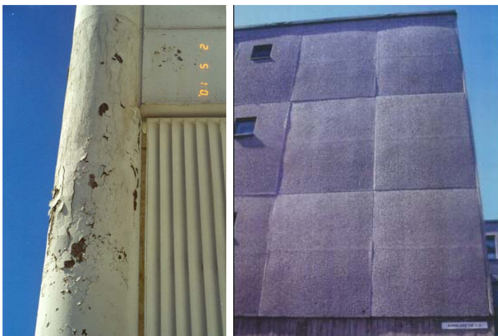
Kuva 3.22 Pitkälle edennyttä ja laaja-alaista betonin pakkasrapautumaa parvekkeen pilarissa sekä pesubetonijulkisivussa.
