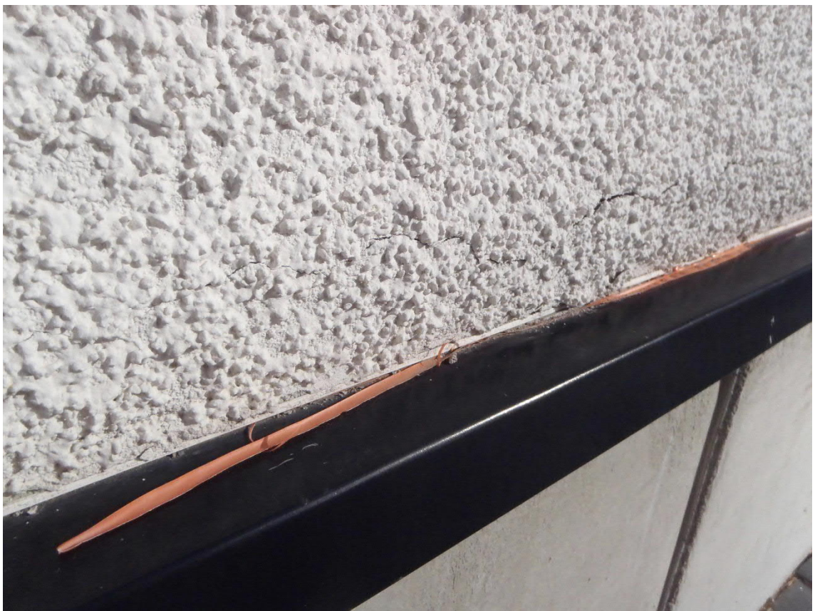
Kuva 28: Rappauksen halkeama vääränlaisen kiinnityksen takia.
