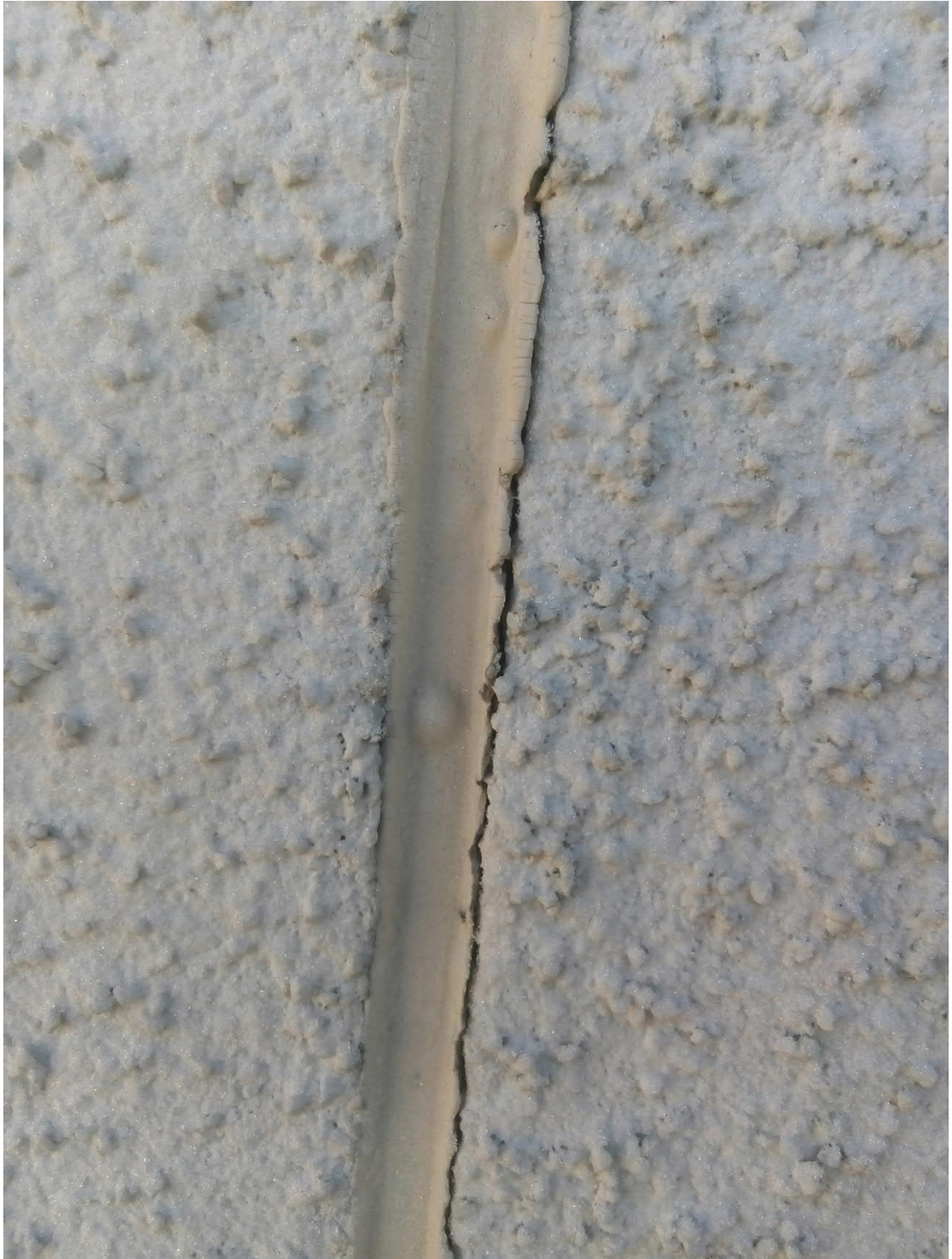
Kuva 17: Elastisen saumausmassan murtuminen silikonihartsipinnoitteesta. Pinnoitteen pinnalla on nähtävissä jäähiutaleita, jotka ovat seurausta julkisivun pintaan kondensoituneesta ulkoilman kosteudesta.
