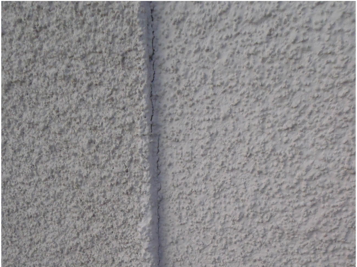
Kuva 23: Rappauksen halkeama rappausalustan vaihtuessa.
