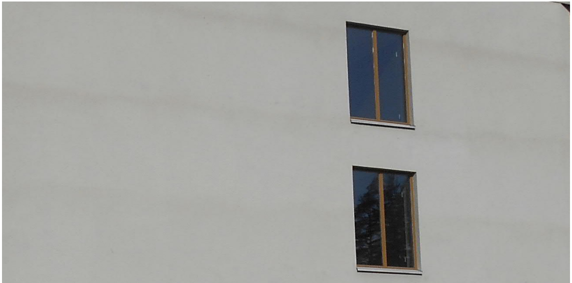
Kuva 6: Julkisivupinnasta erottuu vaakasuuntaiset viirut, jotka ovat syntyneet työntoteutuksessa.
