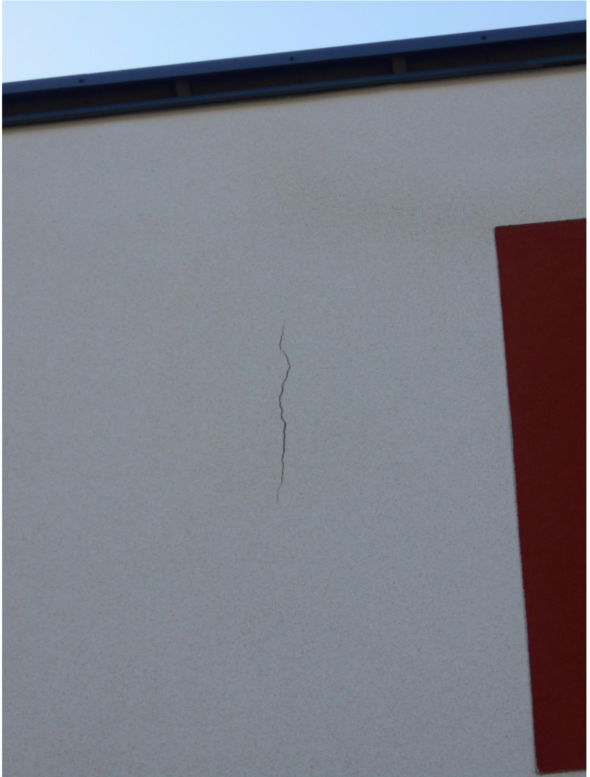
Kuva 25: Leveä halkeama rungon liikuntasauaman kohdalla.
