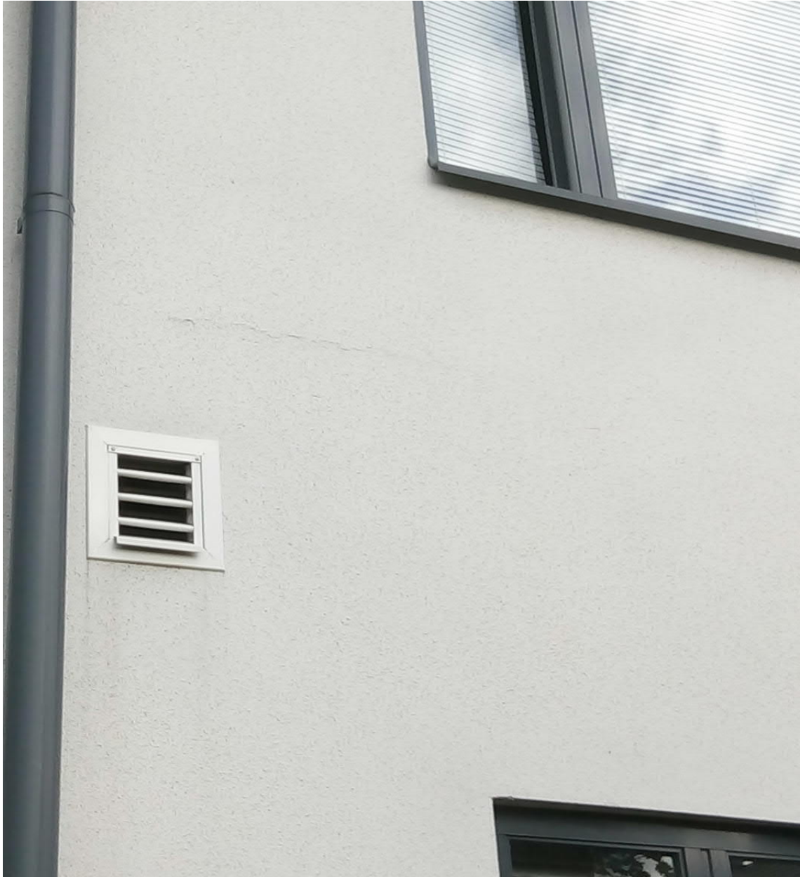
Kuva 21: Rappauksen halkeama elementtisaumassa.
