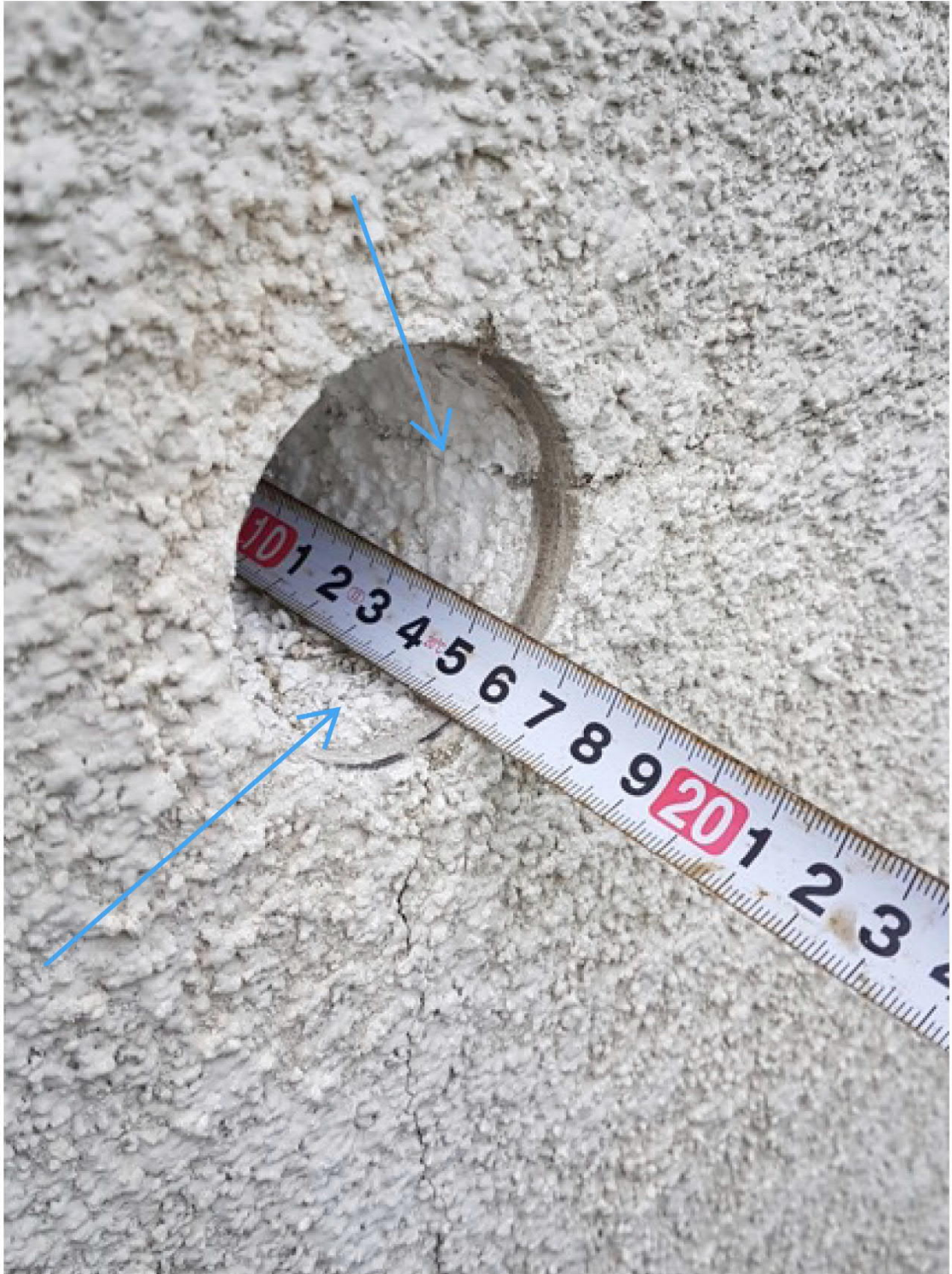
Kuva 22: Rappauksen vaaka- ja pystysuuntaista halkeilua lämmöneristeen saumassa.
