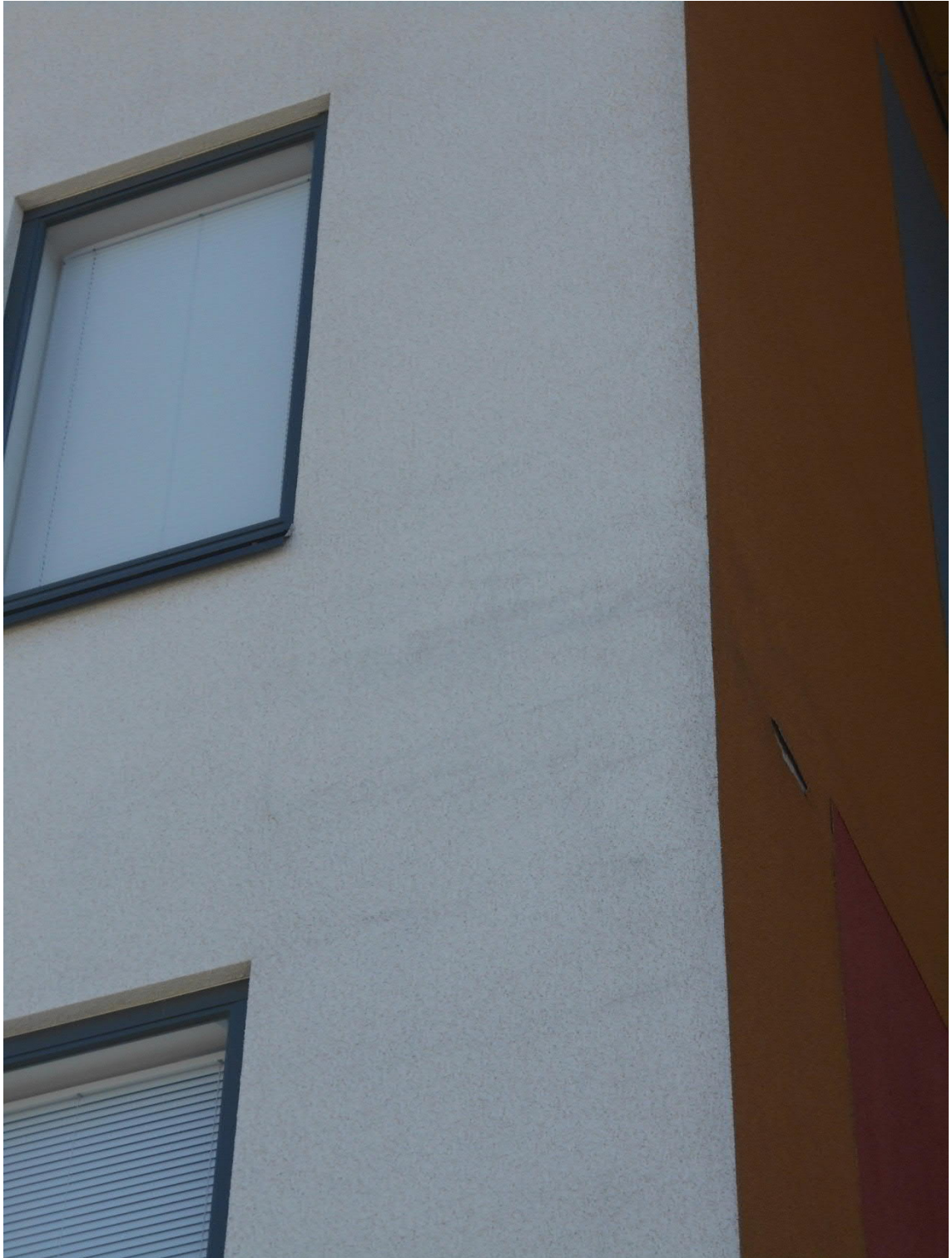
Kuva 29: Rakennuksen ulkokulman halkeilua.
