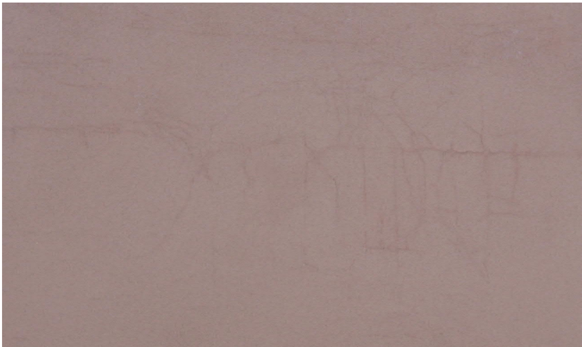
Kuva 32: Rappauksen epäsäännöllistä ja laaja-alaista halkeilua.
