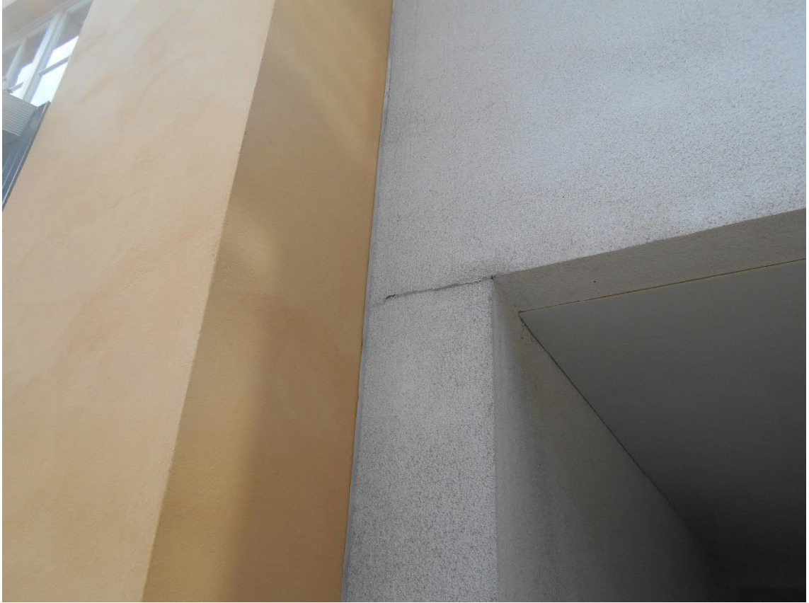
Kuva 20: Rappauksen halkeama kapean kannaksen yläreunassa.
