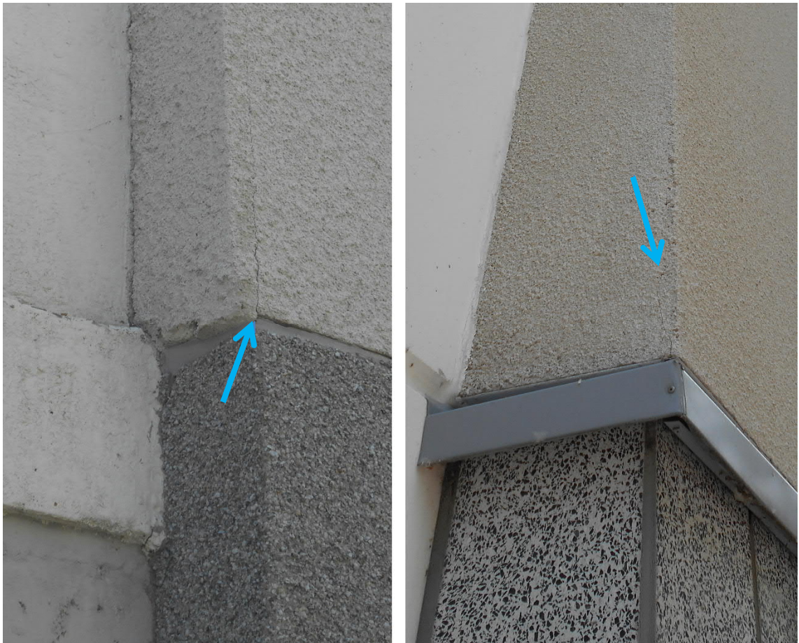
Kuva 41: Julkisivun nurkkiin syntyneitä pystysuuntaisia halkeamia.
