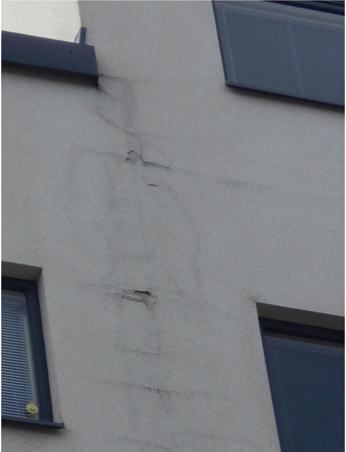
Kuva 35: Rappauksen halkeilua ja pakkasrapautumista julkisivun yläosassa.
