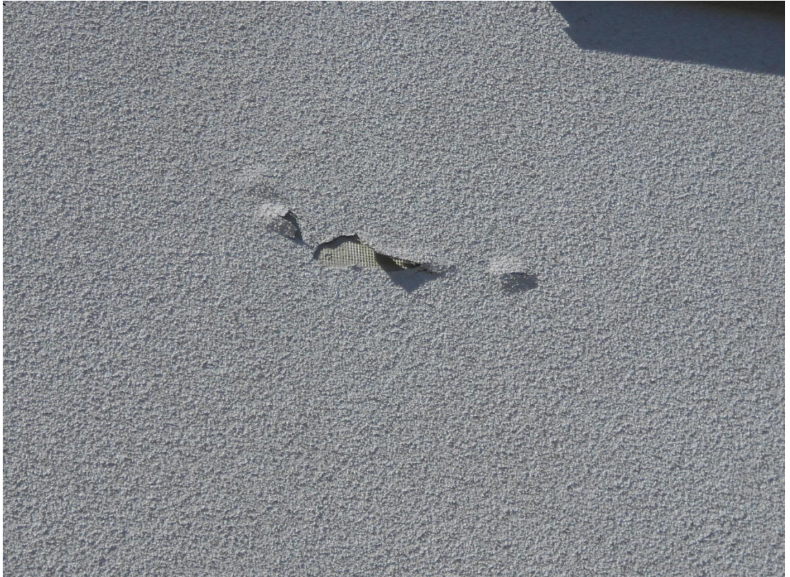
Kuva 34: Rappauksen pitkälle edennyttä pakkasrapautumaa sekä pinnoite ja laastikerosten irtoamista.
