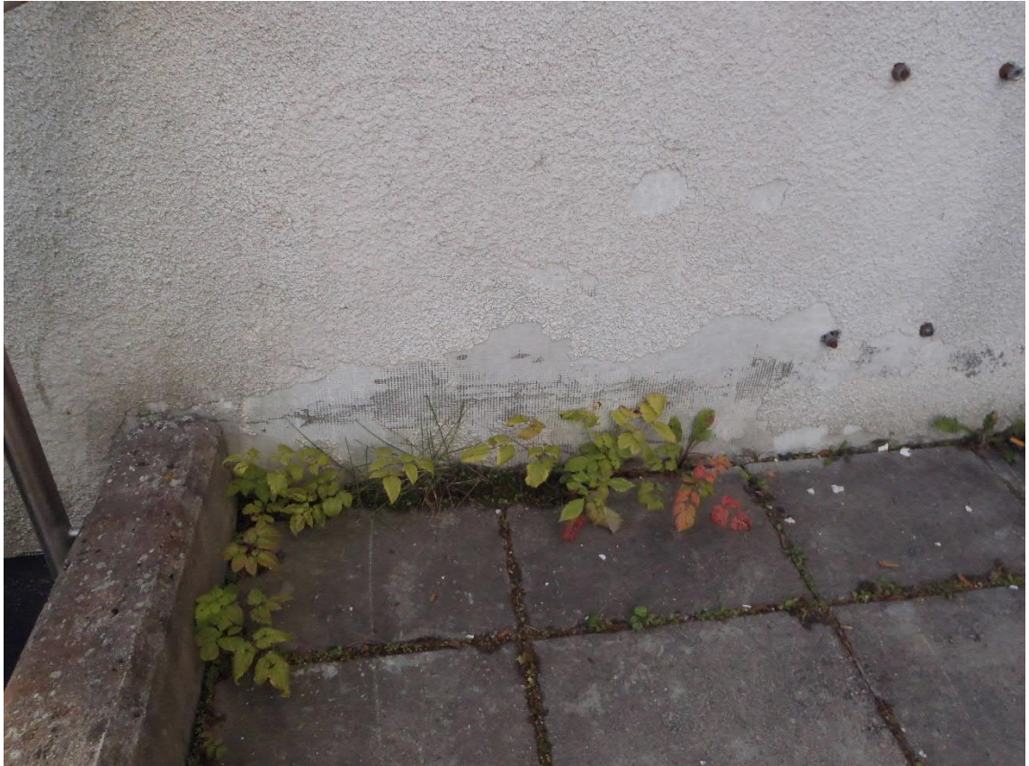
Kuva 36: Rappauksen rapautuminen rappauksen jatkuessa maanpintaan asti.
