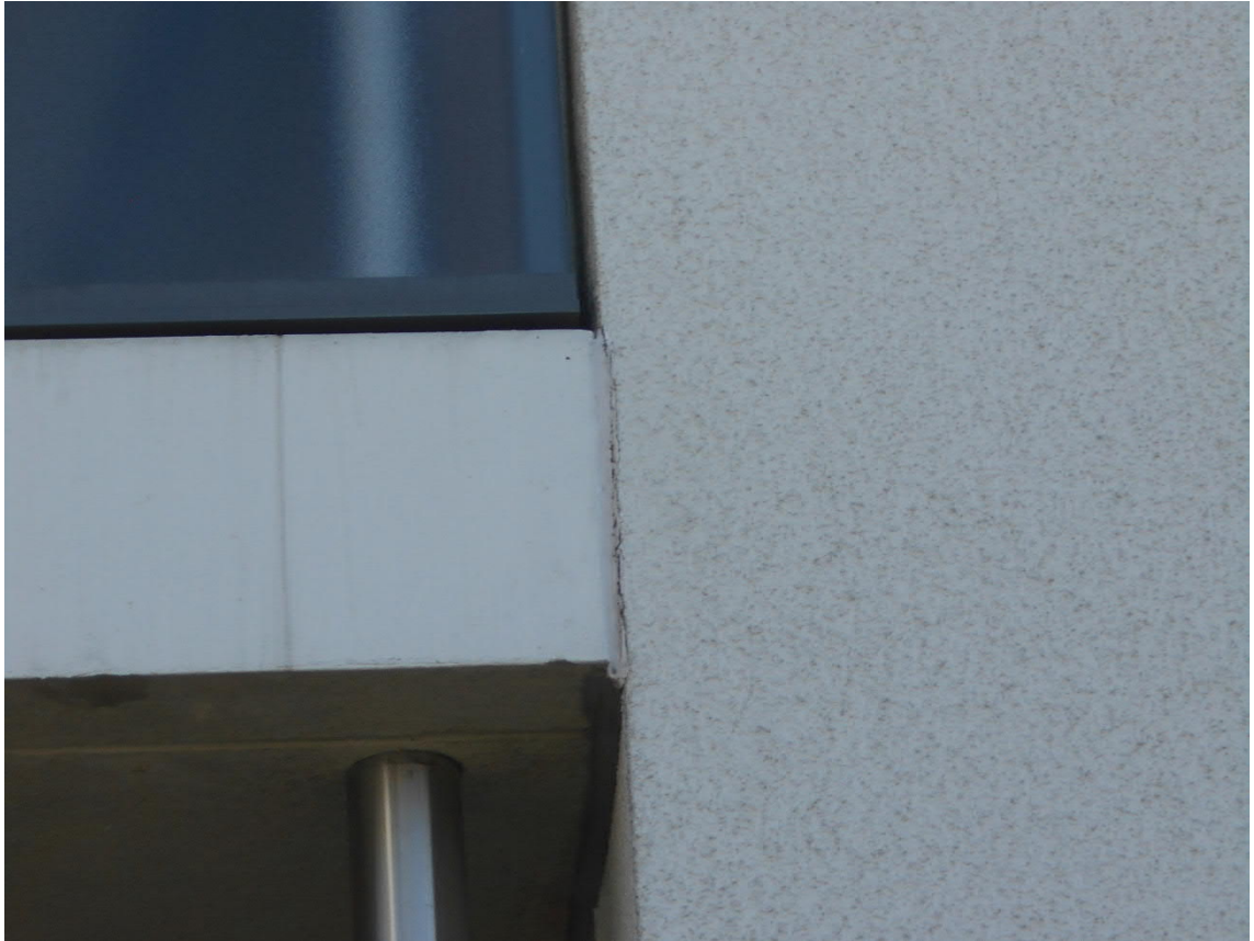
Kuva 26: Rappauksen halkeama parvekelaatan ja rappauksen välisen elastisen saumausmassan vieressä.
