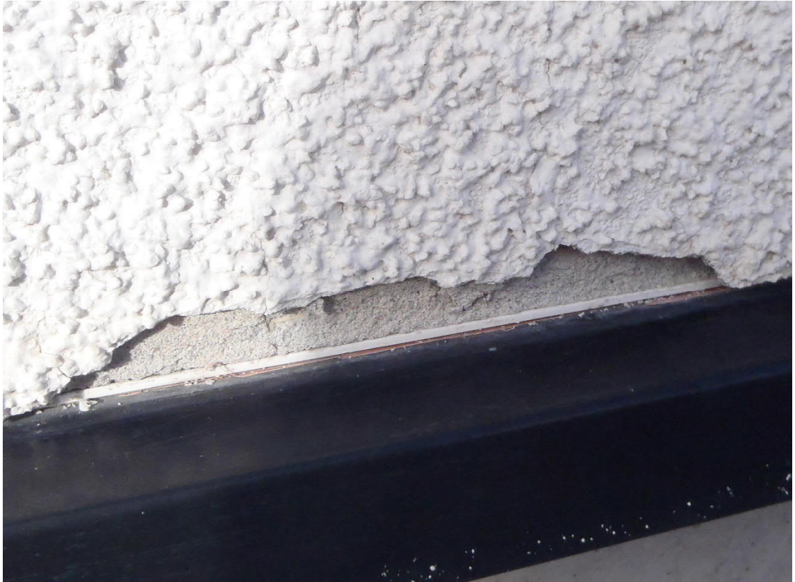
Kuva 37: Rappauksen pakkasrapautumista pellityksen toimivuuspuutteen takia.
