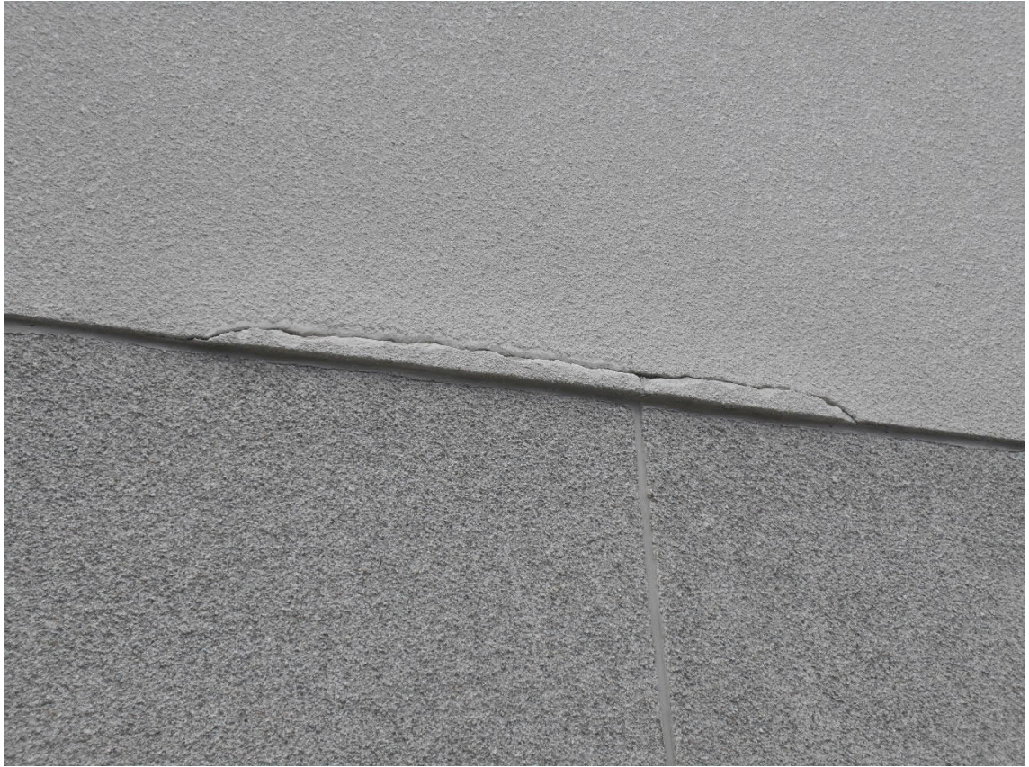
Kuva 42: Rappauksen lohkeama sokkeliliitoksen yläpuolella.
