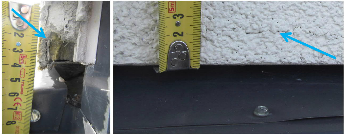
Kuva 27: Rappauksen halkeama sokkeliprofiilin laipan yläreunan kohdalla.
