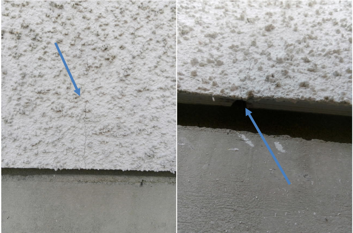
Kuva 31: Rappauksen halkeama sokkeliprofiilin jatkoskohdassa.
