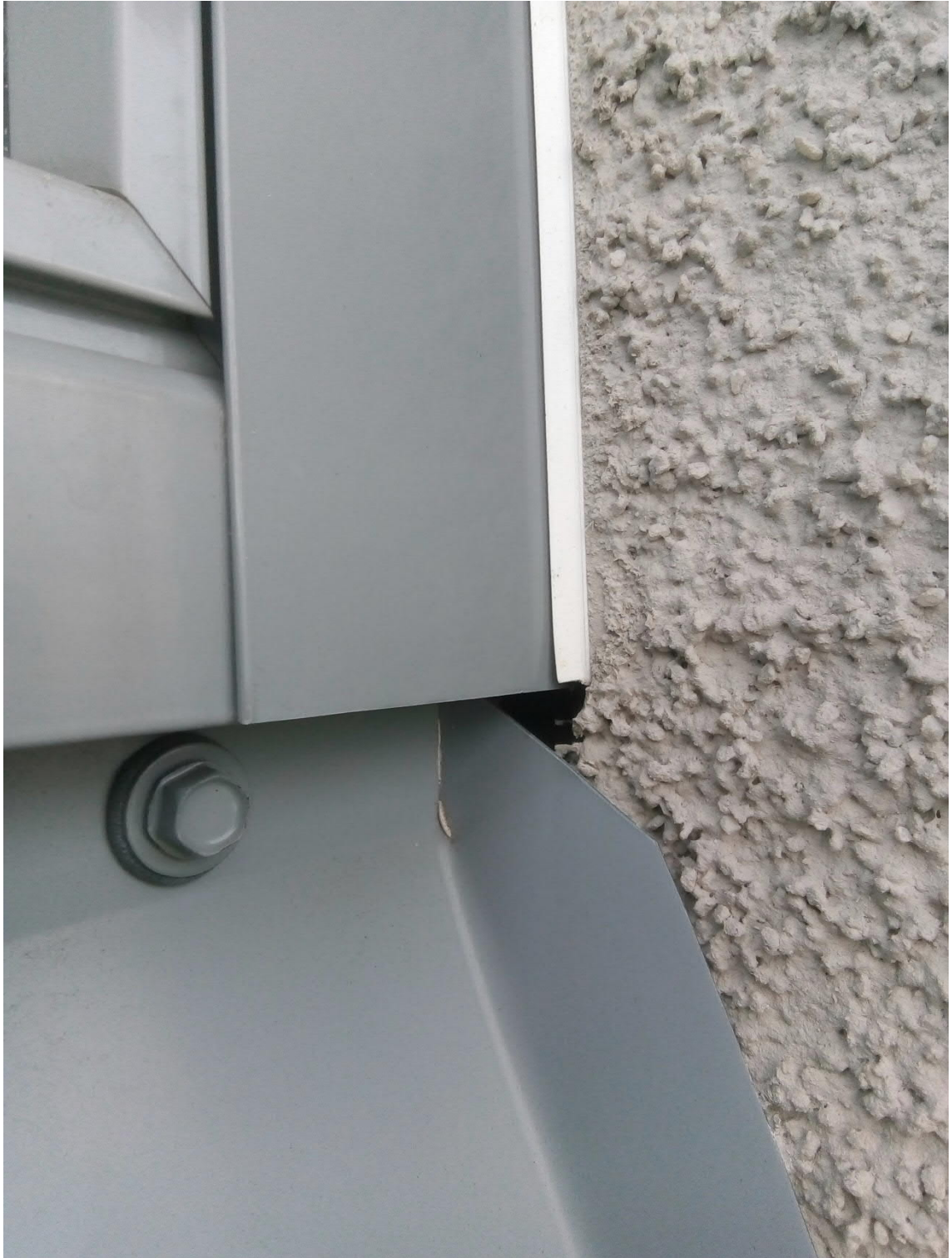
Kuva 14: Vesipellin ja ikkunapielen välissä on rako, josta kosteus pääsee tunkeutumaan rappaukseen.
