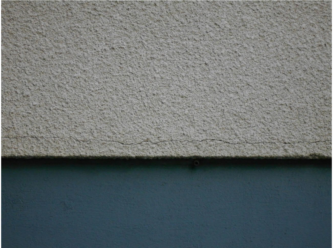
Kuva 43: Rappauksen halkeama sokkeliliitoksen yläpuolella.
