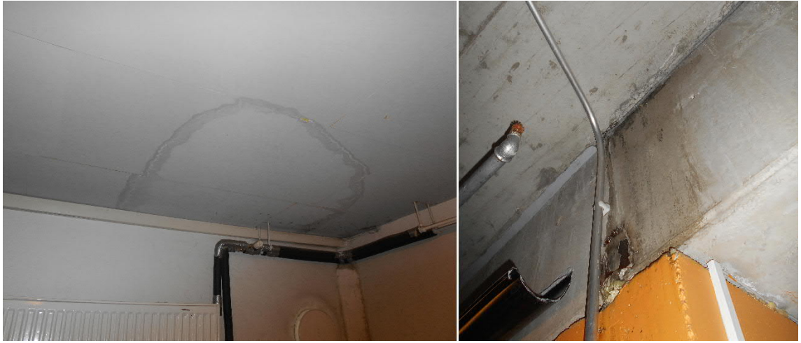
Kuva 40: Kosteuden tunkeutumisesta rakennuksen sisään aiheutuneita valumajälkiä.
