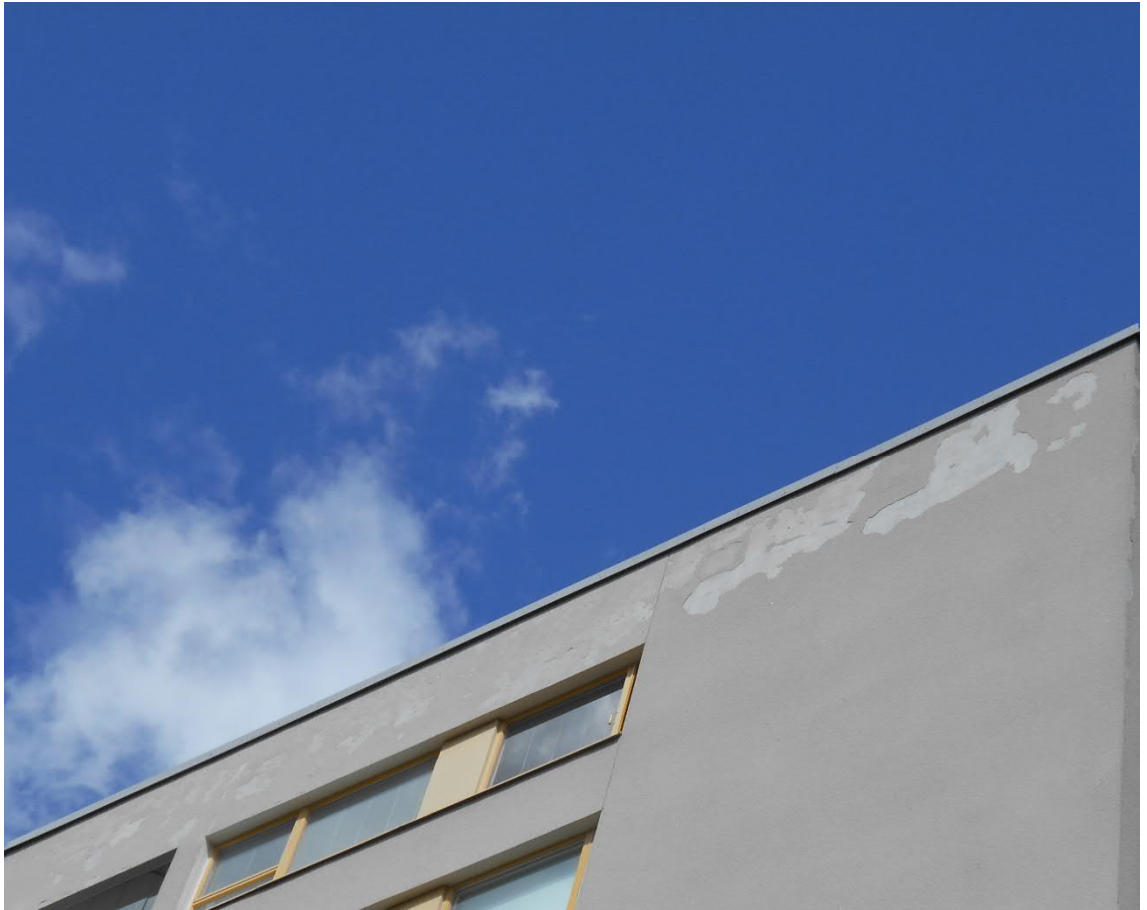
Kuva 44: Pintarappauksen irtoamista julkisivun yläosissa.
