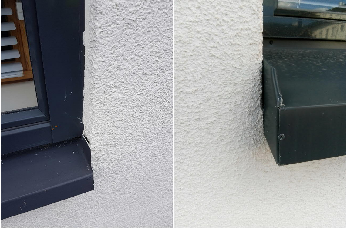
Kuva 12: Jälkiasennettuja väärin toteutettuja ikkunapeltejä. Vasemman puoleisessa kuvassa pellin ja pinnoitteen välissä on useita millimetrejä leveä rako.
