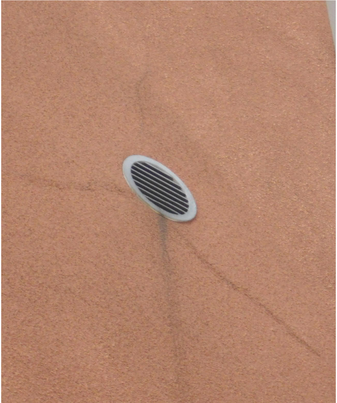
Kuva 30: Rappauksen halkeilua ilmanvaihtoventtiilin kohdalla.
