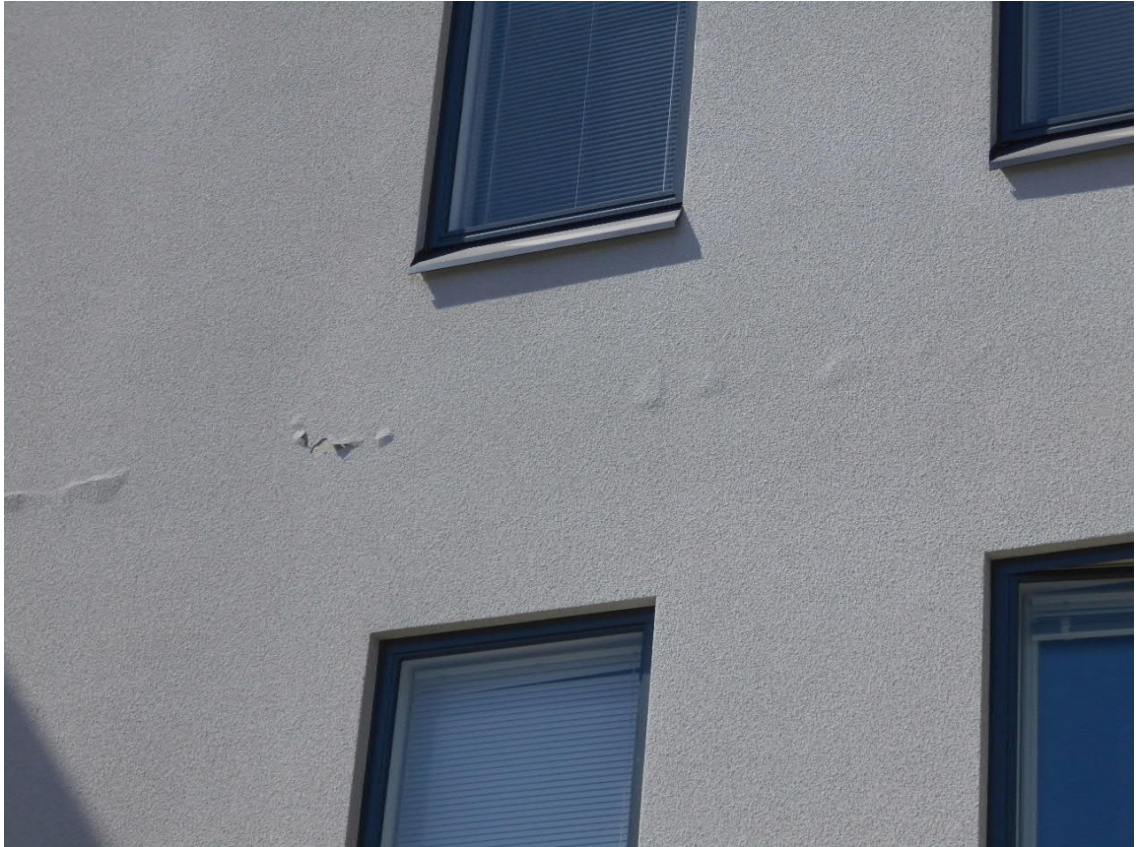
Kuva 24: Rappauksen halkeilua ja laastin pakkasrapautumista palokatkon kohdalla.
