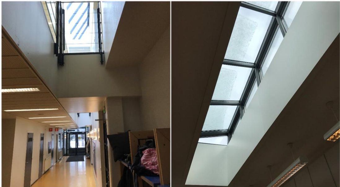
Kuva 22. Kattoikkunoista on monesti vuosin varrella aiheutunut kosteusongelmia sisätiloihin.
