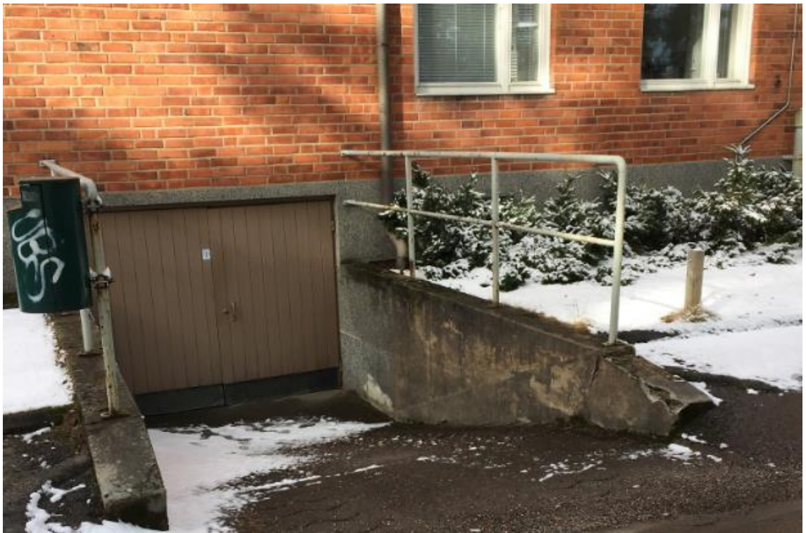
Kuva 29. Tiilitalon kellarissa sijaitsevan autotallin lattialle on kertynyt aika ajoin runsaasti vettä.
